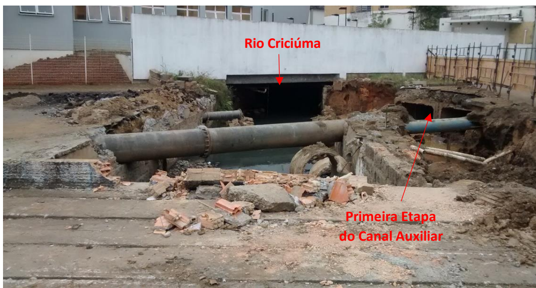
Figura 04: Local de início da etapa 2 do Canal Auxiliar do Rio Criciúma. (Fonte: Dos autores 2016)
