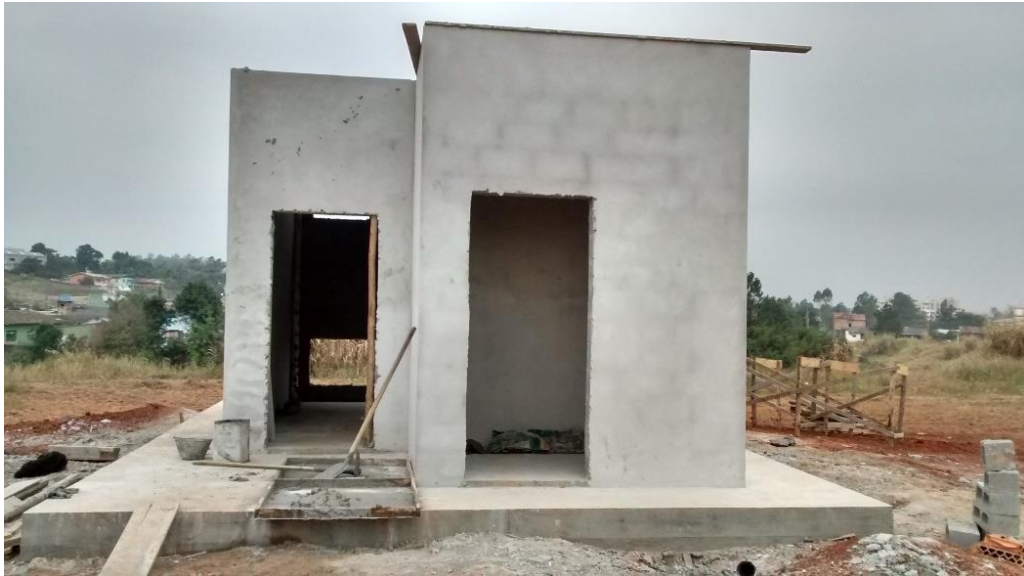
Figura 16: Vista frontal subestação. (Fonte: Dos autores 2016)
