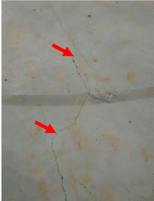
Figura 39: Fissura na quadra poliesportiva. (Fonte: Dos autores 2016)
