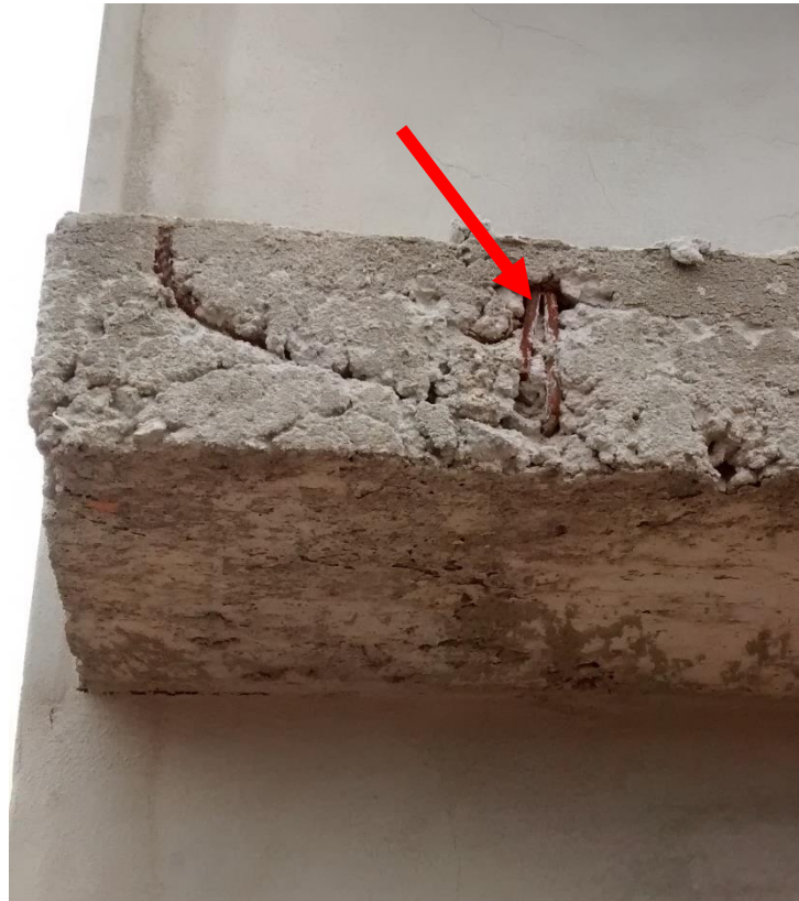
Figura 47: Armadura aparente. (Fonte: Dos autores 2016)
