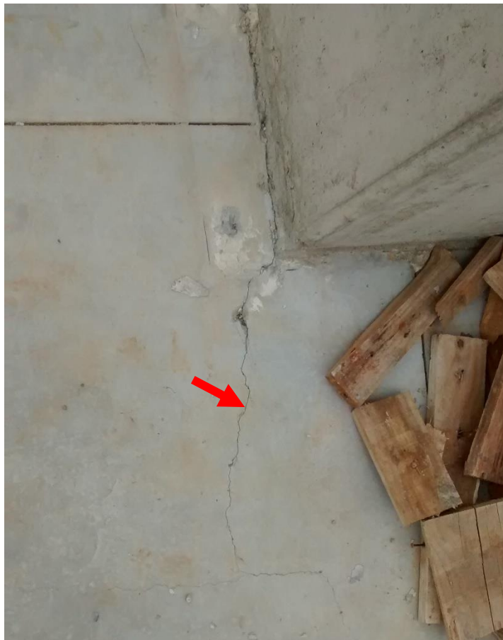
Figura 42: Fissura na quadra poliesportiva. (Fonte: Dos autores 2016)
