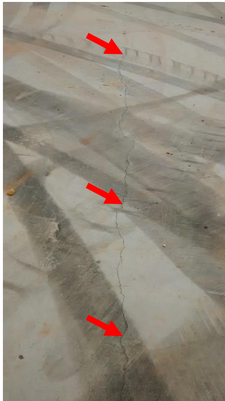
Figura 40: Fissura na quadra poliesportiva. (Fonte: Dos autores 2016)
