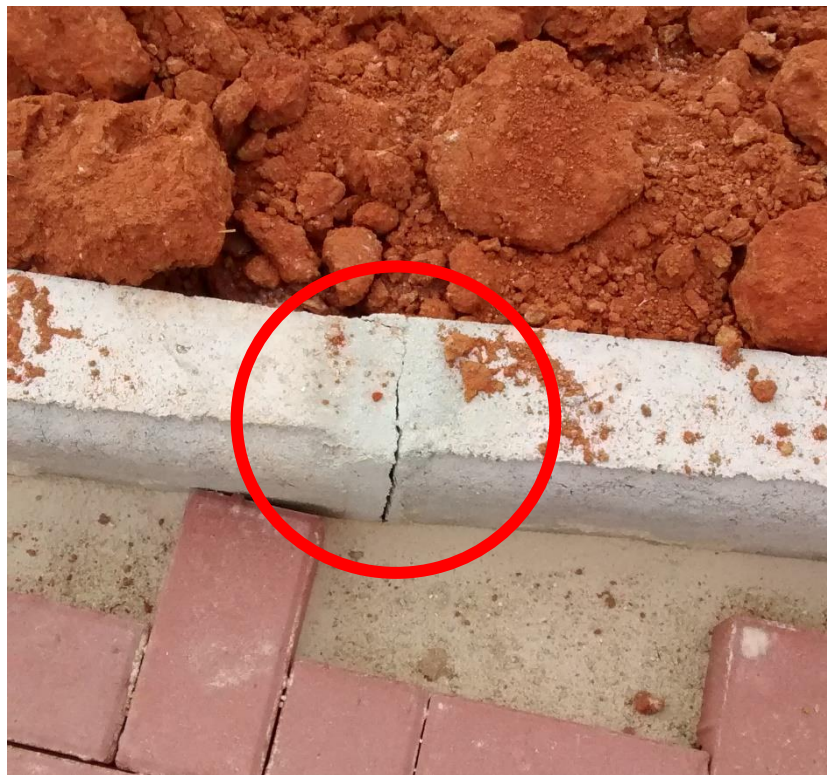
Figura 61: Falta de aderência entre a argamassa e o bloco de meio-fio. (Fonte: Dos autores 2016)
