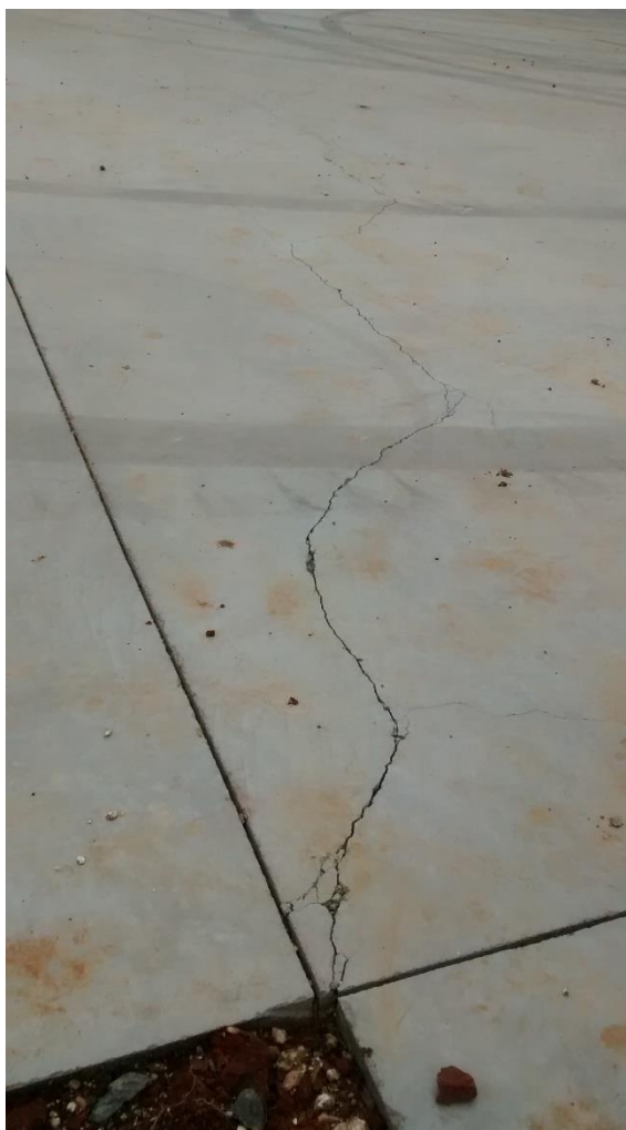
Figura 38: Fissura na quadra poliesportiva. (Fonte: Dos autores 2016)
