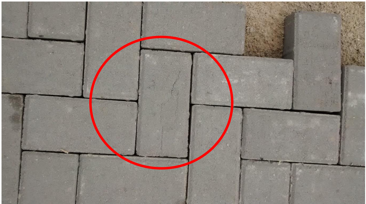
Figura 59: Bloco danificado utilizado. (Fonte: Dos autores 2016)
