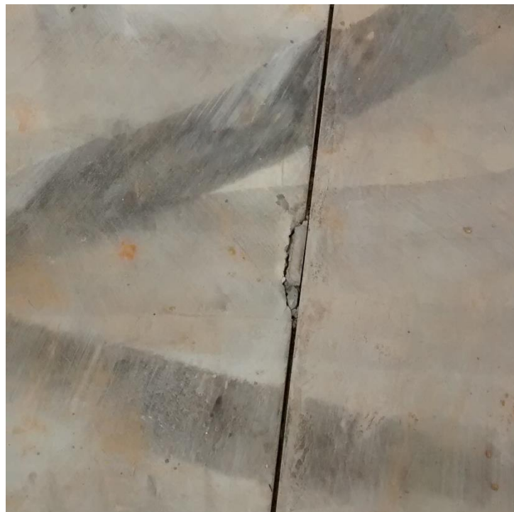
Figura 45: Concreto danificado no local de execução do corte. (Fonte: Dos autores 2016)
