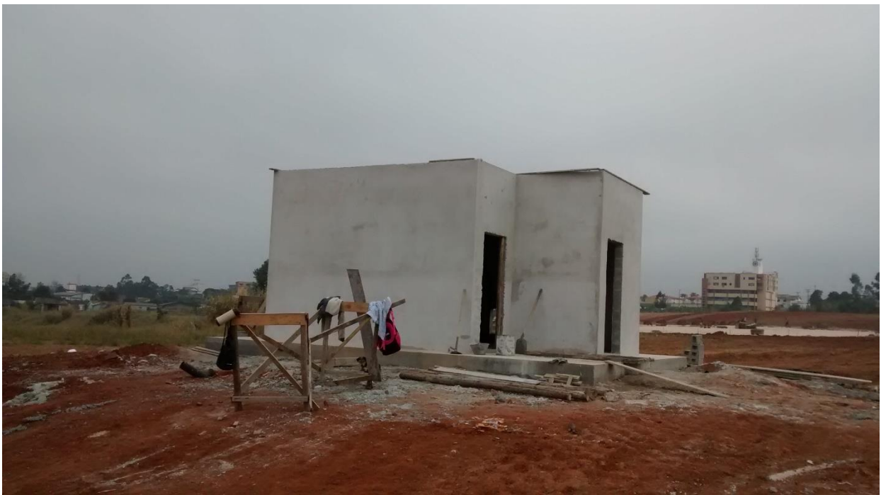
Figura 19: Vista externa da subestação. (Fonte: Dos autores 2016)
