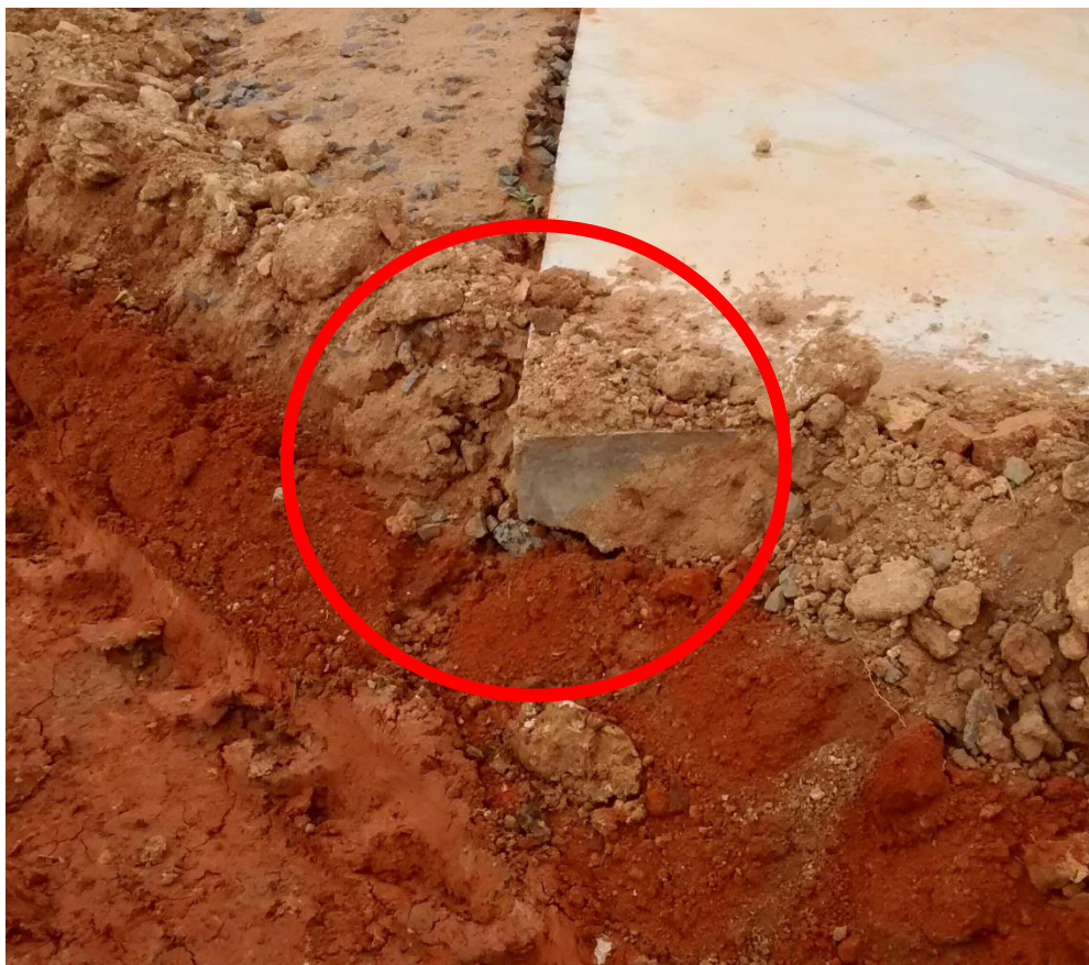
Figura 46: Quadra poliesportiva danificada pela execução de um dos caminhos. (Fonte: Dos autores 2016)
