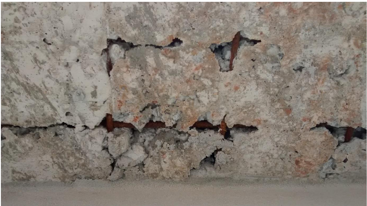
Figura 48: Armadura aparente. (Fonte: Dos autores 2016)
