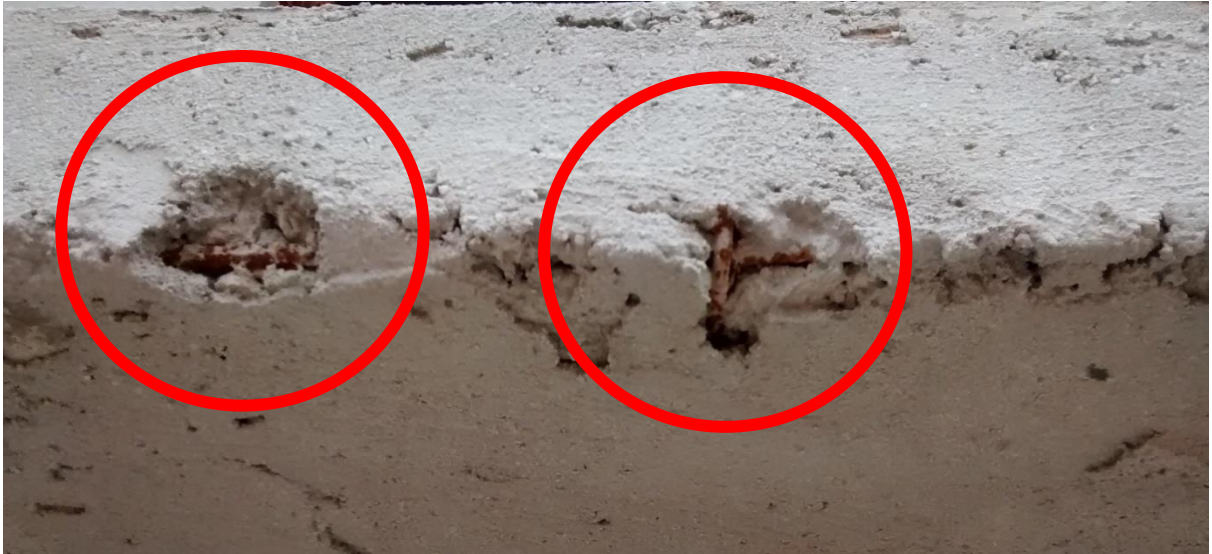
Figura 49: Armadura aparente. (Fonte: Dos autores 2016)
