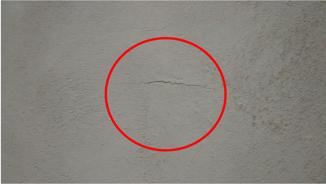
Figura 56: Fissura na alvenaria da subestação. (Fonte: Dos autores 2016)
