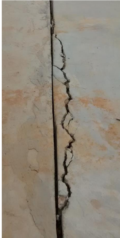
Figura 44: Concreto danificado no local de execução do corte. (Fonte: Dos autores 2016)
