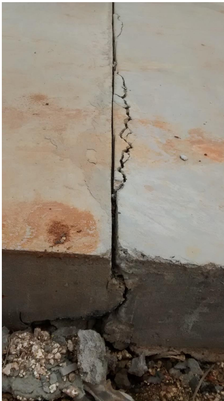
Figura 43: Concreto danificado no local de execução do corte. (Fonte: Dos autores 2016)
