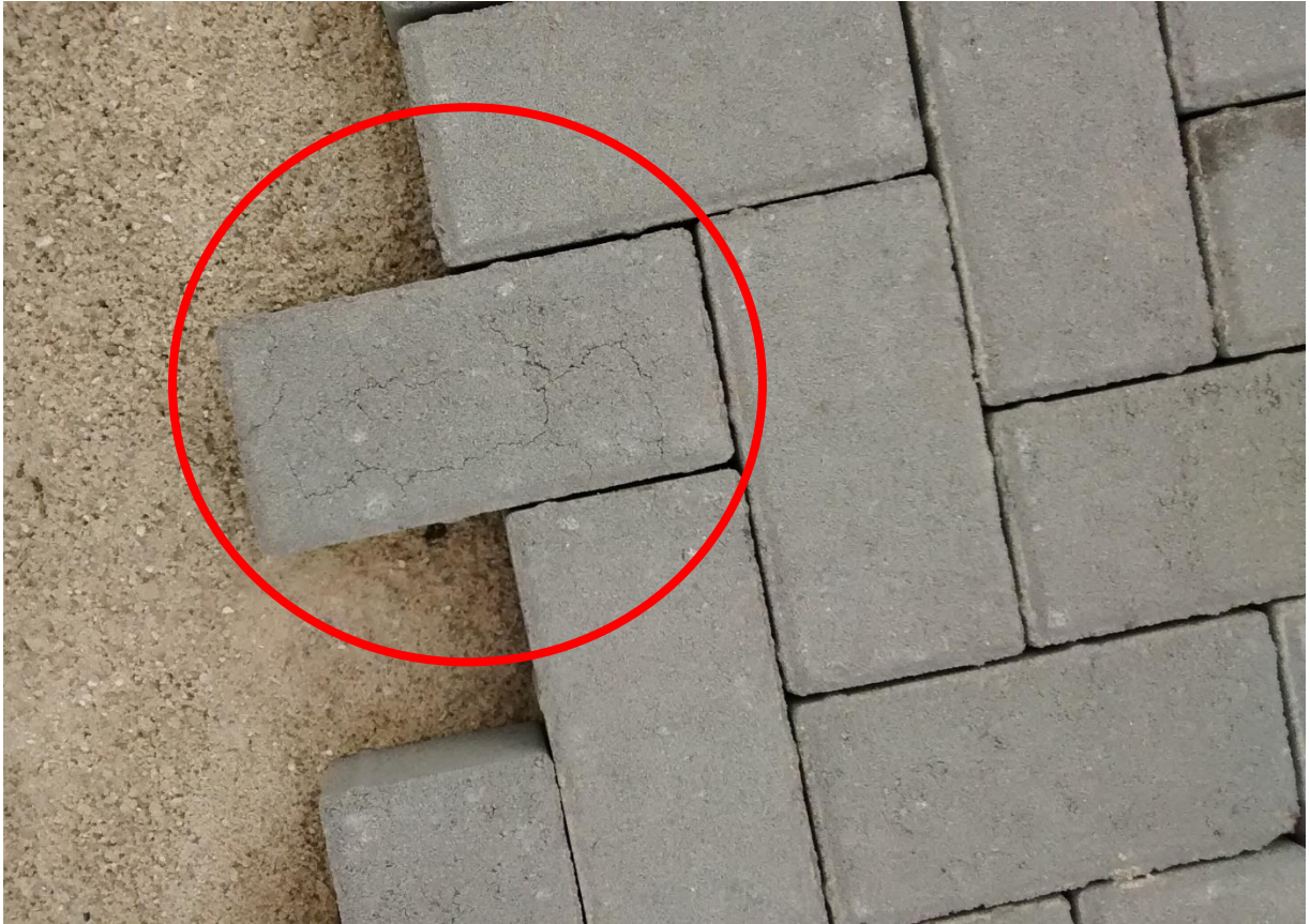
Figura 58: Bloco danificado utilizado. (Fonte: Dos autores 2016)
