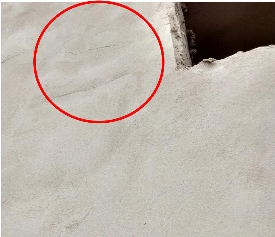
Figura 55: Fissura na alvenaria da subestação. (Fonte: Dos autores 2016)
