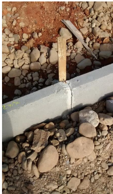
Figura 55: Falta de aderência entre a argamassa e o bloco de meio-fio. (Fonte: Dos autores 2016)
