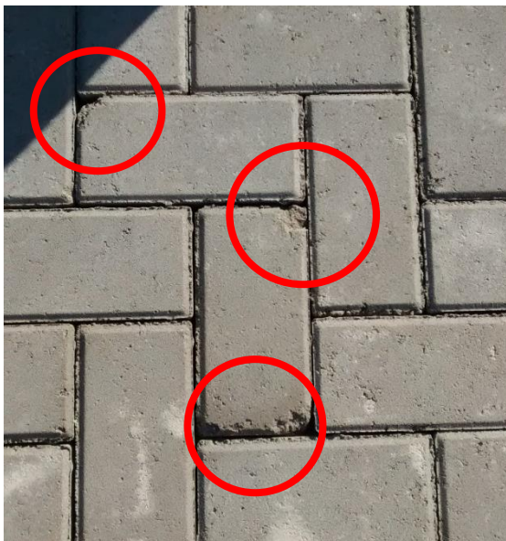
Figura 48: Blocos danificados utilizados. (Fonte: Dos autores 2016)
