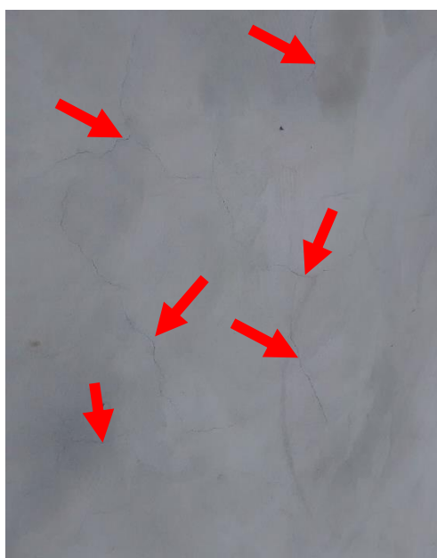
Figura 35: Fissuras na alvenaria dos sanitários e estar. (Fonte: Dos autores 2016)
