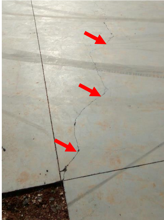
Figura 32: Fissura na quadra poliesportiva. (Fonte: Dos autores 2016)
