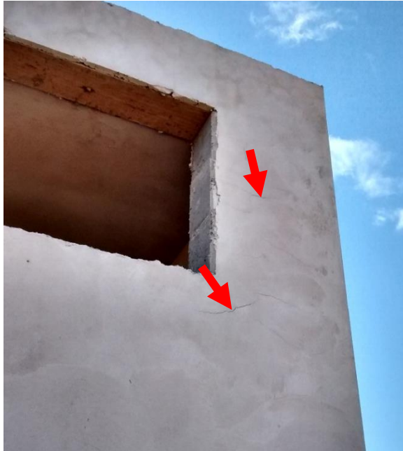
Figura 44: Fissuras na alvenaria da subestação. (Fonte: Dos autores 2016)
