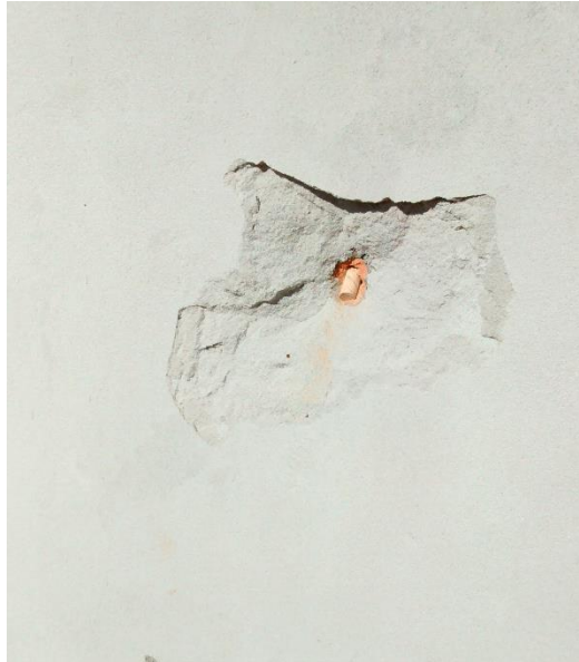
Figura 38: Quebra do revestimento da alvenaria na área externa. (Fonte: Dos autores 2016)
