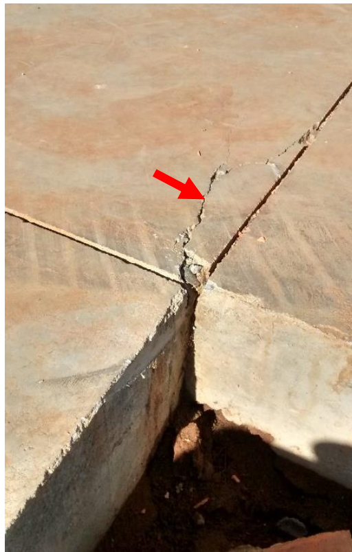
Figura 33: Fissura na quadra poliesportiva. (Fonte: Dos autores 2016)
