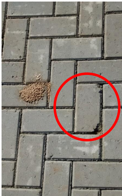
Figura 47: Bloco danificado utilizado. (Fonte: Dos autores 2016)
