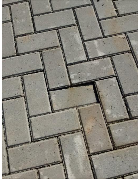
Figura 50: Bloco com problema no nivelamento. (Fonte: Dos autores 2016)
