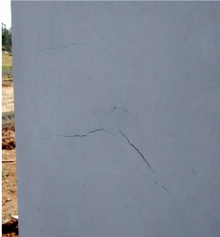
Figura 36: Fissuras na alvenaria dos sanitários e estar. (Fonte: Dos autores 2016)
