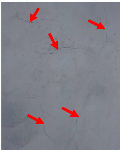
Figura 34: Fissuras na alvenaria dos sanitários e estar. (Fonte: Dos autores 2016)
