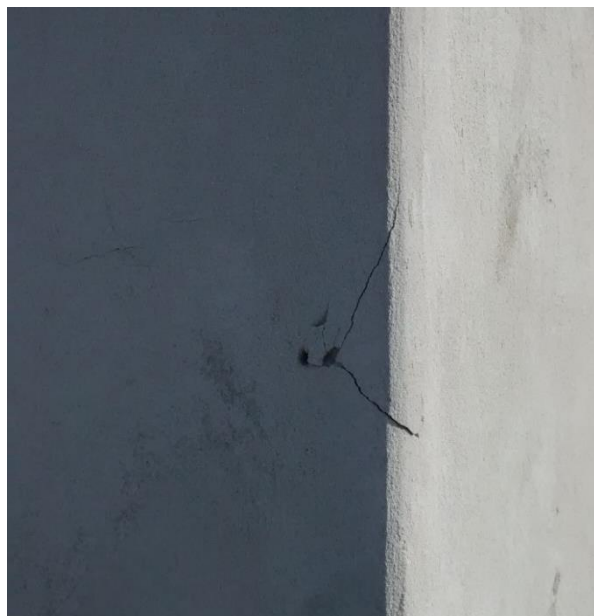
Figura 45: Fissuras na alvenaria da subestação. (Fonte: Dos autores 2016)
