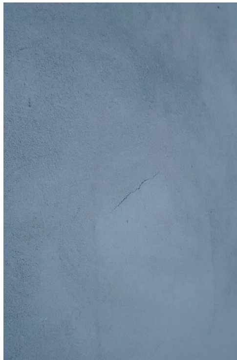
Figura 37: Fissuras na alvenaria dos sanitários e estar. (Fonte: Dos autores 2016)
