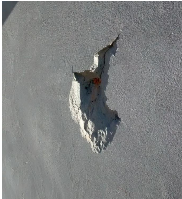
Figura 39: Quebra do revestimento da alvenaria na área externa. (Fonte: Dos autores 2016)
