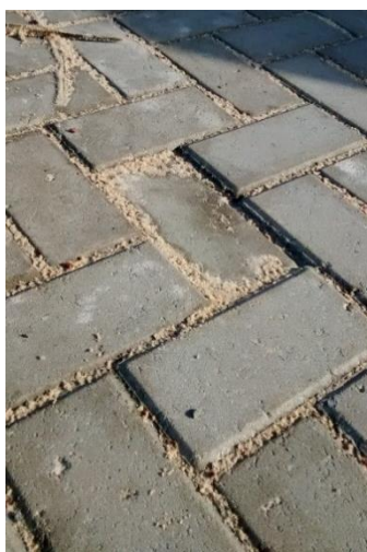
Figura 49: Bloco com problema no nivelamento. (Fonte: Dos autores 2016)
