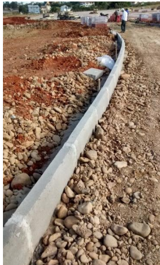
Figura 54: Falta de aderência entre a argamassa e o bloco de meio-fio. (Fonte: Dos autores 2016)
