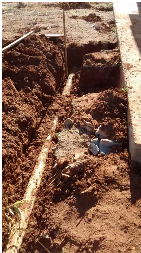
Figura 14: Tubulação de esgoto dos sanitários e estar. (Fonte: Dos autores 2016)
