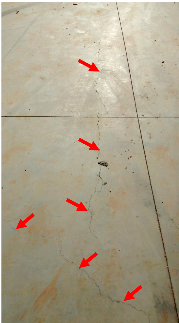
Figura 31: Fissura na quadra poliesportiva. (Fonte: Dos autores 2016)
