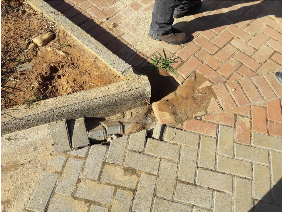
Figura 09: Pavers começando a ser afetados pelo acúmulo de água. (Fonte: Dos autores 2017)
