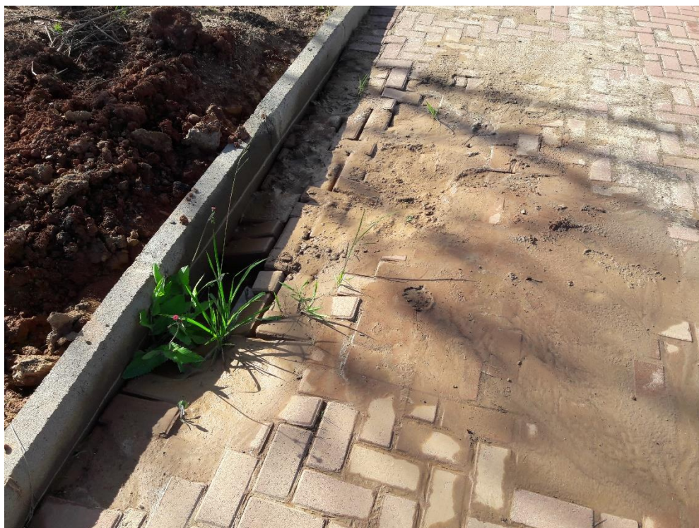
Figura 08: Pavimentação toda afetada pelo acúmulo de água. (Fonte: Dos autores 2017)
