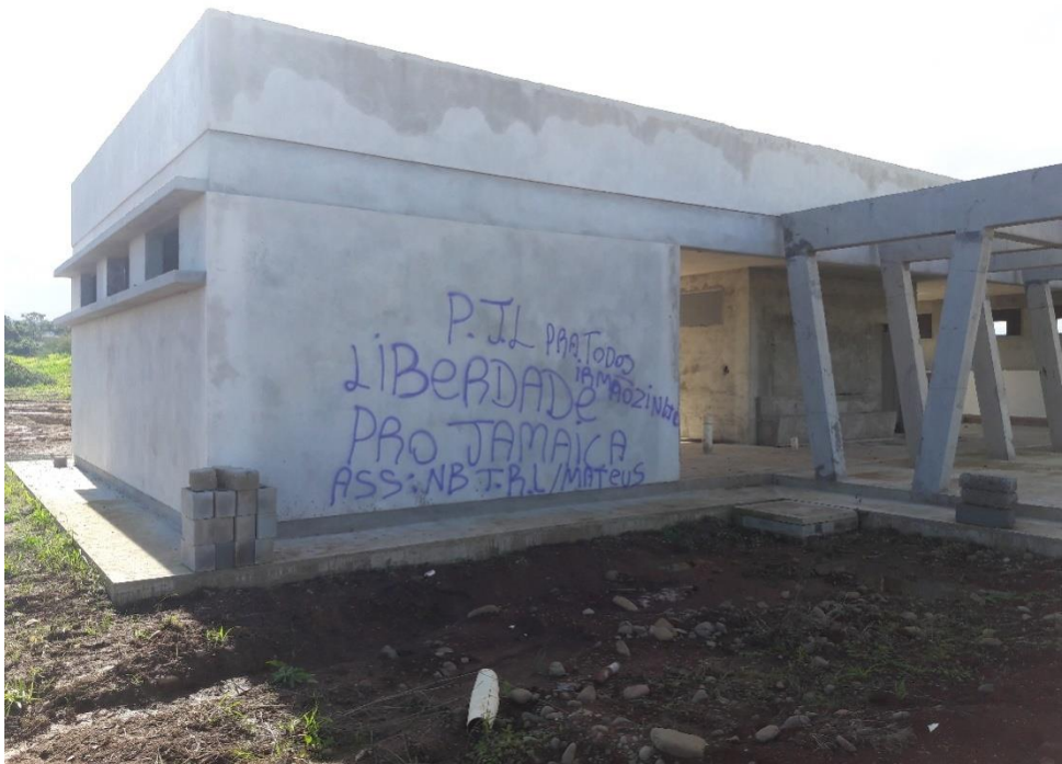
Figura 14: Pichação na parede externa dos sanitários. (Fonte: Dos autores 2017)
