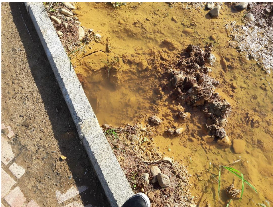
Figura 10: Água causando erosão na pavimentação. (Fonte: Dos autores 2017)
