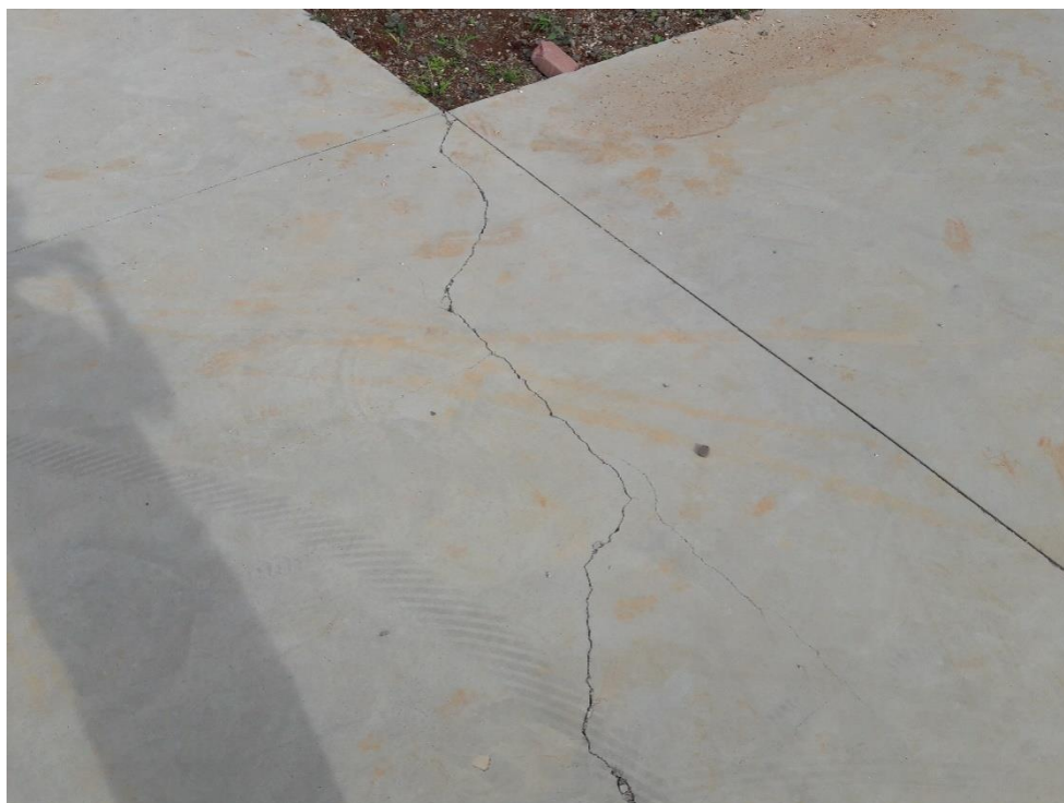
Figura 11: Fissura proveniente da junta de dilatação. (Fonte: Dos autores 2017)
