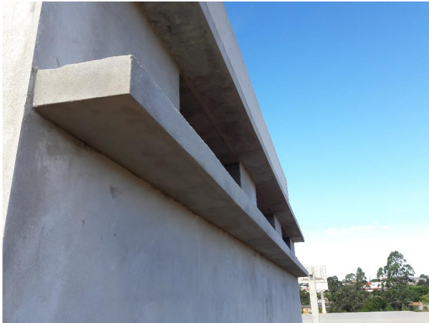
Figura 21: Verga e contraverga sanitário feminino. (Fonte: Dos autores 2017)
