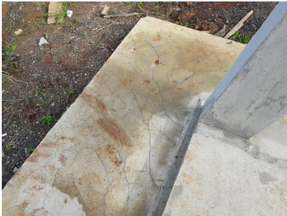
Figura 13: Fissuras no calçamento lateral ao pergolado. (Fonte: Dos autores 2017)
