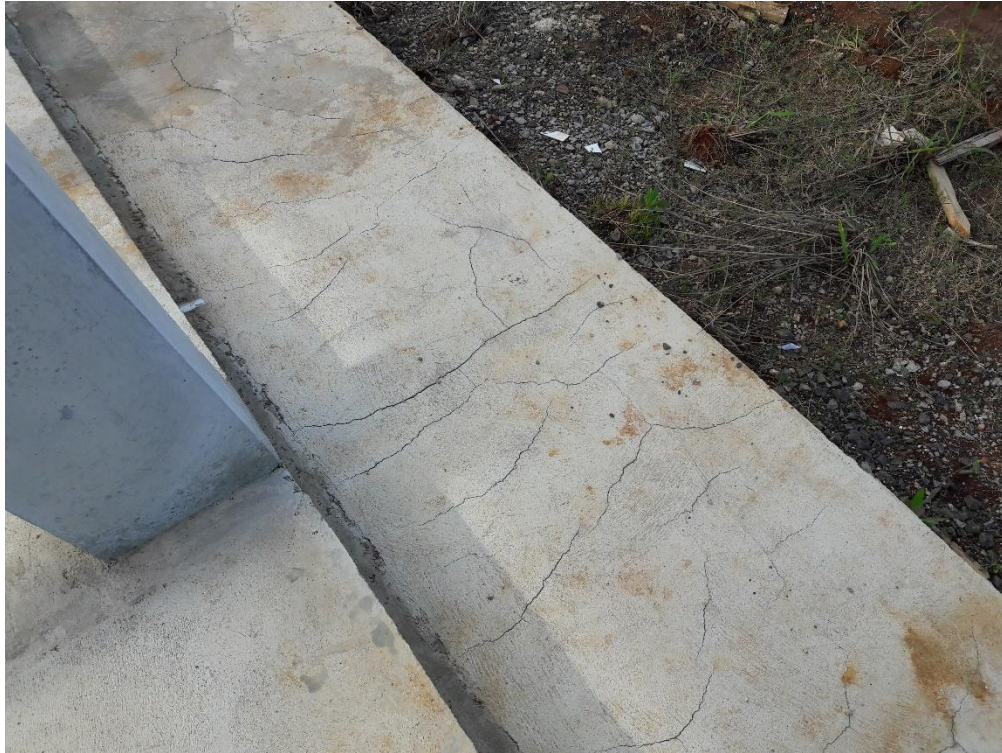
Figura 12: Fissuras no calçamento lateral ao pergolado. (Fonte: Dos autores 2017)
