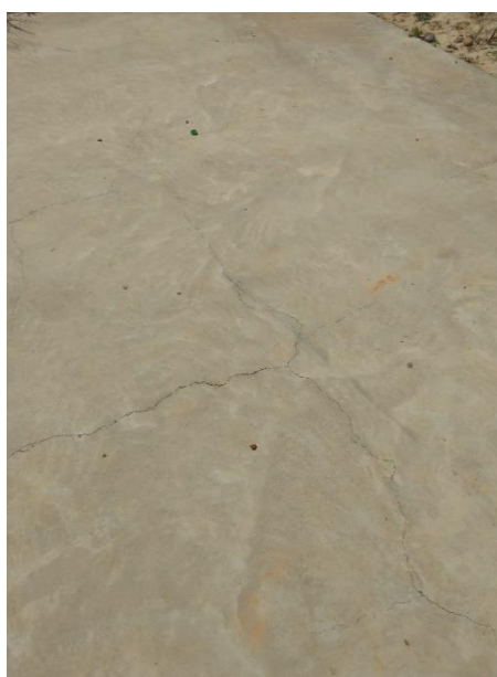
Figura 16: Fissuras na quadra poliesportiva. (Fonte: Dos Autores 2018)
