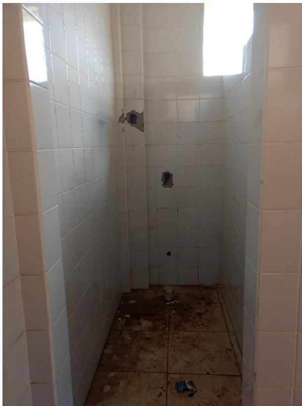
Figura 6: Registros furtados do banheiro. (Fonte: Dos Autores 2018)
