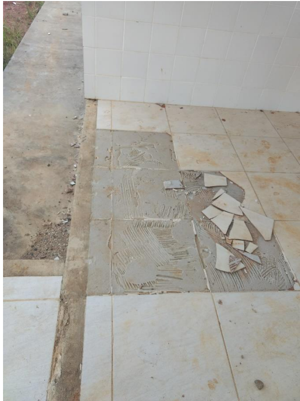
Figura 5: Pisos da área de lazer e banheiro quebrados. (Fonte: Dos Autores 2018)
