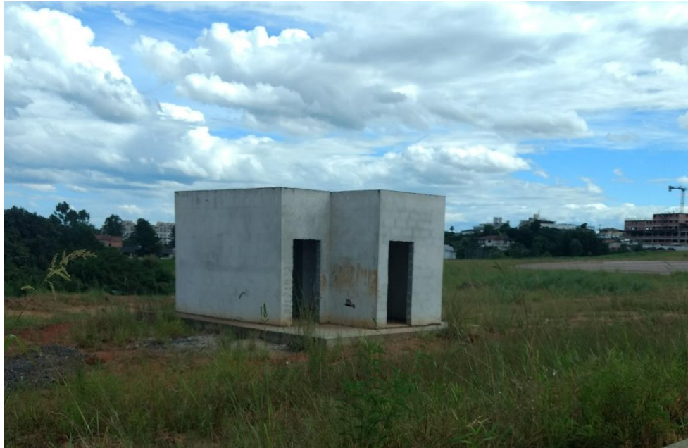
Figura 10: Trafo em fase de conclusão. (Fonte: Dos Autores 2018)
