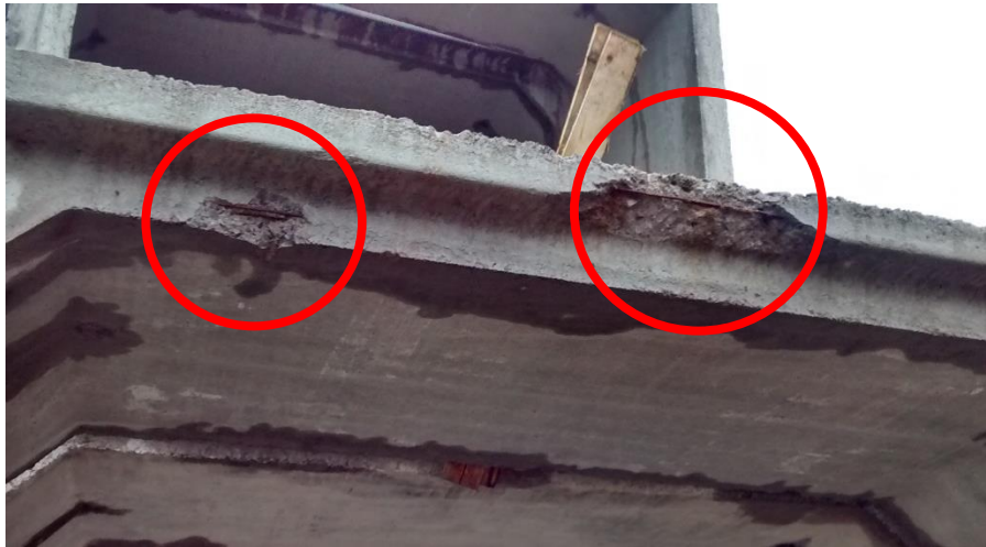
Figura 17: Detalhe de alguns pontos com a armadura aparente. (Fonte: Dos autores 2016)
