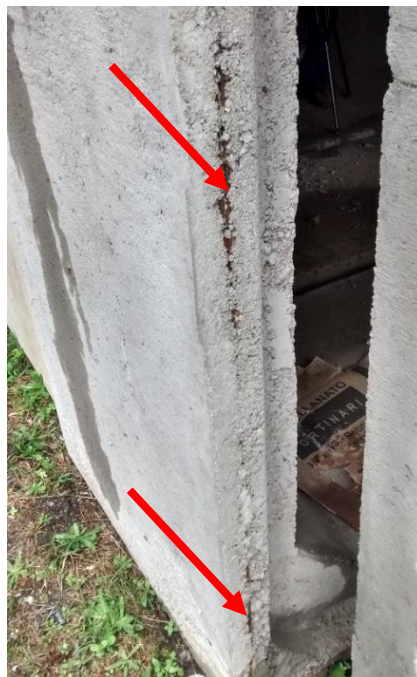
Figura 18: Detalhe de alguns pontos com falta de cobrimento da armadura. (Fonte: Dos autores 2016)
