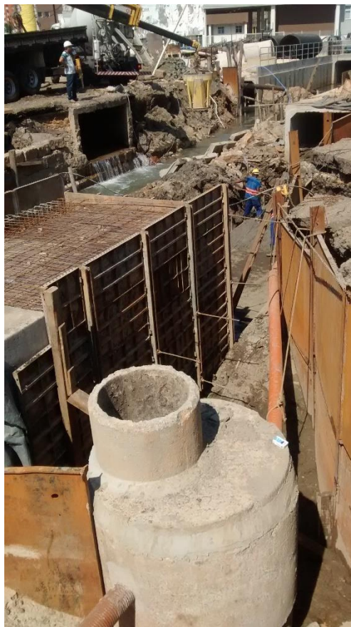
Figura 15: Trabalhos em execução na etapa 2 do Canal Auxiliar do Rio Criciúma. (Fonte: Dos autores 2016)
