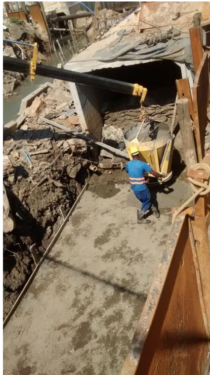
Figura 08: Execução da camada de concreto com espessura de 10 cm. (Fonte: Dos autores 2016)
