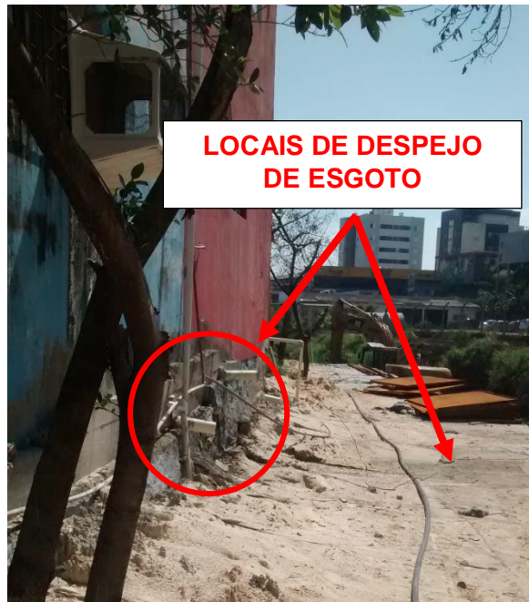
Figura 18: Detalhe do despejo de esgoto sobre o canal já executado. (Fonte: Dos autores 2016)
