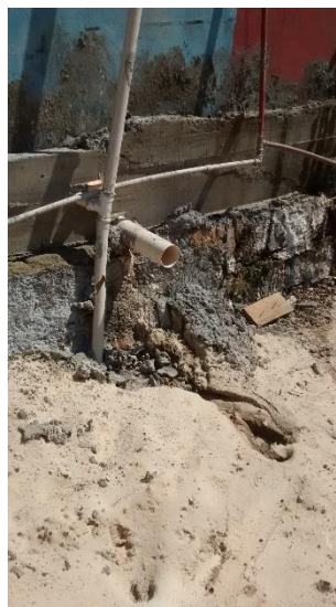
Figura 19: Detalhe da tubulação de esgoto de uma das edificações. (Fonte: Dos autores 2016)
