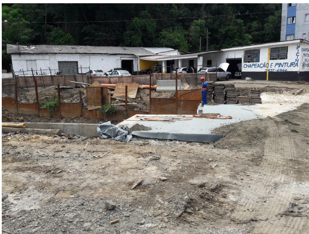
Figura 04: Obras do Canal Auxiliar do Rio Criciúma na Rua Araranguá. (Fonte: Dos autores 2017)
