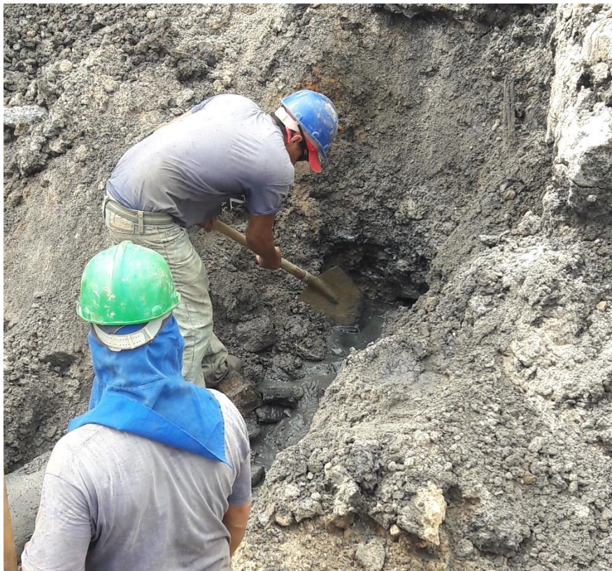
Figura 09: Local onde estourou a tubulação. (Fonte: Dos autores 2017)
