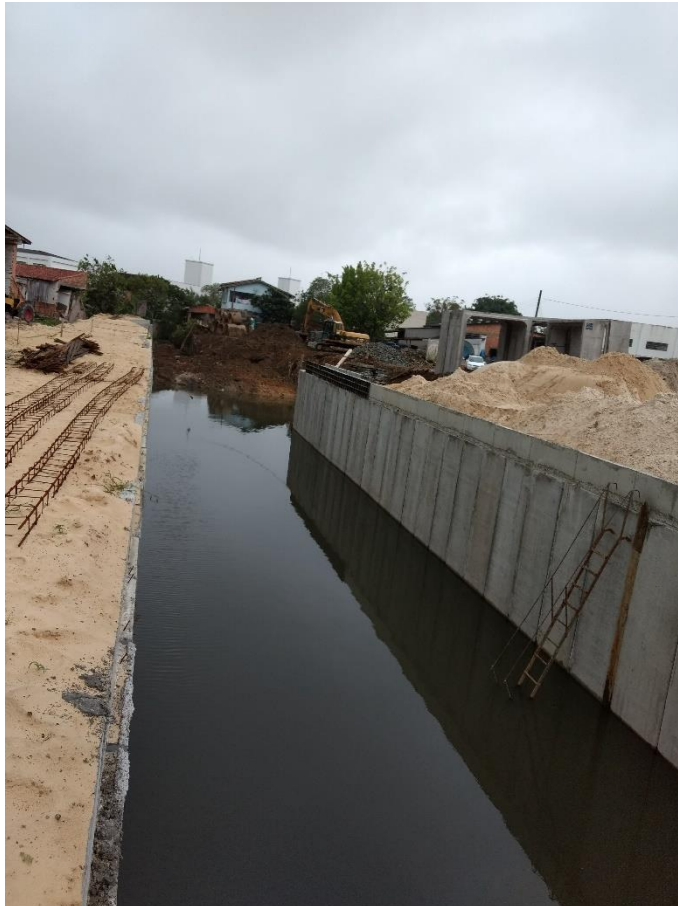
Figura 7: Aduelas instaladas entre a Rua Wenceslau Brás e Álvaro Catão. (Fonte: Dos Autores 2018)
