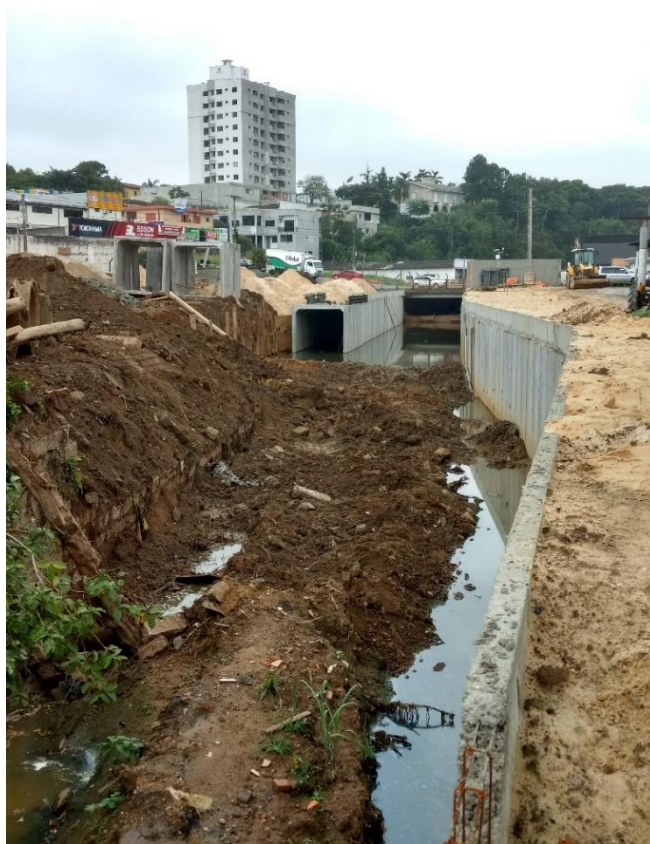
Figura 9: Aduelas instaladas entre a Rua Wenceslau Brás e Álvaro Catão. (Fonte: Dos Autores 2018)
