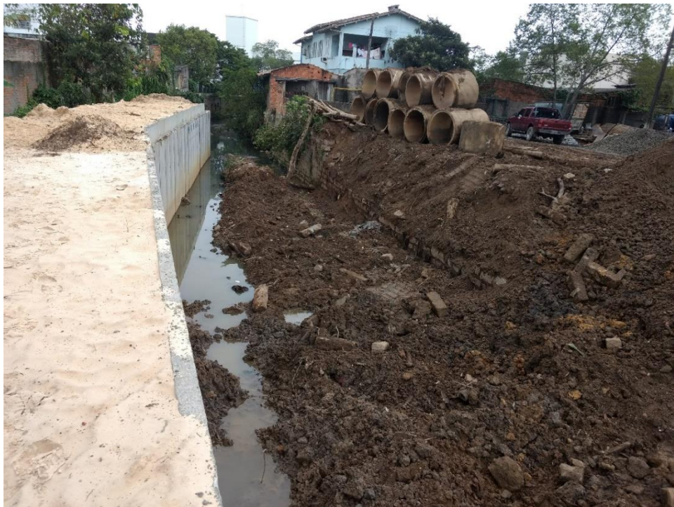
Figura 8: Aduelas instaladas entre a Rua Wenceslau Brás e Álvaro Catão. (Fonte: Dos Autores 2018)
