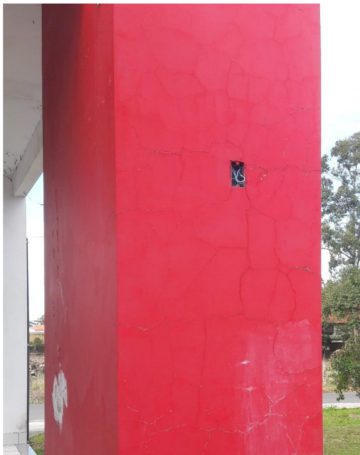
Figura 7: Fissuras ao longo de toda estrutura
