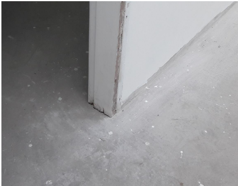
Figura 20: Marco danificado pela água (Fonte: Autores)
