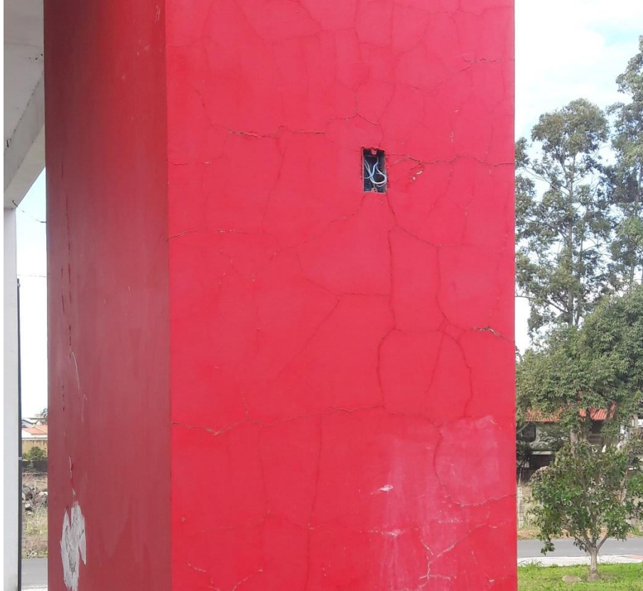
Figura 9: Detalhe das fissuras na 1ª visita (Fonte: Autores)
