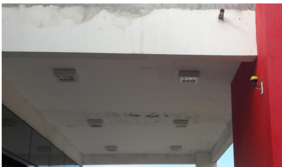
Figura 11: Umidade no teto da entrada da unidade durante a 1ª visita (Fonte: Autores)
