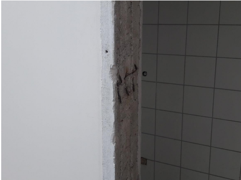
Figura 19: Marco removido, verificado na 1ª visita (Fonte: Autores)
