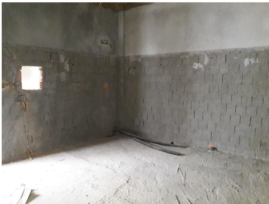
Figura 24: Sala de raio-x internamente (Fonte: Autores)
