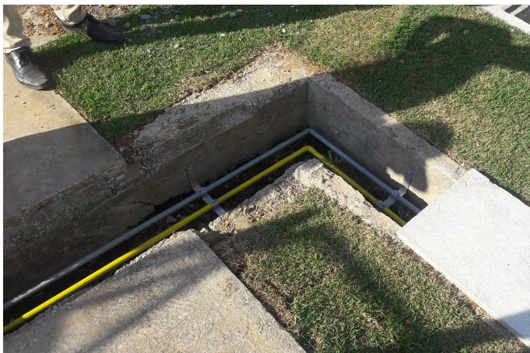
Figura 39: Passagem das tubulações de gases (Fonte: Autores)
