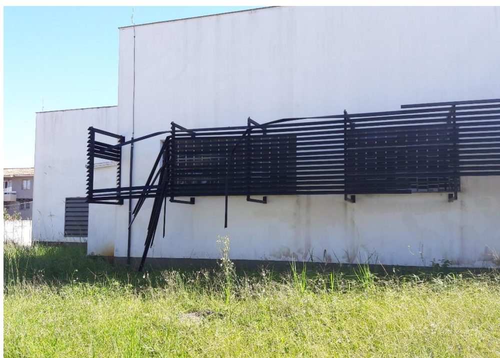
Figura 35: Brise danificado na visita inicial (Fonte: Autores)
