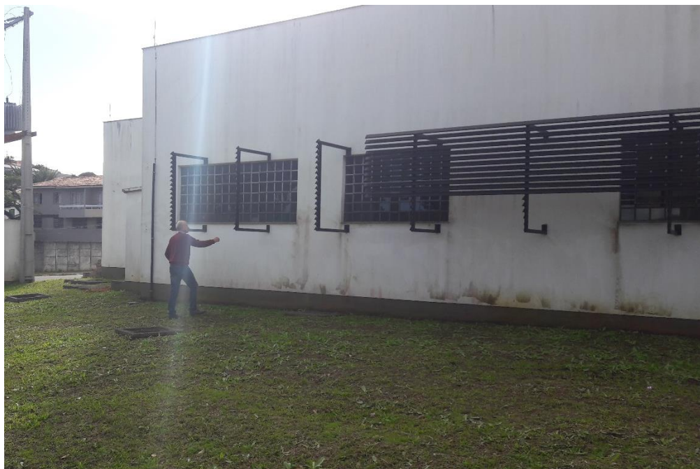
Figura 36: Brises danificados já removidos na 1ª visita (Fonte: Autores)
