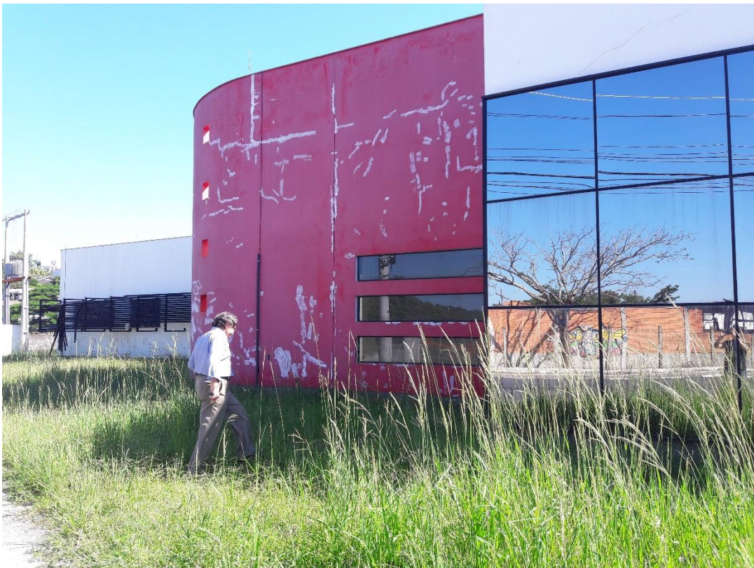
Figura 40: Gramado alto e patologias na estrutura (Fonte: Autores)
