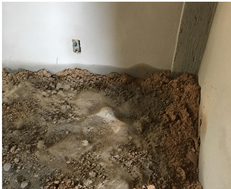
Figura 16: Umidade absorvida pela parede. (Fonte: Dos Autores 2018)
