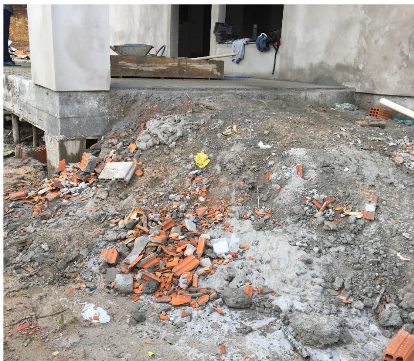
Figura 8: Acúmulo de entulho gerado pela construção. (Fonte: Dos Autores 2018)
