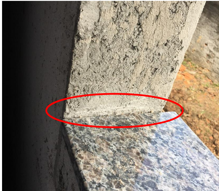
Figura 17: Chapa de granito. (Fonte: Dos Autores 2018)
