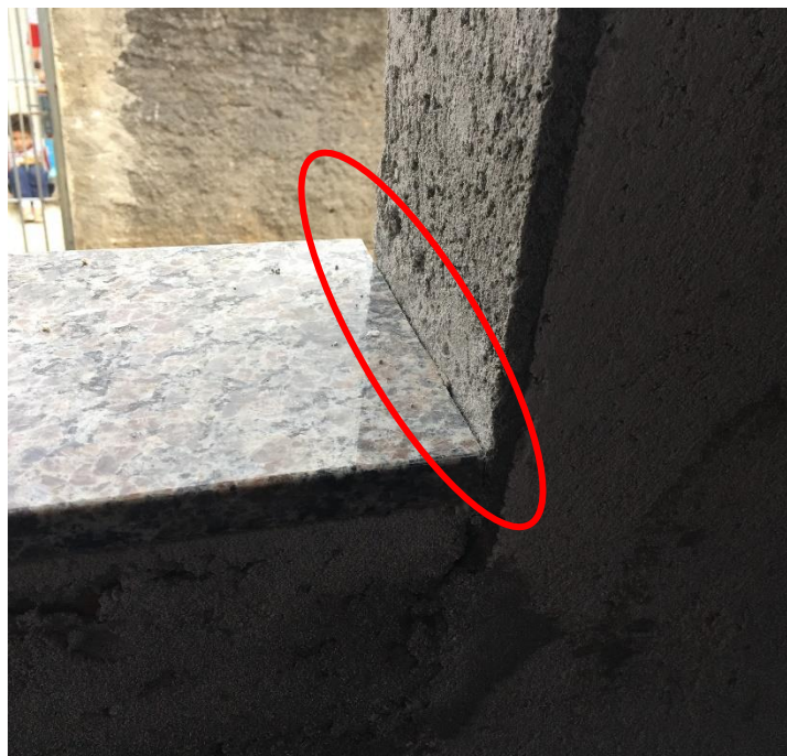
Figura 18: Chapa de granito. (Fonte: Dos Autores 2018)
