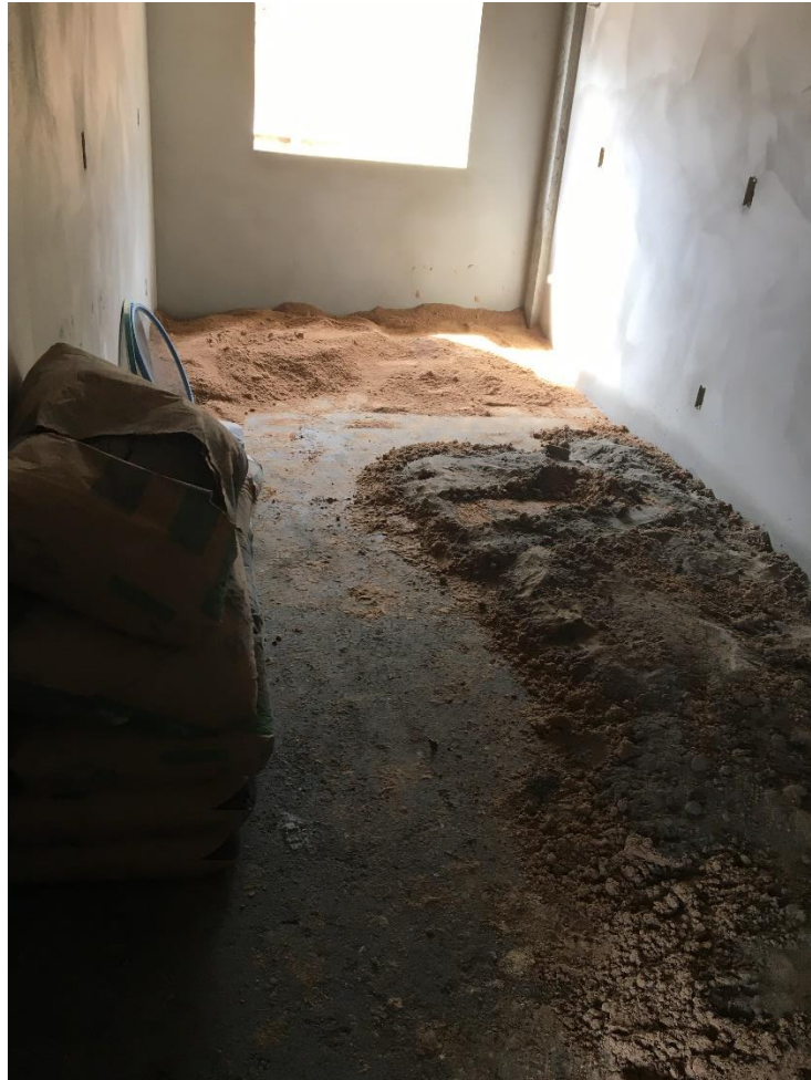
Figura 15: Armazenamento incorreto de materiais. (Fonte: Dos Autores 2018)
