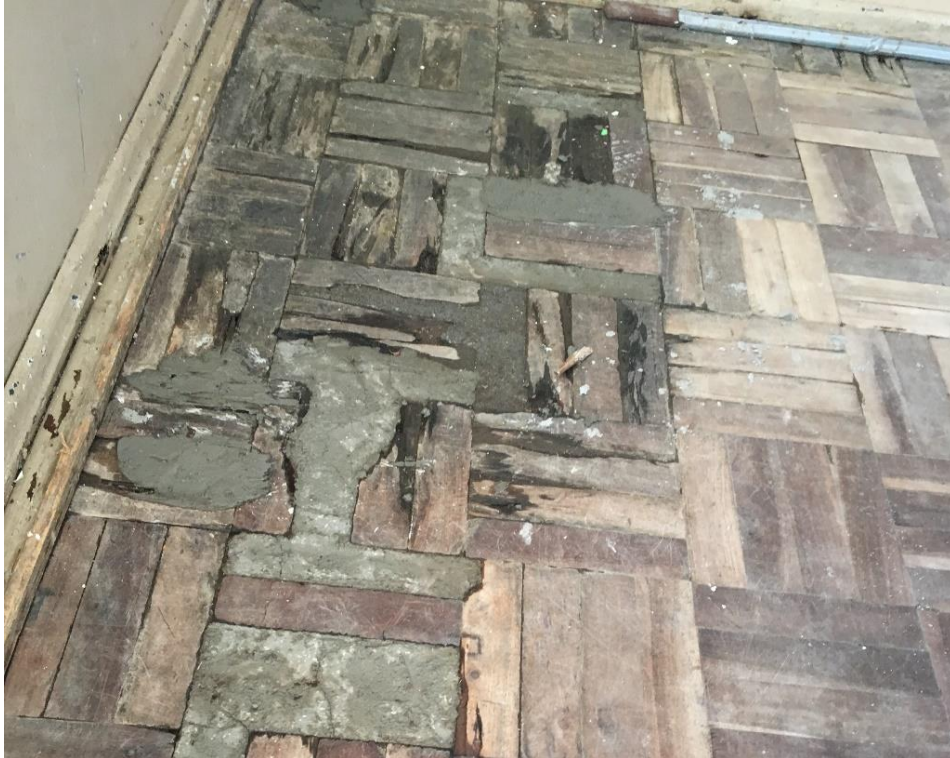
Figura 16: Assoalho em péssimo estado. (Fonte: Dos Autores 2018)
