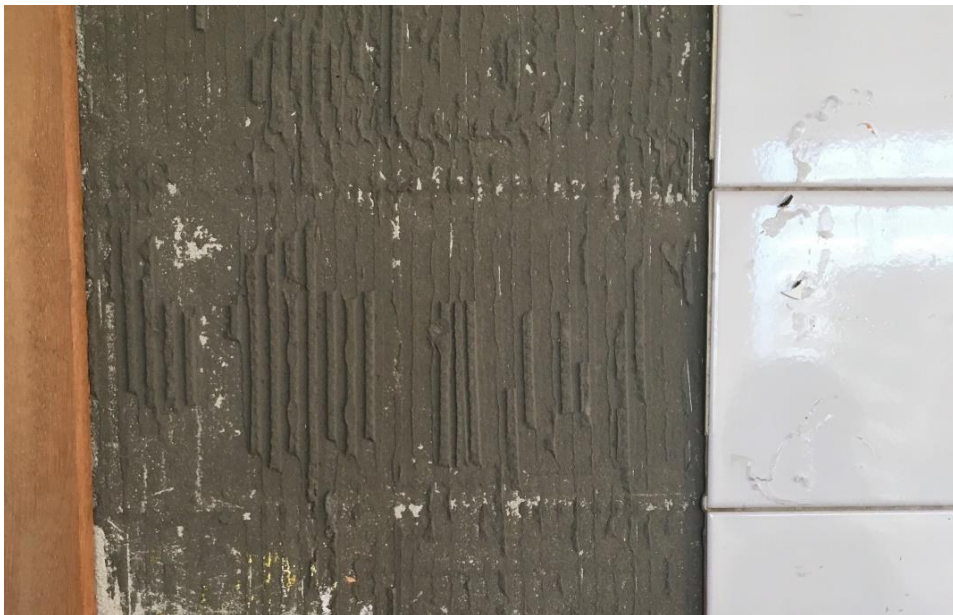
Figura 17: Azulejos descolados. (Fonte: Dos Autores 2018)
