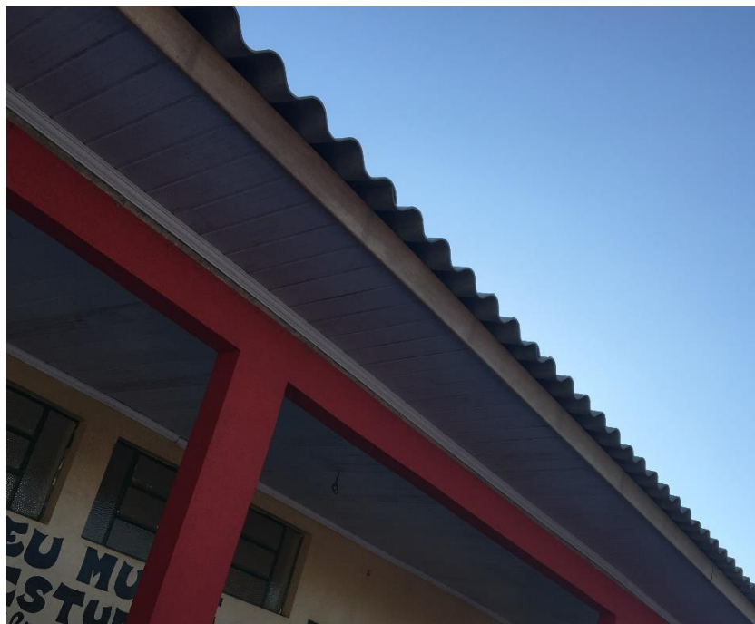
Figura 12: Forro do beiral. (Fonte: Dos Autores 2018)
