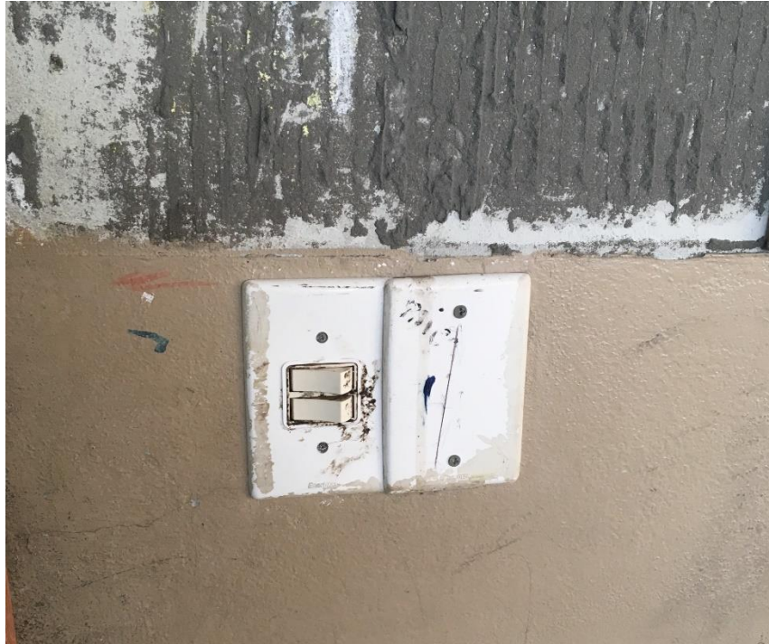
Figura 9: Interruptor em péssimas condições. (Fonte: Dos Autores 2018)
