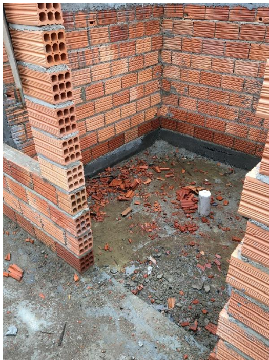
Figura 9: Tubulação hidráulica. (Fonte: Dos Autores 2018)
