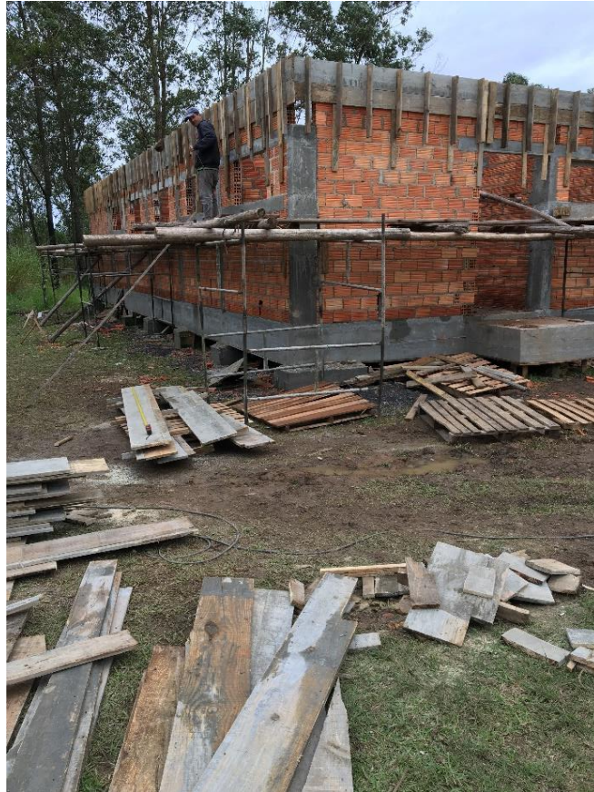
Figura 10: Funcionários não utilizando de EPI. (Fonte: Dos Autores 2018)
