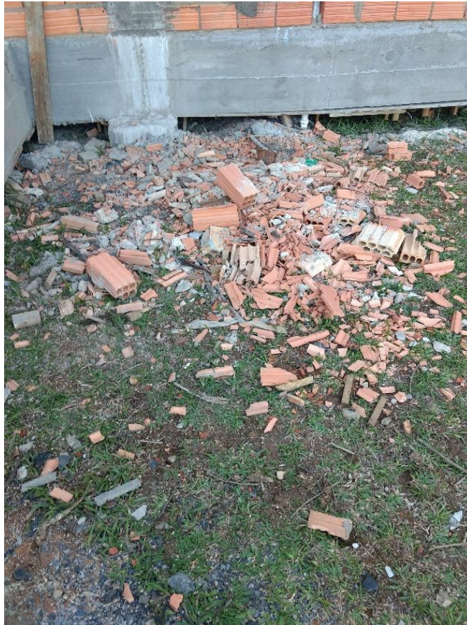
Figura 9: Descarte de resíduos em local impróprio. (Fonte: Dos Autores 2018)
