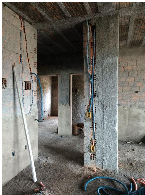
Figura 12: Eletrodutos instalados. (Fonte: Dos Autores 2018)
