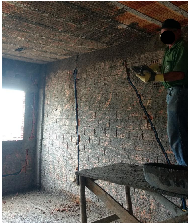
Figura 15: Trabalhador sem EPI. (Fonte: Dos Autores 2018)
