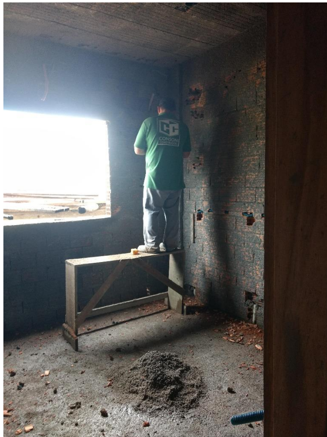
Figura 16: Trabalhador sem EPI. (Fonte: Dos Autores 2018)
