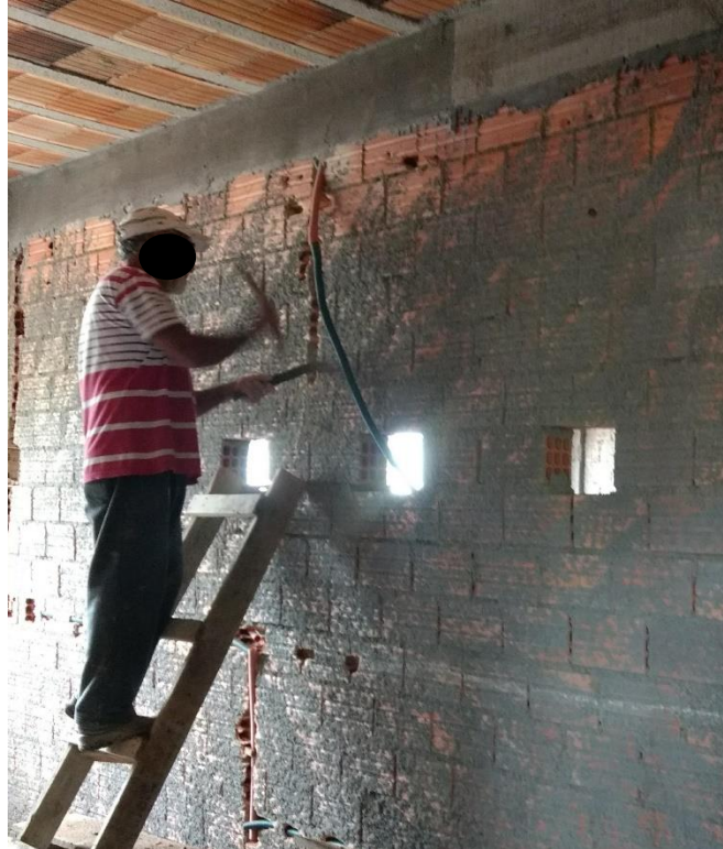
Figura 14: Trabalhador sem EPI. (Fonte: Dos Autores 2018)
