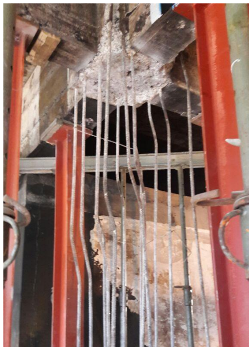
Figura 16: Ferragens existentes do pilar P2. (Fonte: Dos autores 2016)
