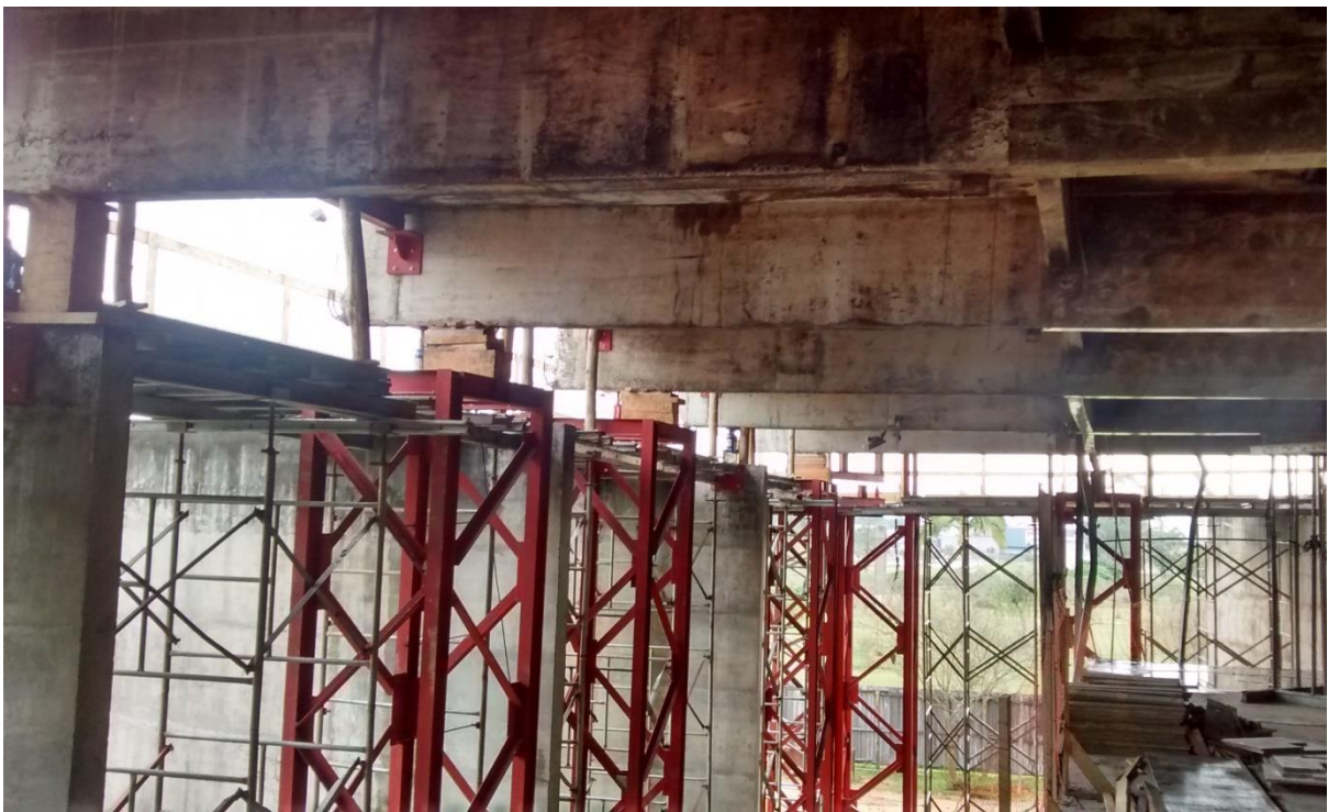
Figura 22: Detalhe do pavimento superior após demolição das vigas de bordo. (Fonte: Dos autores 2016)
