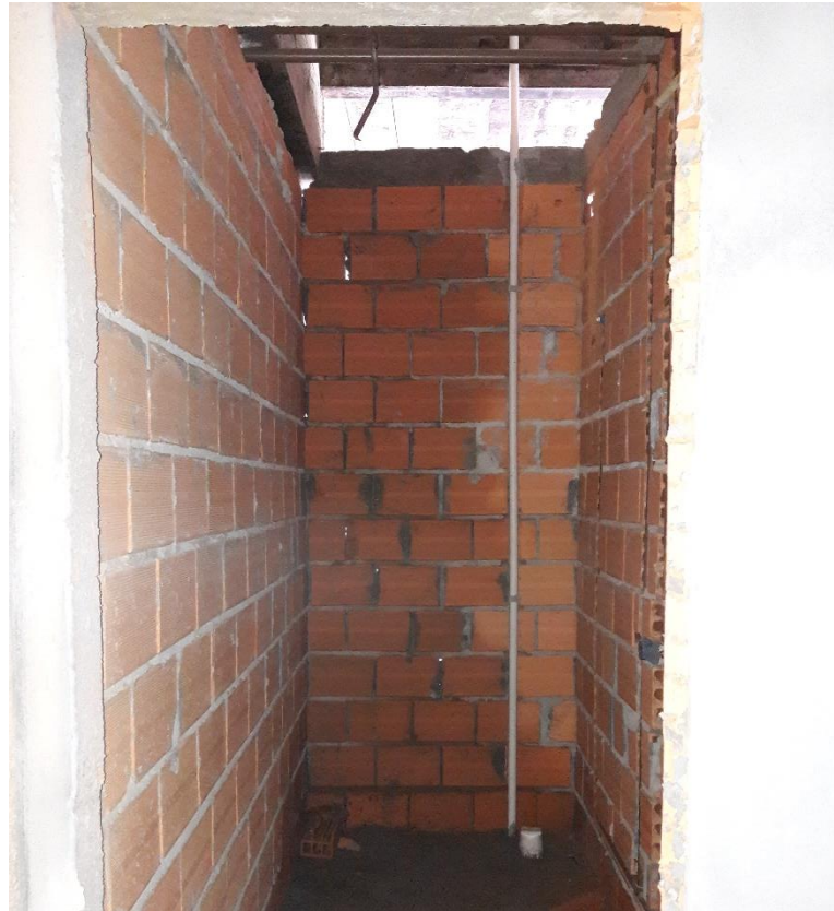
Figura 23: Tubulações hidrossanitárias. (Fonte: Dos autores 2017)
