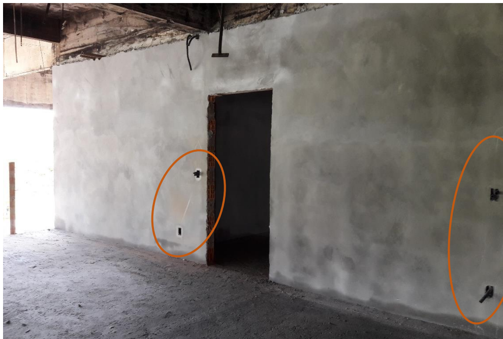
Figura 24: Caixas de passagens elétricas. (Fonte: Dos autores 2017)
