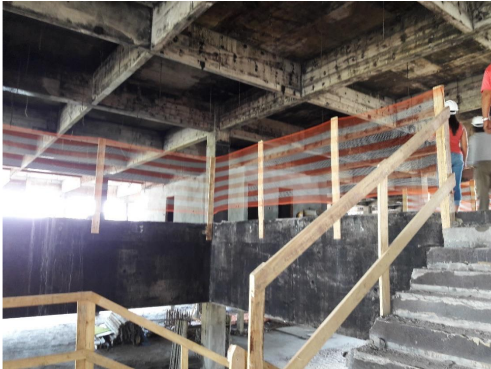
Figura 26: Guarda corpo e tela de proteção. (Fonte: Dos autores 2017)
