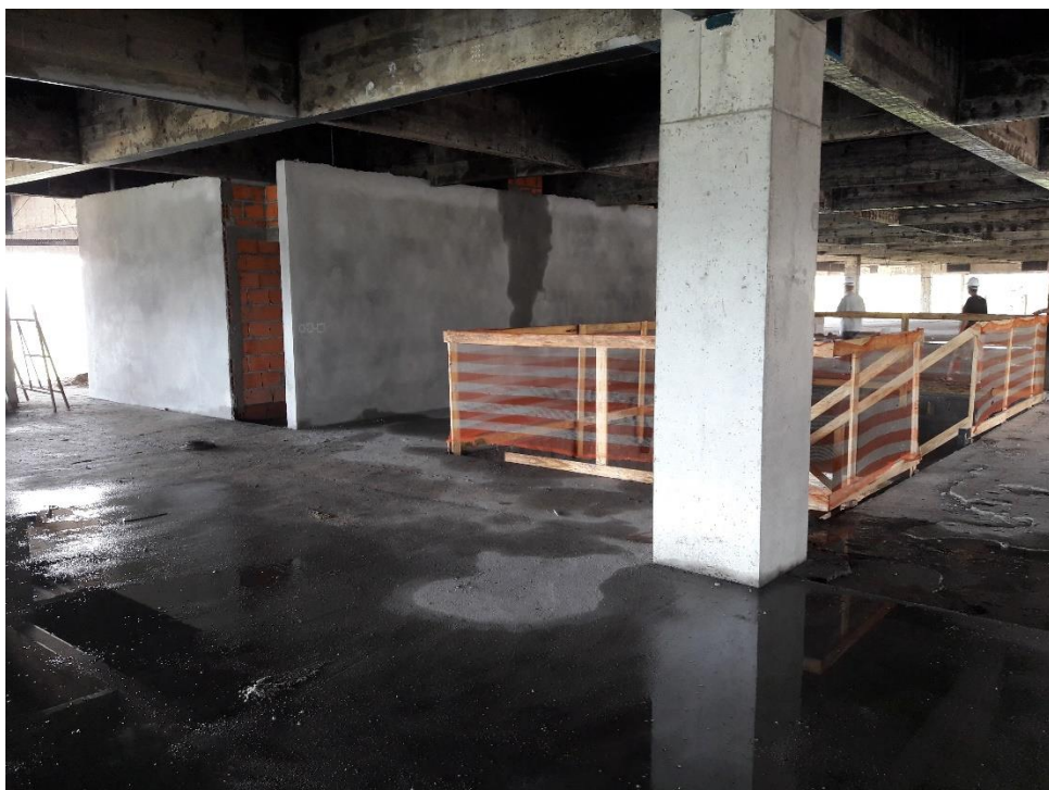
Figura 27: Guarda corpo e tela de proteção. (Fonte: Dos autores 2017)
