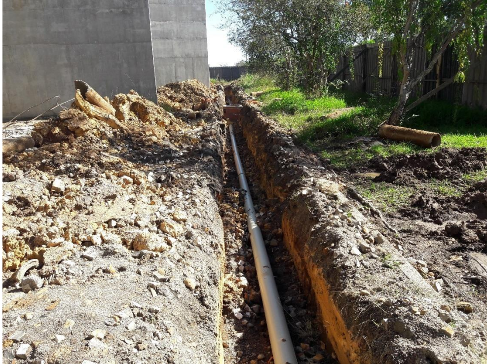
Figura 21: Tubulação da rede hidrossanitária. (Fonte: Dos autores 2017)
