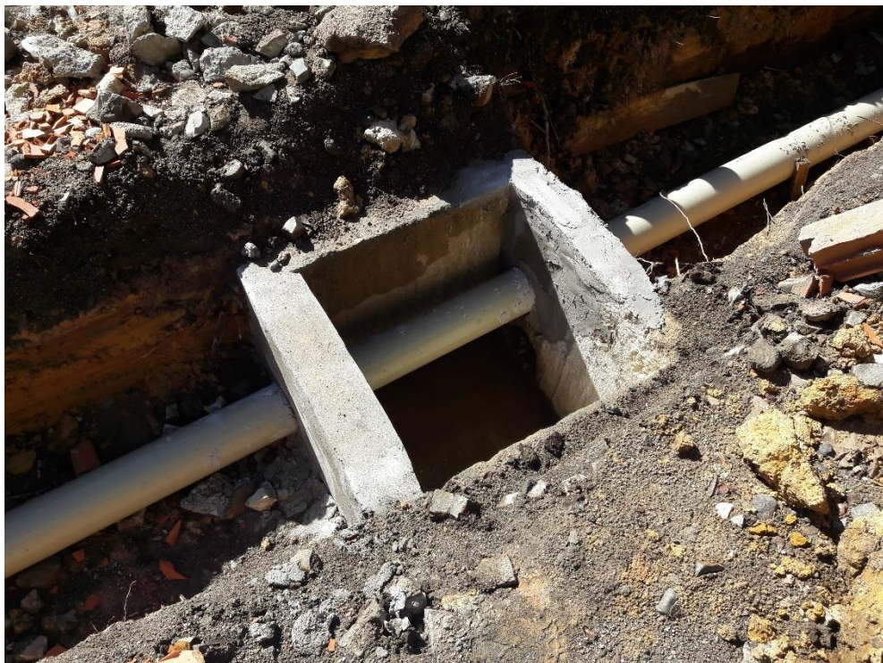
Figura 22: Caixa de inspeção. (Fonte: Dos autores 2017)
