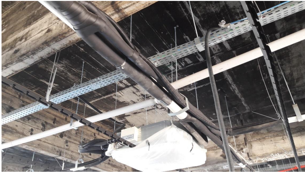
Figura 18: Tubulação água fria (Fonte: Autores)
