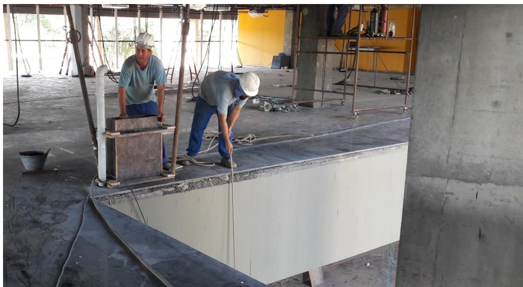
Figura 25: Realização de serviço em altura sem proteção e de forma inadequada (Fonte: Autores)
