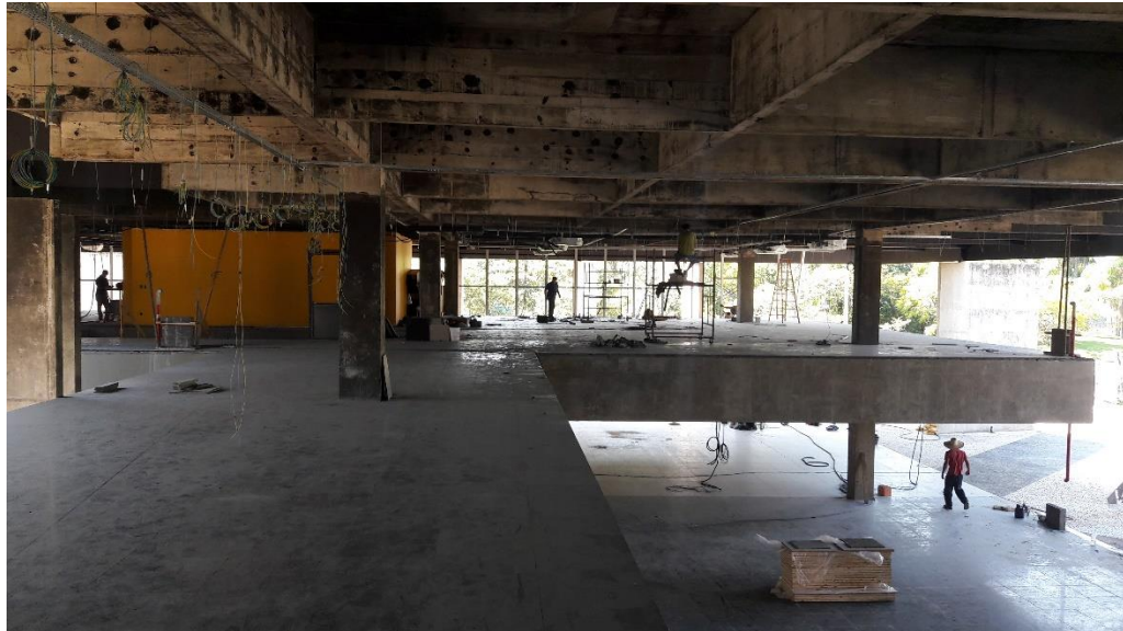
Figura 22: Pavimento superior sem proteção nas extremidades (Fonte: Autores)
