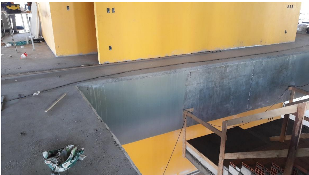
Figura 23: Falta de proteção na região aberta para escadaria (Fonte: Autores)
