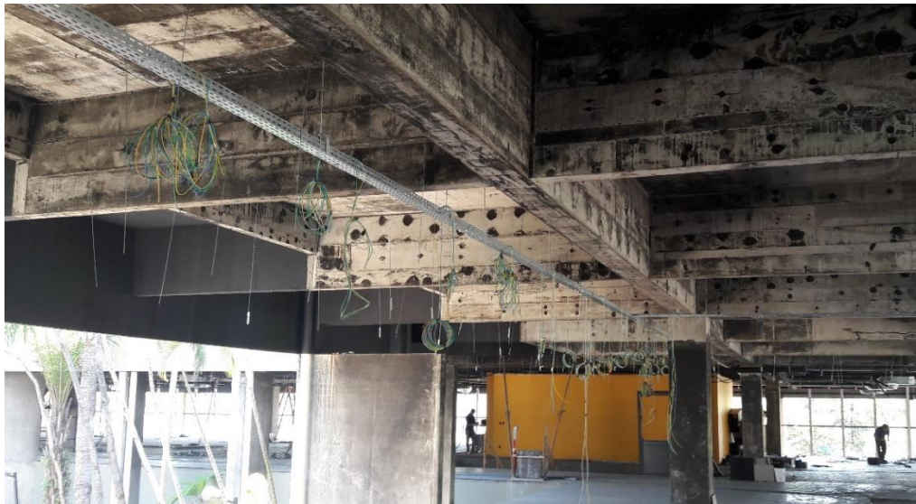
Figura 16: Eletrocalhas e fiação no segundo pavimento (Fonte: Autores)
