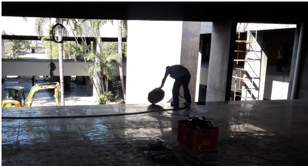
Figura 24: Realização de serviço em área de risco e sem proteção adequada (Fonte: Autores)
