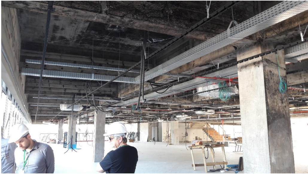
Figura 15: Eletrocalhas pavimento térreo (Fonte: Autores)
