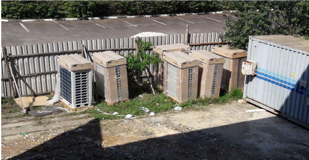
Figura 17: Equipamentos de refrigeração da água (Fonte: Autores)
