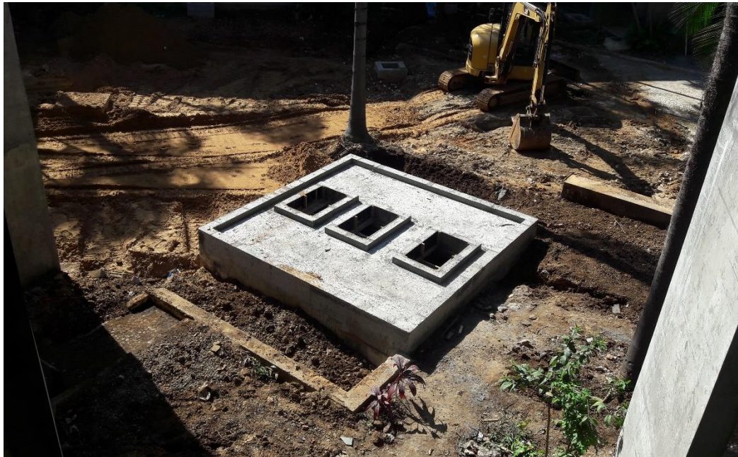
Figura 29: Reservatório de águas pluviais (Fonte: Autores)
