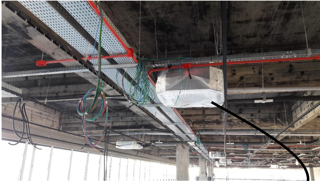
Figura 19: Ar condicionado e tubulações instaladas (Fonte: Autores)
