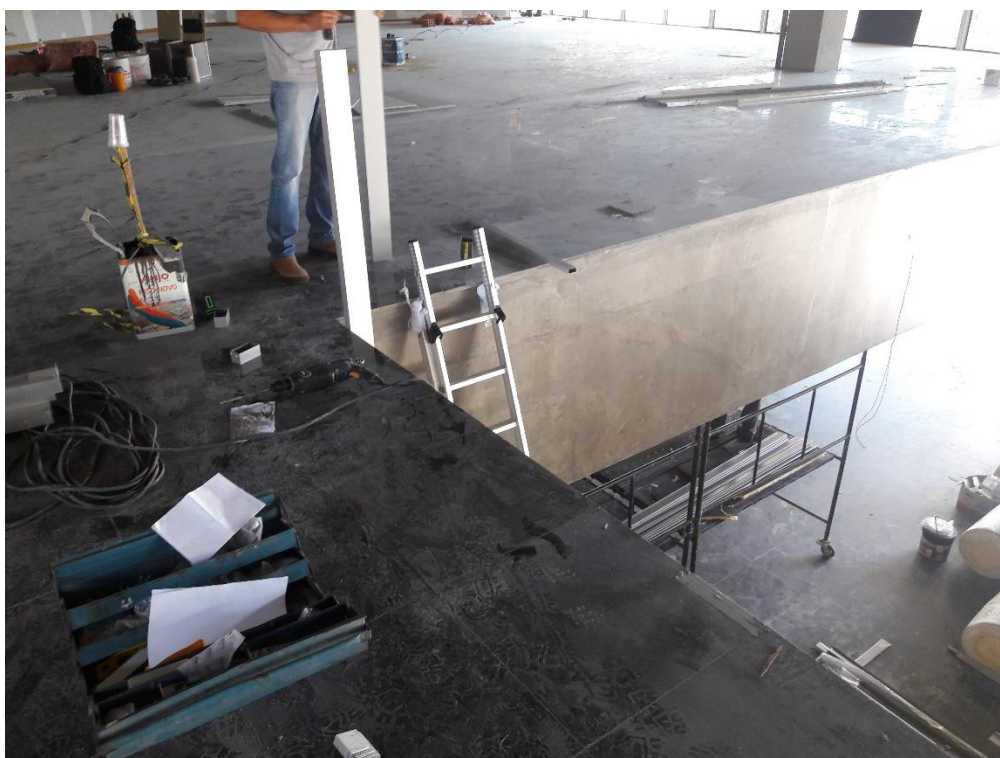
Figura 20: Funcionário realizando serviço de instalação sem equipamento de proteção contra queda (Fonte: Autores)
