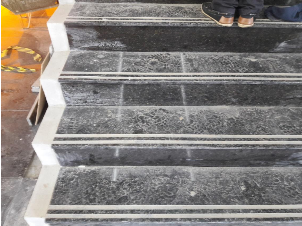
Figura 17: Assentamento na escadaria, faltando material antiderrapante (Fonte: Autores)
