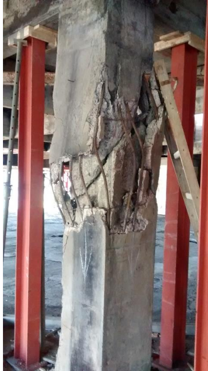
Figura 3: Pilar danificado apoiado. (Fonte: Autores)
