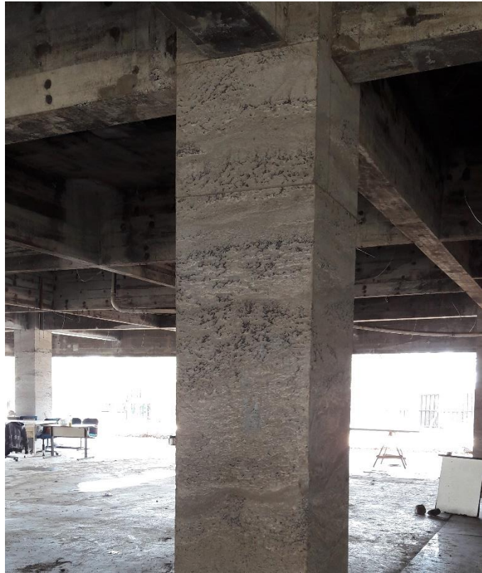
Figura 9: Pilar que necessita de regularização superficial. (Fonte: Dos autores 2016)
