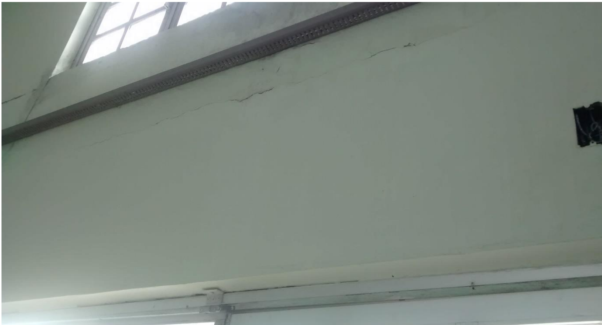
Figura 16: Fissura em uma das paredes do prédio. (Fonte: Dos Autores 2015)
