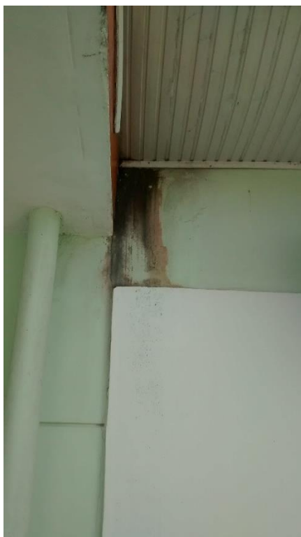
Figura 14: Problema de infiltração na cobertura. (Fonte: Dos Autores 2015)
