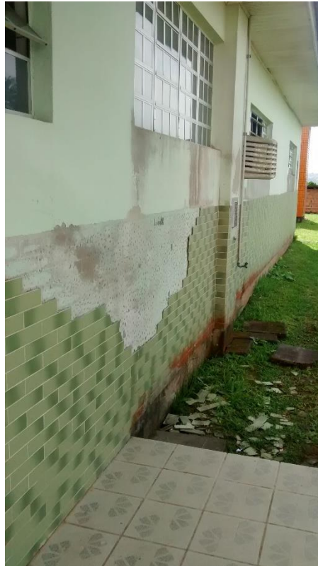
Figura 10: Revestimento cerâmico da parede caindo. (Fonte: Dos Autores 2015)
