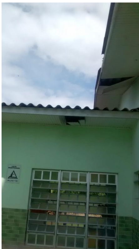
Figura 17: Beirais e telhas quebradas. (Fonte: Dos Autores 2015)
