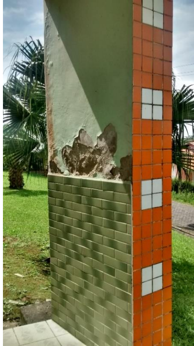
Figura 08: Descascamento da tinta e corrosão em um dos pilares do prédio. (Fonte: Dos Autores 2015)
