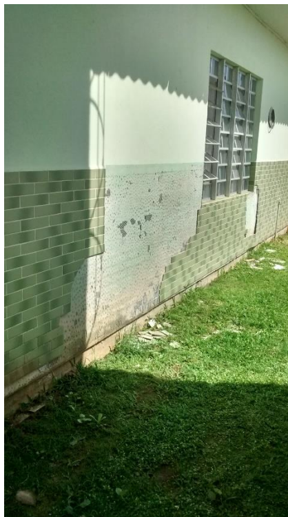
Figura 09: Revestimento cerâmico da parede caindo. (Fonte: Dos Autores 2015)
