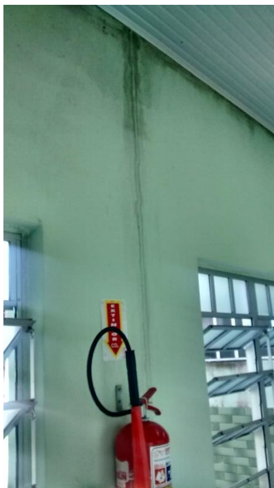
Figura 13: Problema de infiltração na cobertura. (Fonte: Dos Autores 2015)
