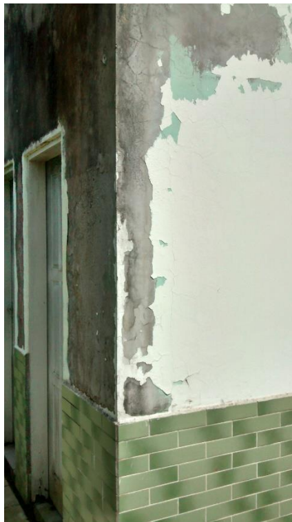
Figura 07: Descascamento da tinta em uma das paredes do prédio. (Fonte: Dos Autores 2015)
