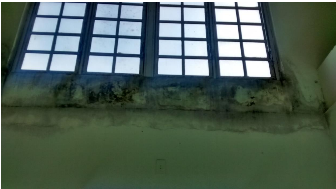
Figura 11: Problema de infiltração em uma das janelas. (Fonte: Dos Autores 2015)
