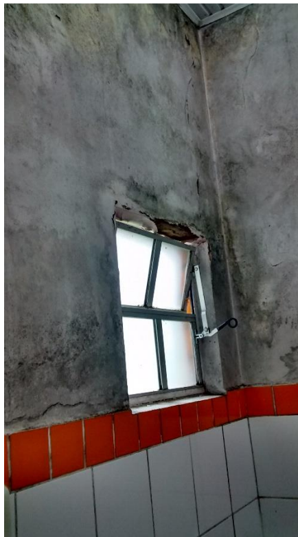
Figura 19: Situação da parede de um dos banheiros. (Fonte: Dos Autores 2016)
