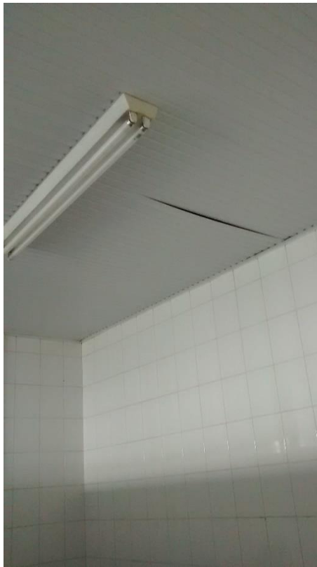
Figura 20: Situação da cobertura de uma das salas. (Fonte: Dos Autores 2016)
