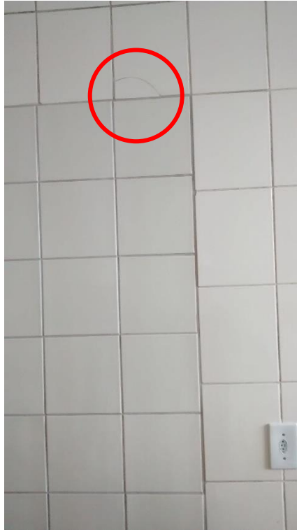
Figura 19: Revestimento cerâmico existente danificado. (Fonte: Dos Autores 2016)
