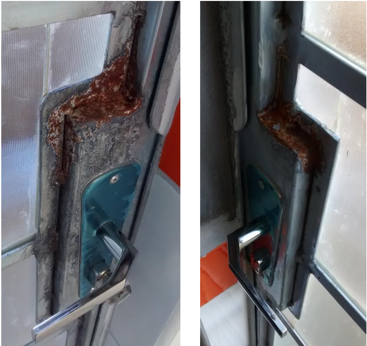
Figura 21: Oxidação nas portas metálicas instaladas. (Fonte: Dos Autores 2016)
