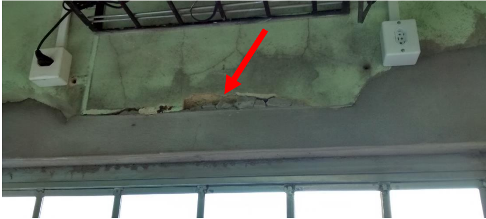
Figura 22: Quebra da argamassa sobre uma das portas metálicas. (Fonte: Dos Autores 2016)
