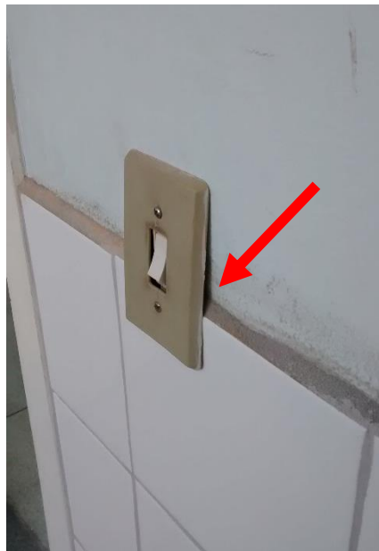
Figura 10: Conjunto de interruptor instalado em um dos consultórios. (Fonte: Dos Autores 2016)
