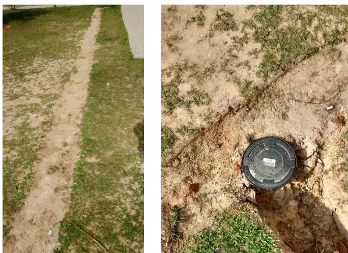
Figura 14: Estrutura subterrânea do SPDA. (Fonte: Dos Autores 2016)
