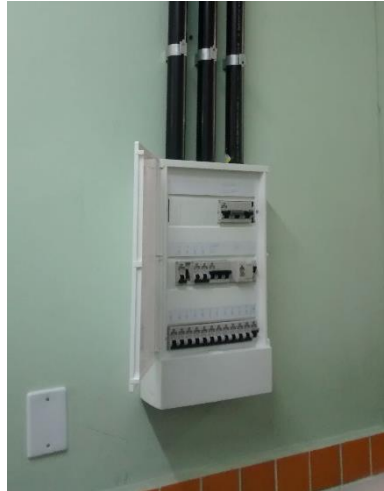
Figura 12: Quadro de distribuição instalado. (Fonte: Dos Autores 2016)
