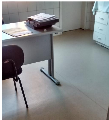
Figura 13: Piso em manta vinílica instalada em um dos ambientes. (Fonte: Dos Autores 2016)
