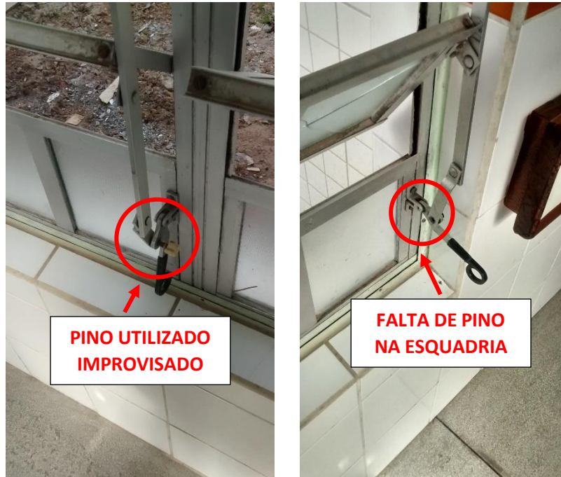
Figura 18: Problemas identificados em algumas esquadrias. (Fonte: Dos Autores 2016)
