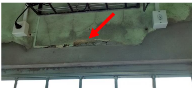
Figura 16: Quebra da argamassa sobre uma das portas metálicas. (Fonte: Dos Autores 2016)
