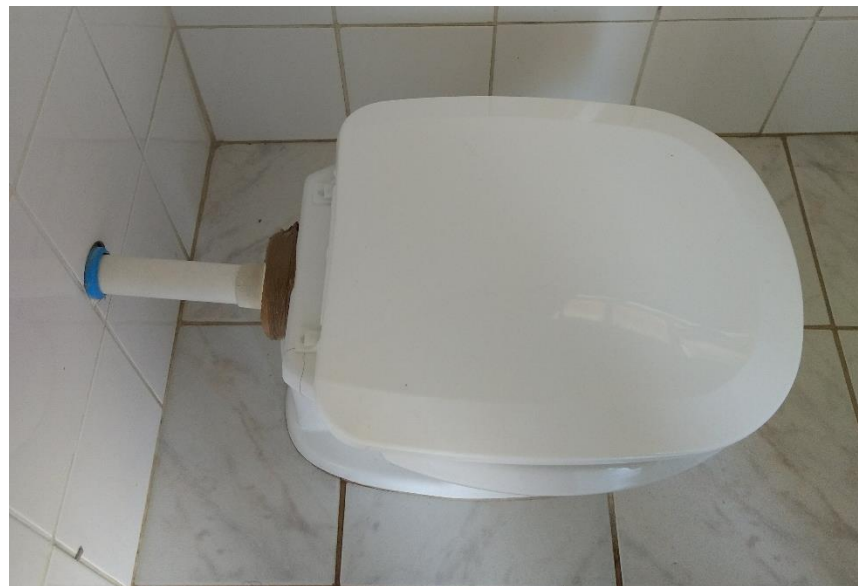
Figura 31: Reparo feito com fita, devido à má instalação. (Fonte: Dos Autores 2018)
