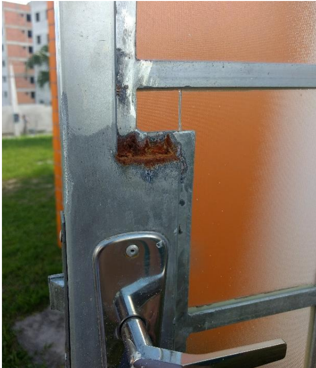
Figura 33: Porta de aço com ferrugem na solda. (Fonte: Dos Autores 2018)
