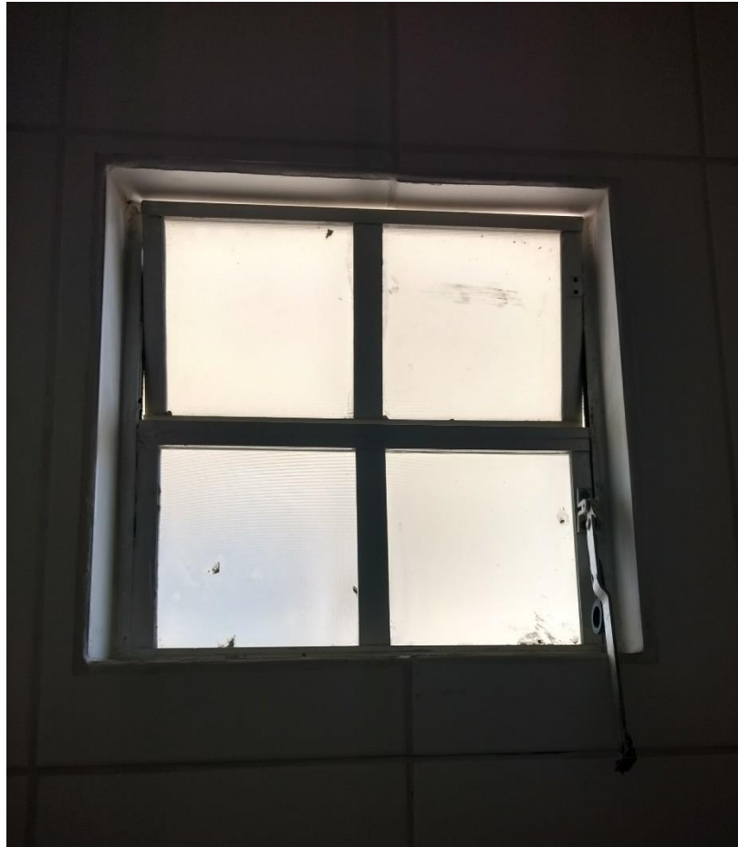
Figura 32: Alavanca da janela do banheiro quebrada. (Fonte: Dos Autores 2018)
