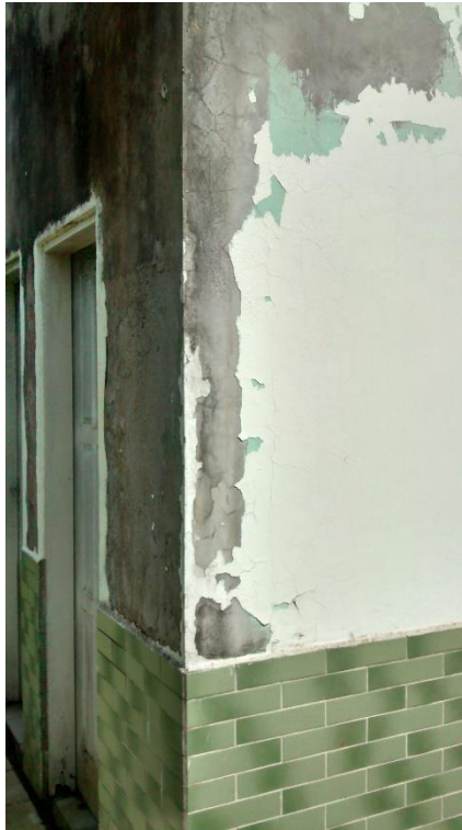
Figura 5: Descascamento da tinta em uma das paredes do prédio. (Fonte: Dos Autores 2015)
