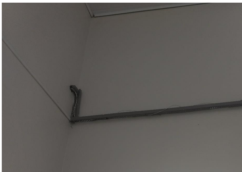
Figura 36: Fios fora da eletrocalha. (Fonte: Dos Autores 2018)
