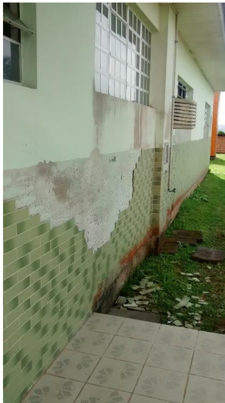
Figura 6: Revestimento cerâmico apresentando descolamento. (Fonte: Dos Autores 2015)
