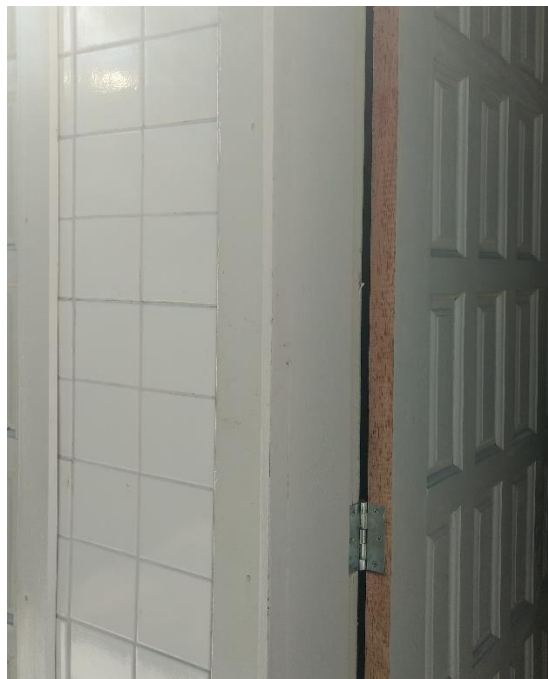
Figura 41: Porta plainada, sem acabamento. (Fonte: Dos Autores 2018)
