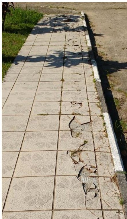
Figura 37: Azulejos da calçada quebrados durante a reforma. (Fonte: Dos Autores 2018)
