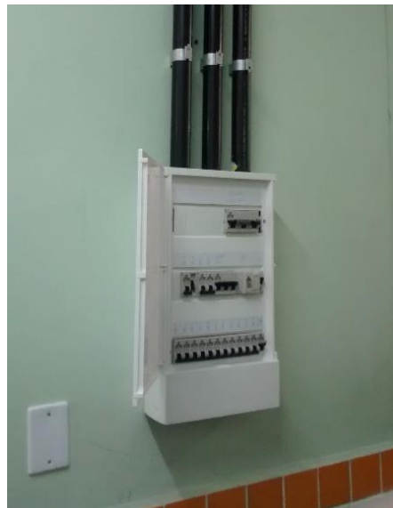
Figura 20: Quadro de distribuição instalado. (Fonte: Dos Autores 2016)
