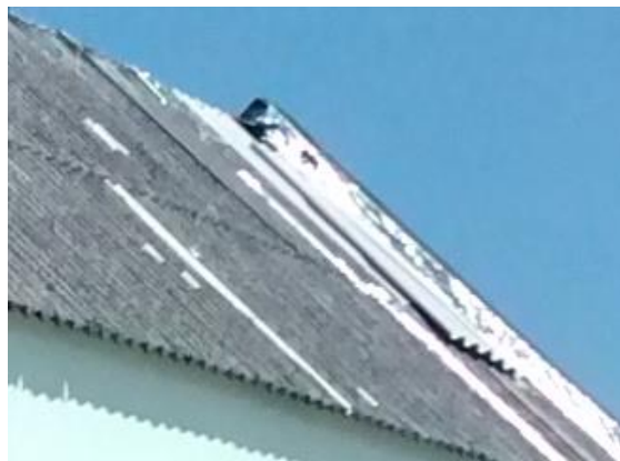
Figura 22: Detalhe do telhado danificado. (Fonte: Dos Autores 2016)
