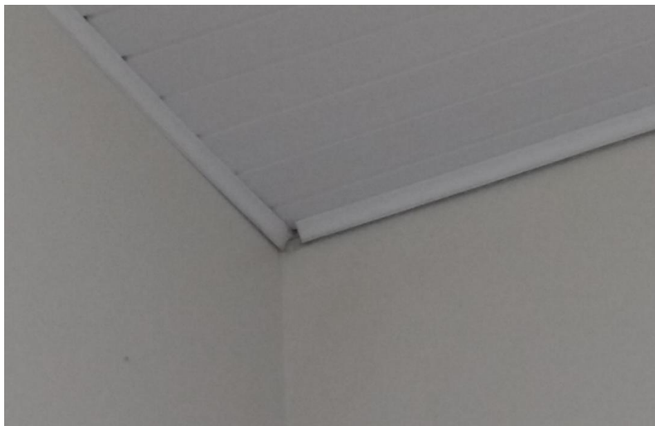
Figura 29: Falta de acabamento. (Fonte: Autores 2018)
