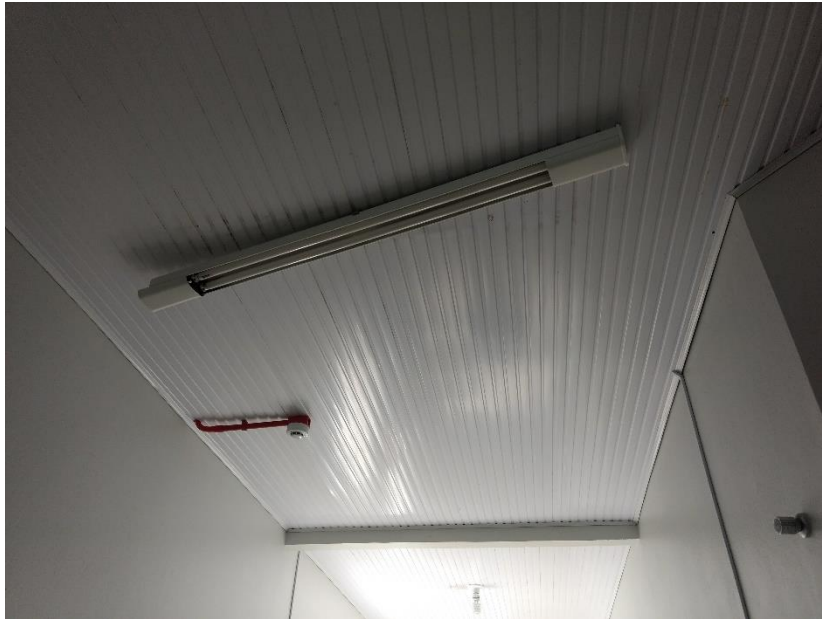
Figura 35: Lâmpada desalinhada. (Fonte: Dos Autores 2018)
