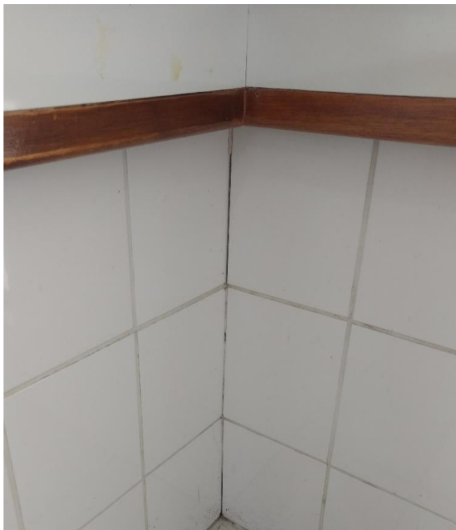
Figura 34: Falta de rejunte entre os pisos da recepção da unidade de saúde. (Fonte: Autores 2018)
