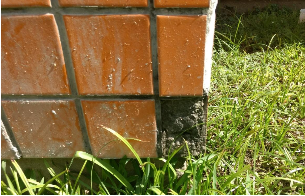
Figura 27: Falta de ladrilho. (Fonte: Autores 2018)
