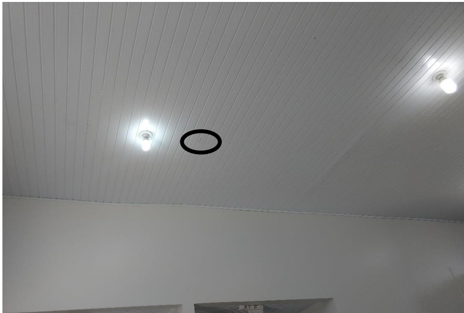
Figura 28: Furo e empenamento no forro de PVC. (Fonte: Autores 2018)
