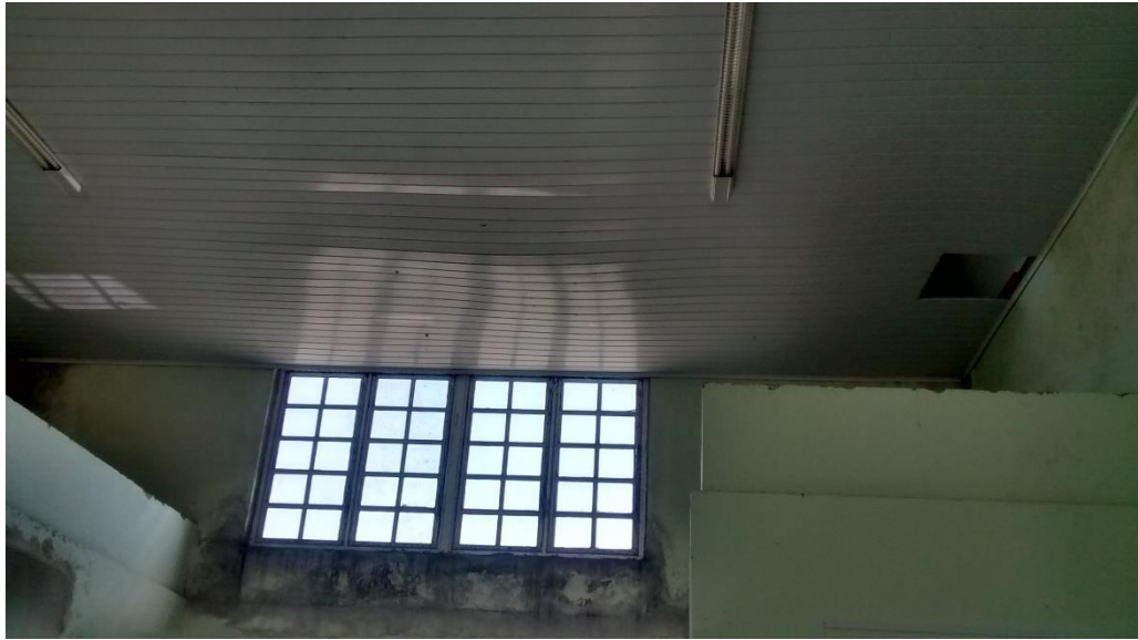
Figura 21: Detalhe do rebaixamento do forro de PVC. (Fonte: Dos Autores 2016)
