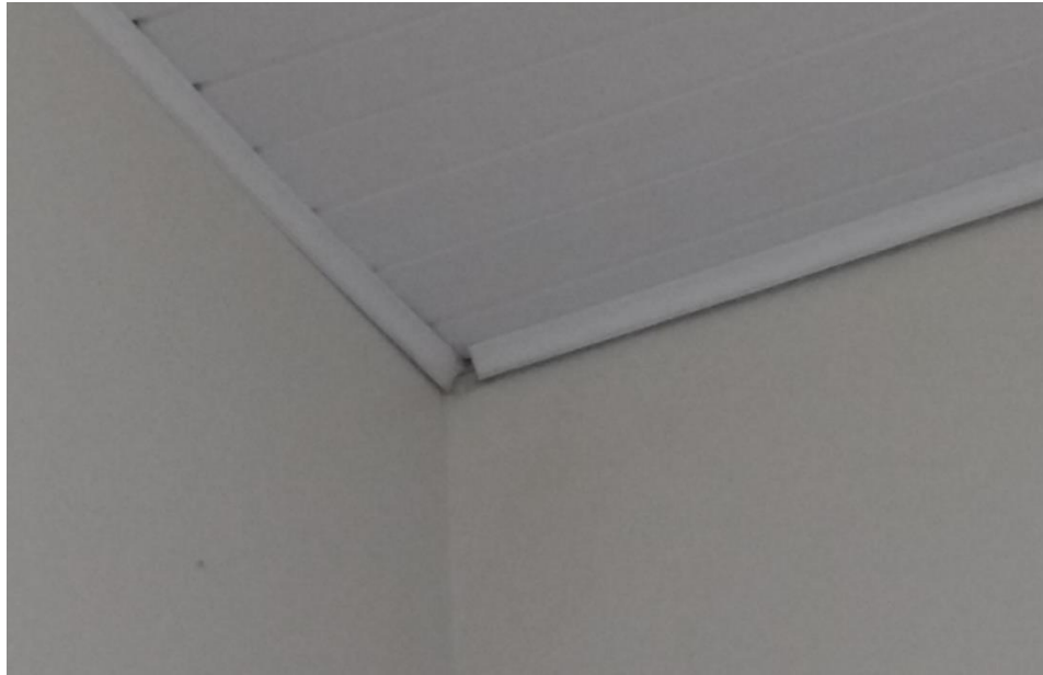
Figura 29: Falta de acabamento. (Fonte: Autores 2018)
