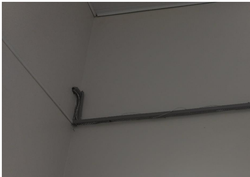
Figura 36: Fios fora da eletrocalha. (Fonte: Dos Autores 2018)
