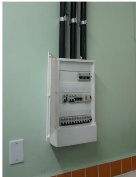
Figura 20: Quadro de distribuição instalado. (Fonte: Dos Autores 2016)
