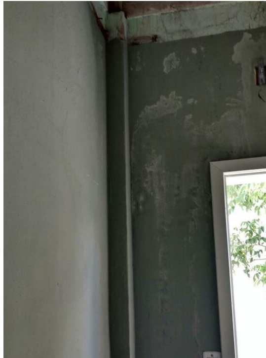
Figura 40: Pintura descascada. (Fonte: Dos Autores 2018)
