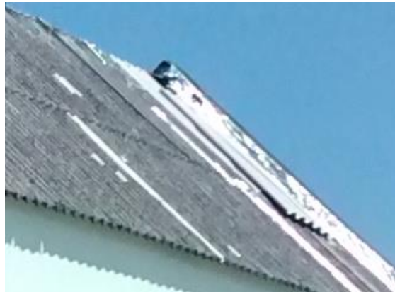
Figura 22: Detalhe do telhado danificado. (Fonte: Dos Autores 2016)
