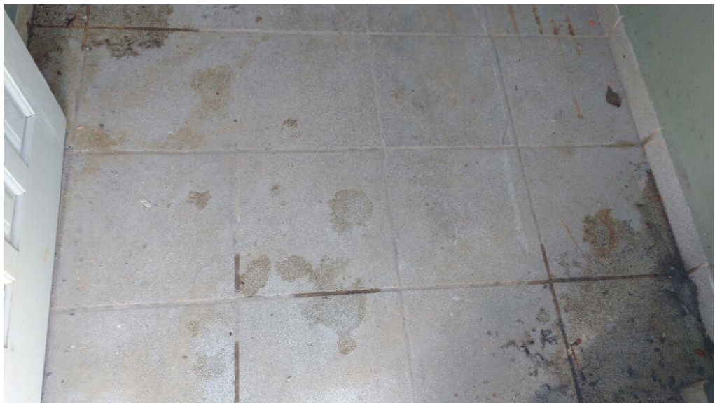
Figura 39: Goteiras no piso abaixo da caixa d'agua. (Fonte: Dos Autores 2018)
