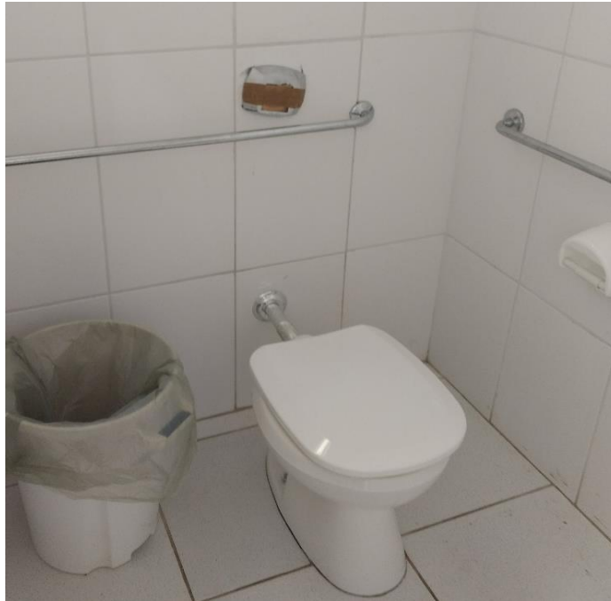
Figura 30: Válvula de descarga do banheiro masculino quebrada. (Fonte: Dos Autores 2018)
