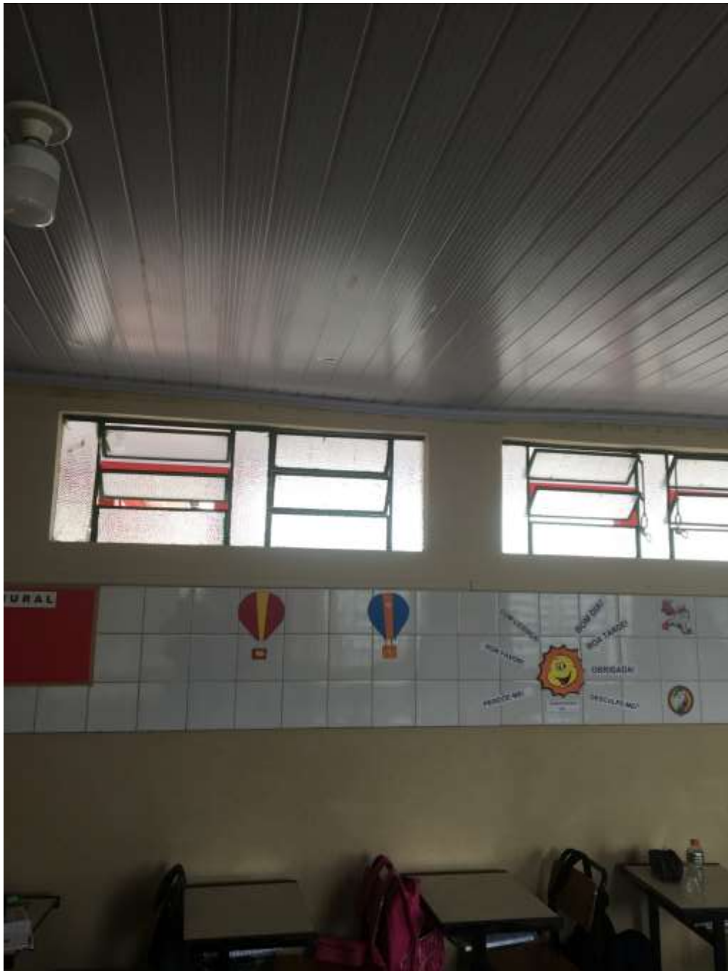
Figura 8: Desnível do forro da sala - turma 41, quarto ano. (Fonte: Dos Autores 2019)
