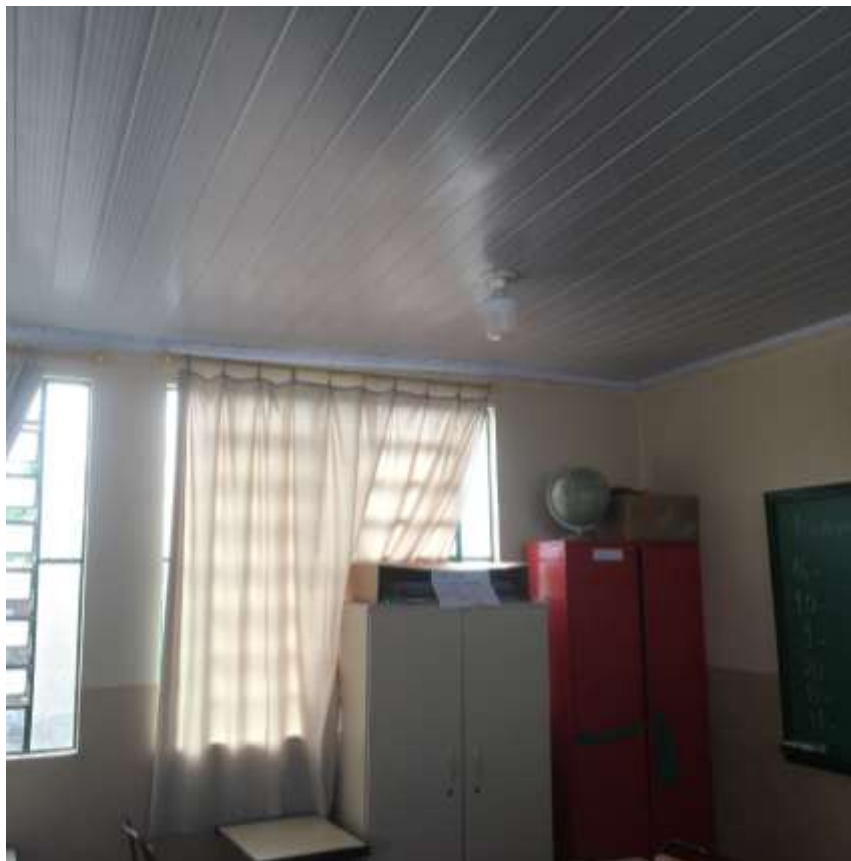
Figura 10: Desnível do forro da sala - turma 201, segundo ano. (Fonte: Dos Autores 2019)
