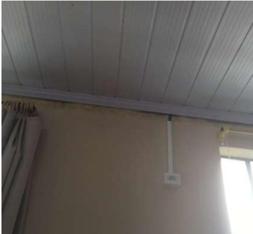
Figura 9: Desnível do forro da sala - turma 41, quarto ano. (Fonte: Dos Autores 2019)
