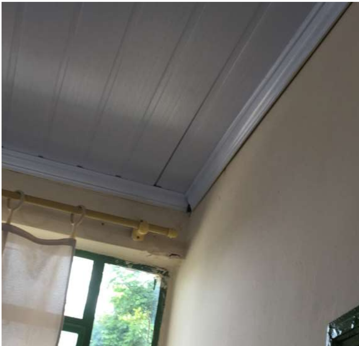
Figura 13: Falta da junção de meia cana e vão no acabamento do forro. (Fonte: Dos Autores 2019)
