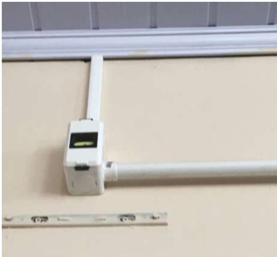
Figura 12: Vão no acabamento do forro. (Fonte: Dos autores 2019)
