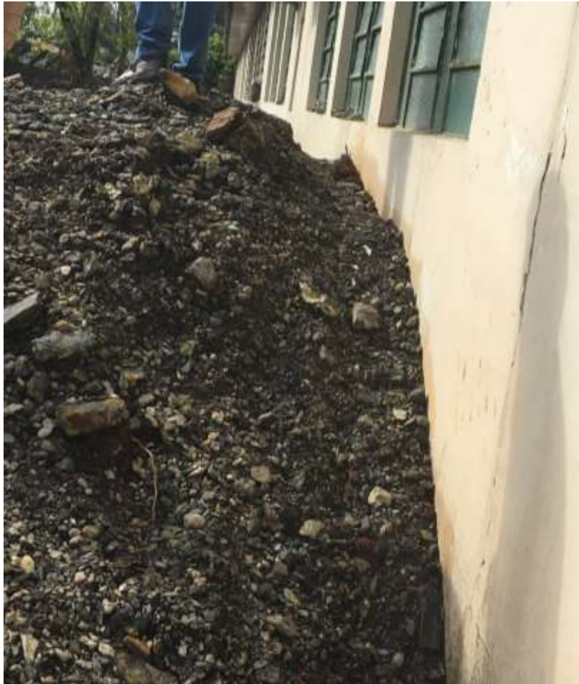
Figura 18: Acúmulo de material apoiado nas paredes da escola. (Fonte: Dos Autores 2019)
