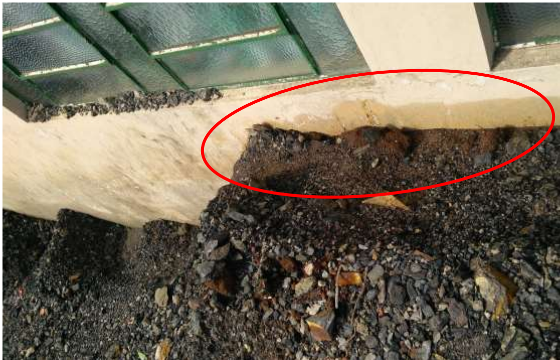
Figura 19: Infiltração causada pelo material escavado. (Fonte: Dos Autores 2019)
