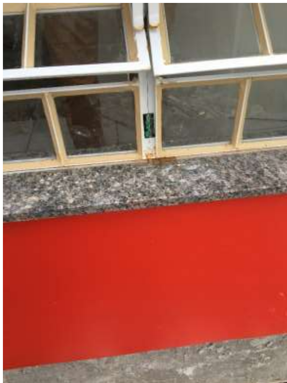
Figura 18: Esquadrias com sinais de oxidação. (Fonte: Dos Autores 2019)
