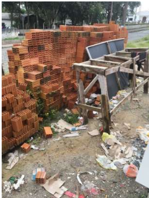
Figura 8: Armazenamento incorreto de material. (Fonte: Dos Autores 2019)
