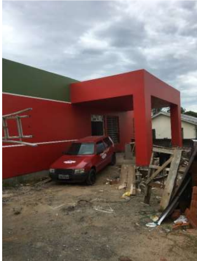
Figura 10: Falta de pingadeira na platibanda. (Fonte: Dos Autores 2019)
