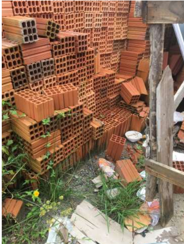
Figura 9: Armazenamento incorreto de material. (Fonte: Dos Autores 2019)
