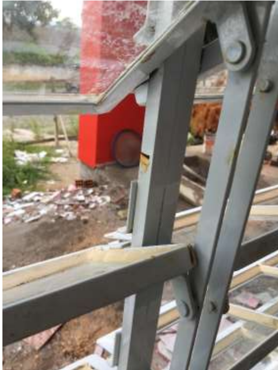
Figura 17: Esquadria com sinais de oxidação. (Fonte: Dos Autores 2019)
