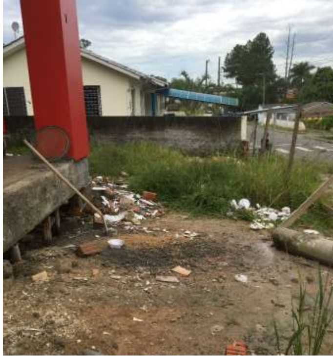
Figura 5: Acúmulo de lixo pelo canteiro. (Fonte: Dos Autores 2019)
