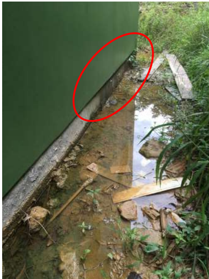
Figura 13: Acúmulo de água causando infiltração. (Fonte: Dos Autores 2019)
