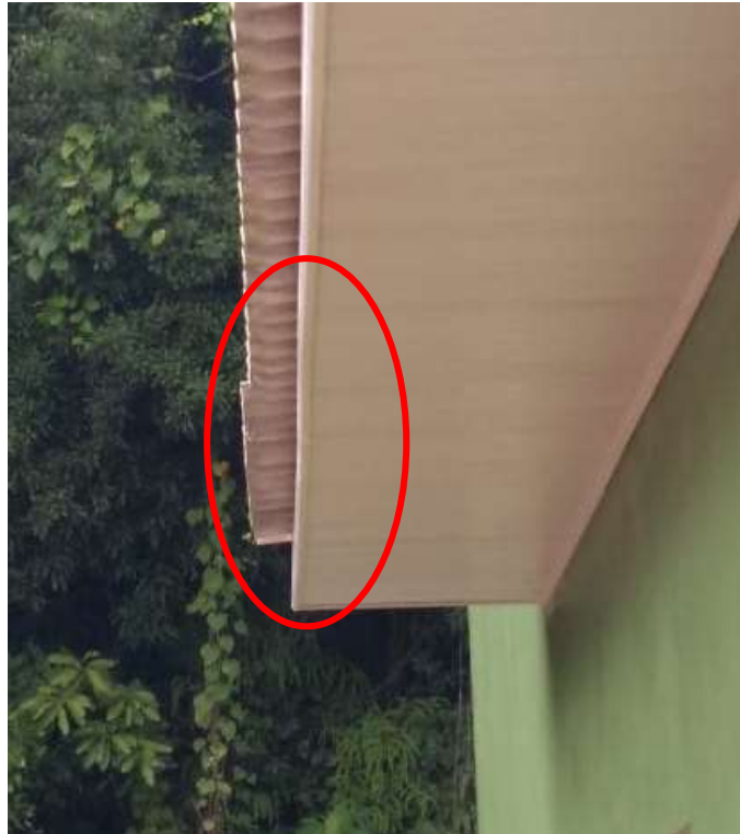
Figura 12: Desalinhamento de telhas. (Fonte: Dos Autores 2019)
