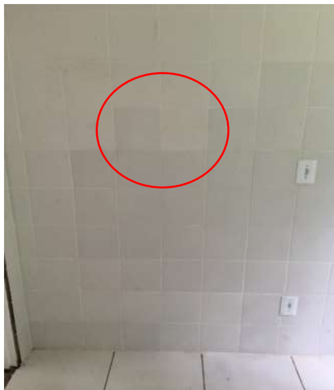
Figura 21: Diferença na tonalidade dos azulejos. (Fonte: Dos Autores 2019)
