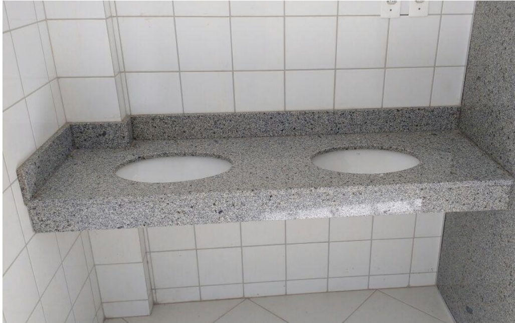
Figura 12: Pias do banheiro, faltando torneiras. (Fonte: Dos Autores 2018)
