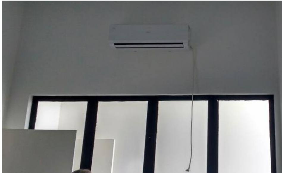
Figura 16: Falta de instalação da tomada. (Fonte: Dos Autores 2018)
