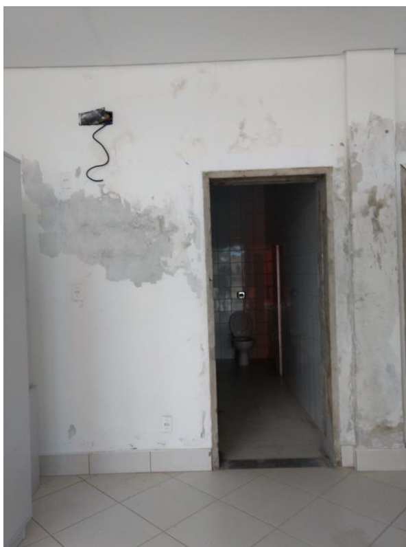
Figura 9: Parede com sinais de umidade. (Fonte: Dos Autores 2018)
