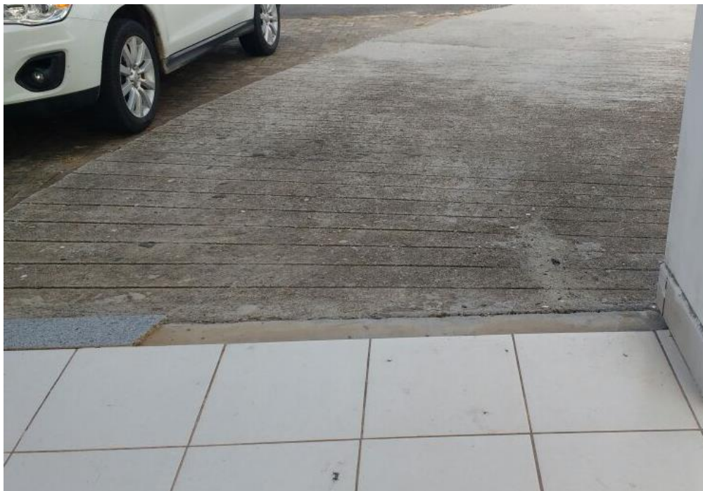
Figura 6: Falta de parte da soleira. (Fonte: Dos Autores 2018)
