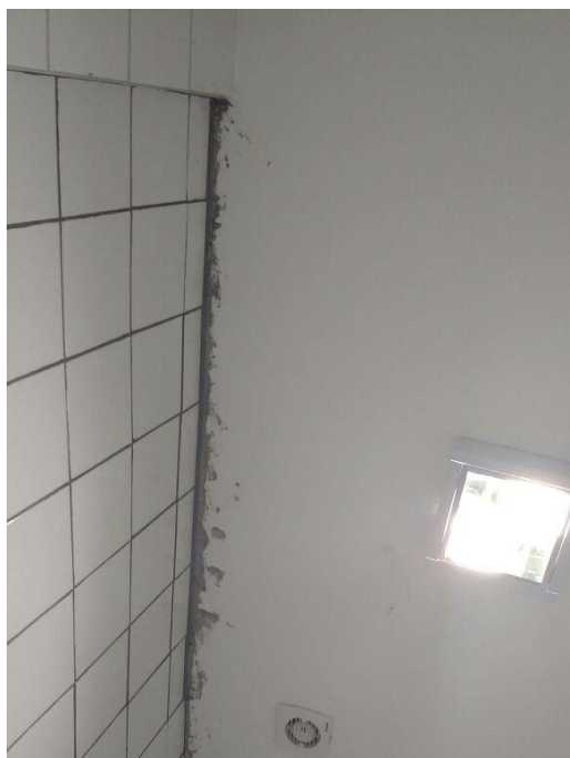
Figura 22: Falta de acabamento. (Fonte: Dos Autores 2018)
