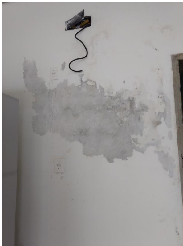
Figura 10: Parede com sinais de umidade. (Fonte: Dos Autores 2018)
