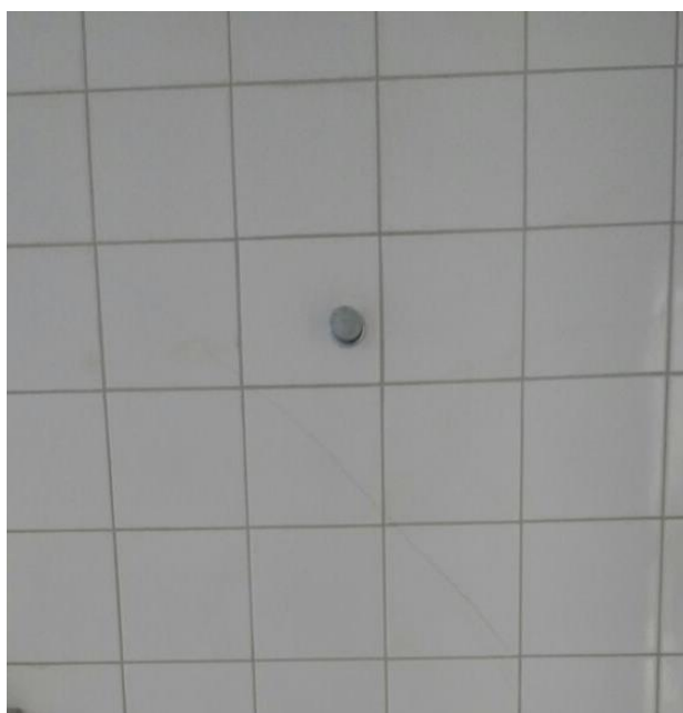
Figura 19: Fissuras nos azulejos. (Fonte: Dos Autores 2018)
