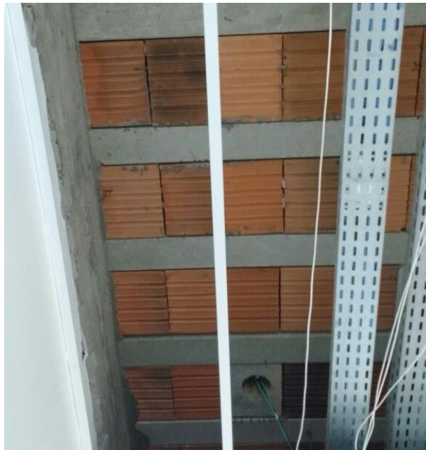
Figura 15: Fios de eletricidade fora da eletrocalha. (Fonte: Dos Autores 2018)
