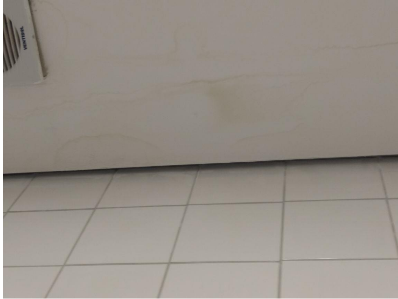
Figura 23: Umidade no forro da unidade. (Fonte: Dos Autores 2018)
