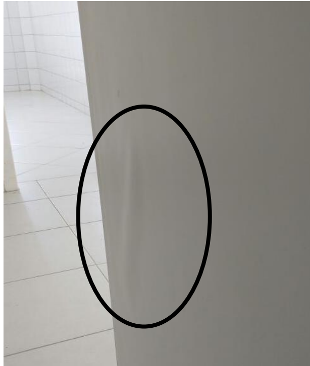
Figura 20: Bolha na pintura. (Fonte: Dos Autores 2018)
