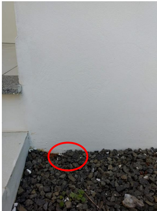
Figura 14: Reboco muito próximo ao solo. (Fonte: Dos Autores 2018)
