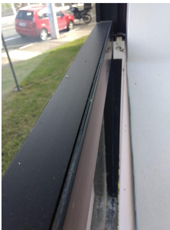
Figura 12: Falta de acabamento na janela. (Fonte: Dos Autores 2018)
