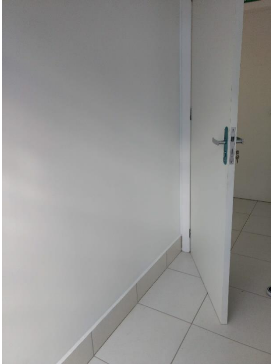
Figura 13: Falta de dispositivo para travamento da porta. (Fonte: Dos Autores 2018)
