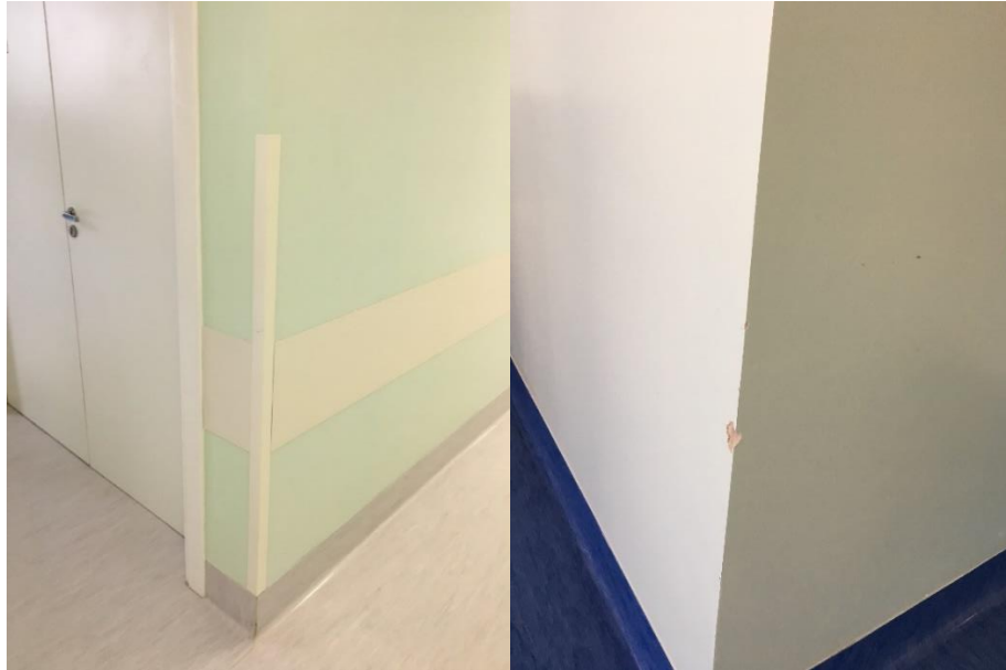
Figura 20: Falta de bate macas na parede. (Fonte: Dos Autores 2018)
