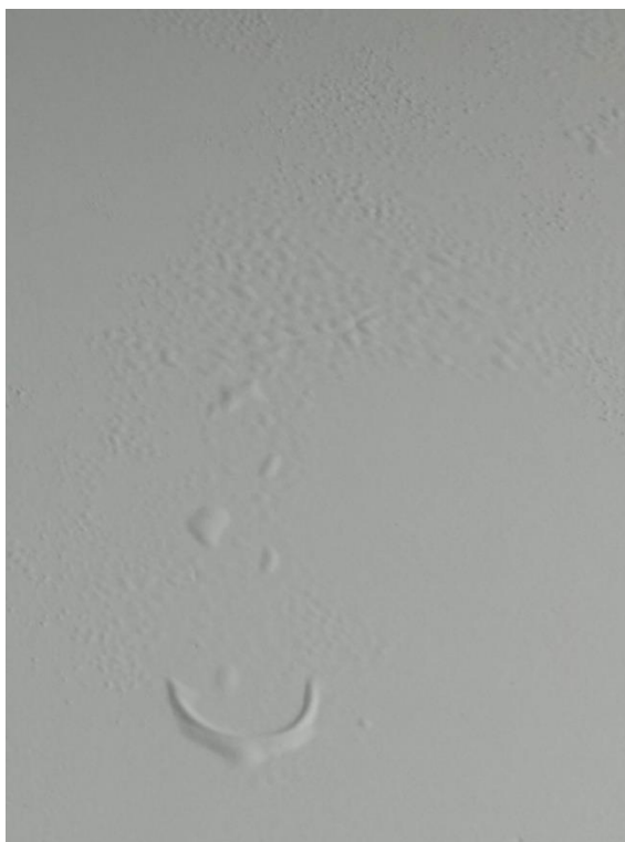
Figura 17: Bolhas na pintura. (Fonte: Dos Autores 2018)
