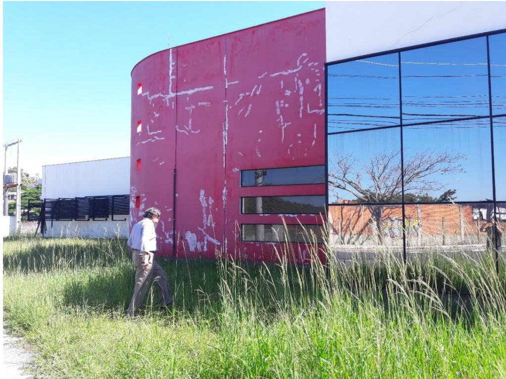
Figura 7: Gramado alto e patologias na estrutura. (Fonte: Dos Autores 2017)
