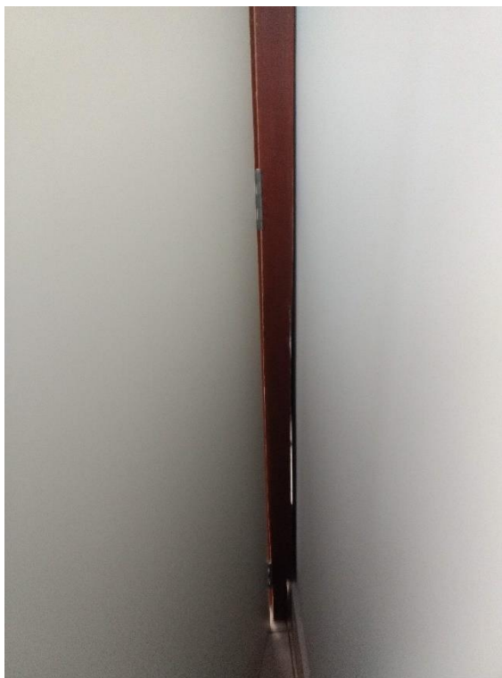
Figura 11: Falta de massa entre a esquadria da porta e a parede. (Fonte: Dos Autores 2018)
