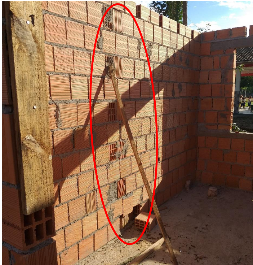
Figura 25: Blocos cerâmicos assentados incorretamente (Fonte: Dos Autores 2019)
