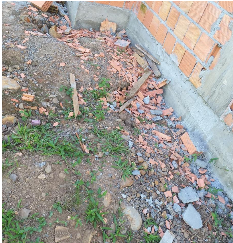
Figura 7: Entulho da obra descartado incorretamente (Fonte: Dos Autores 2019)
