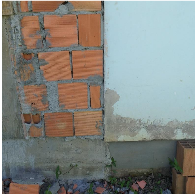
Figura 30: Encontro das estruturas e infiltração (Fonte: Dos Autores 2019)
