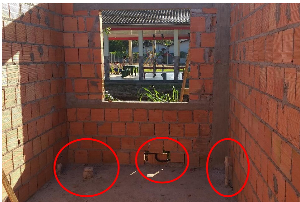
Figura 24: Consultório com tubulações hidráulicas e elétricas (Fonte: Dos Autores 2019)
