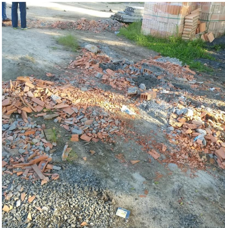
Figura 9: Entulho da obra descartado incorretamente (Fonte: Dos Autores 2019)
