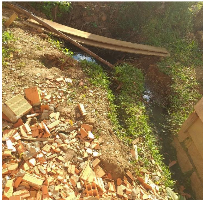
Figura 31: Grande quantidade de água parada na lateral das construções (Fonte: Dos Autores 2019)
