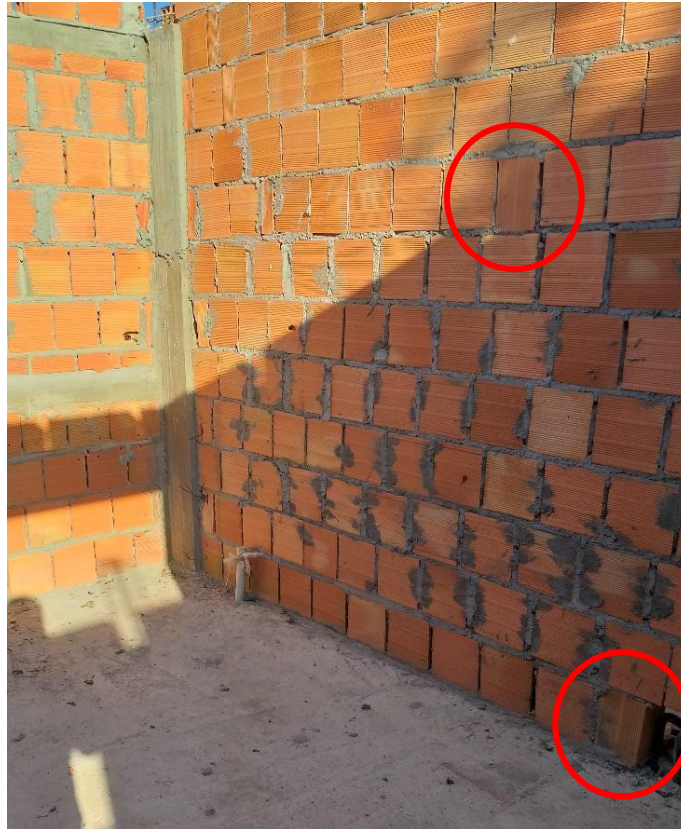
Figura 27: Blocos cerâmicos assentados incorretamente (Fonte: Dos Autores 2019)
