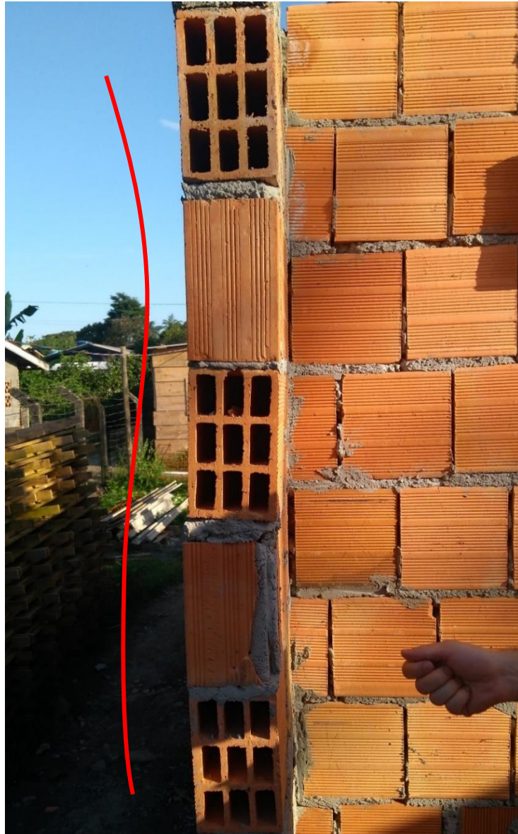
Figura 22: Barriga na parede (Fonte: Dos Autores 2019)
