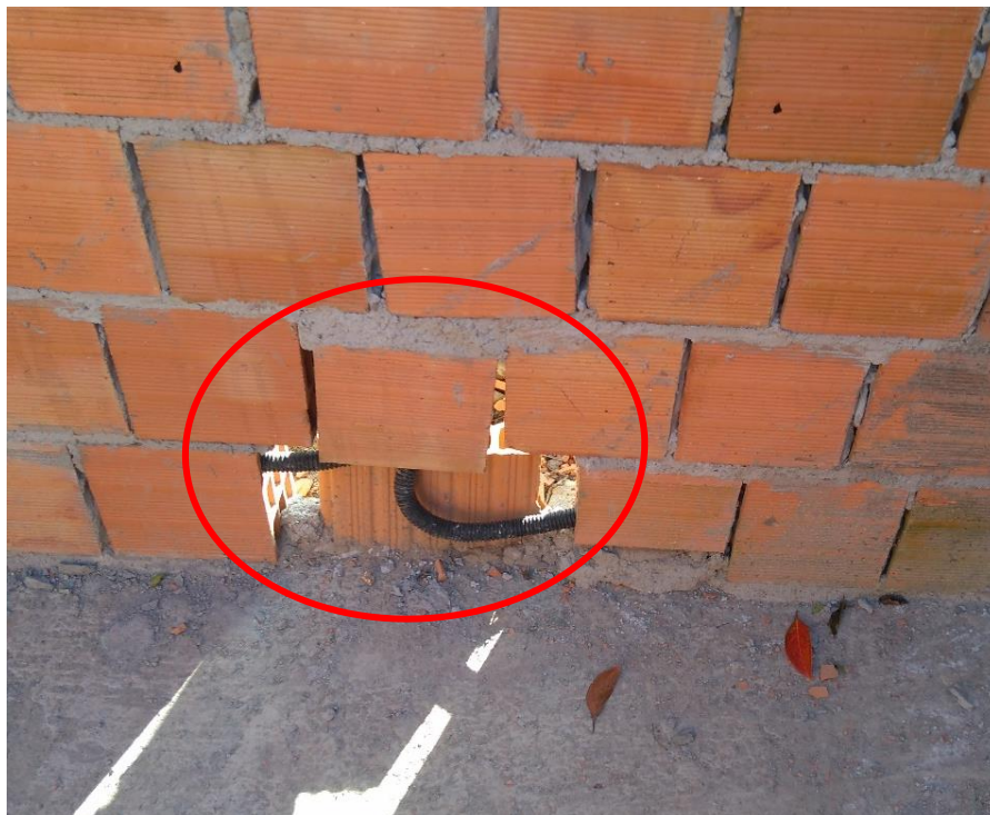
Figura 26: Blocos cerâmicos assentados incorretamente (Fonte: Dos Autores 2019)
