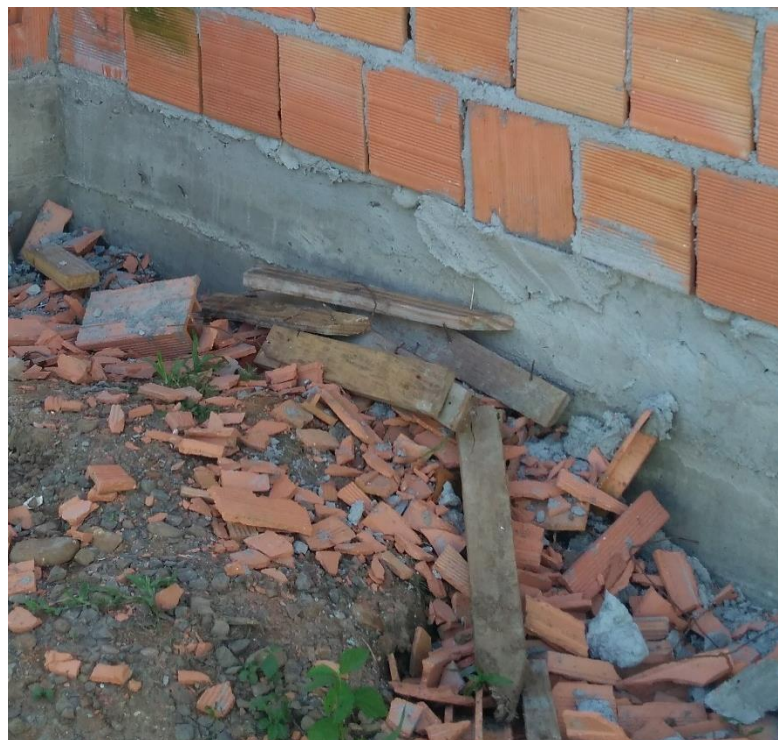
Figura 8: Entulho da obra descartado incorretamente (Fonte: Dos Autores 2019)
