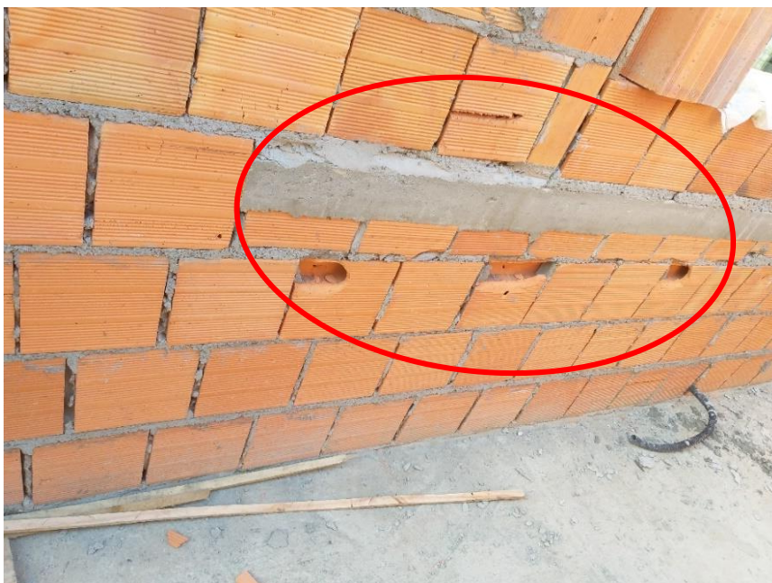
Figura 28: Blocos cerâmicos fraturados (Fonte: Dos Autores 2019)
