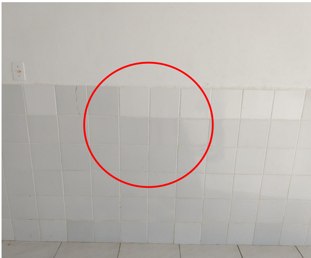
Figura 66: Diferença de coloração nos azulejos do espaço. (Fonte: Dos Autores 2019)
