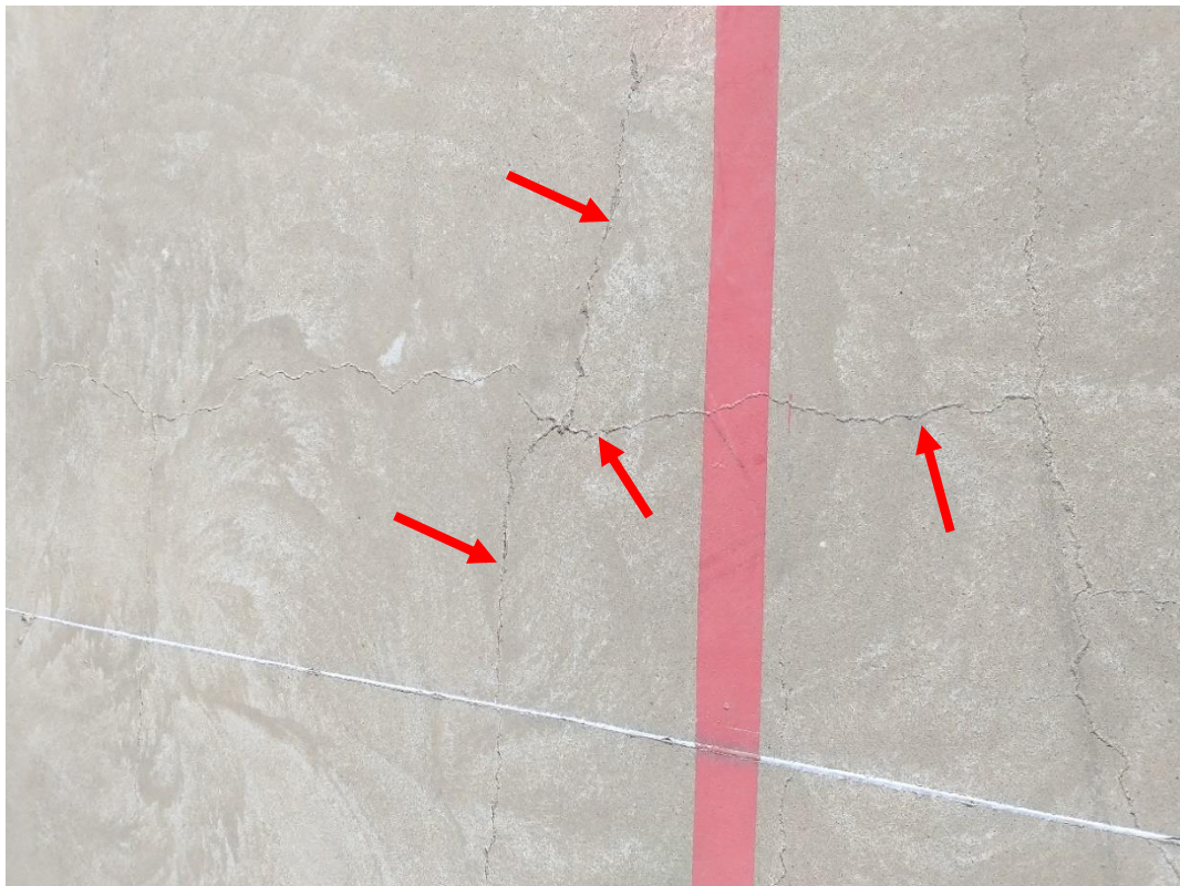
Figura 46: Fissuras na quadra poliesportiva. (Fonte: Dos Autores 2019)
