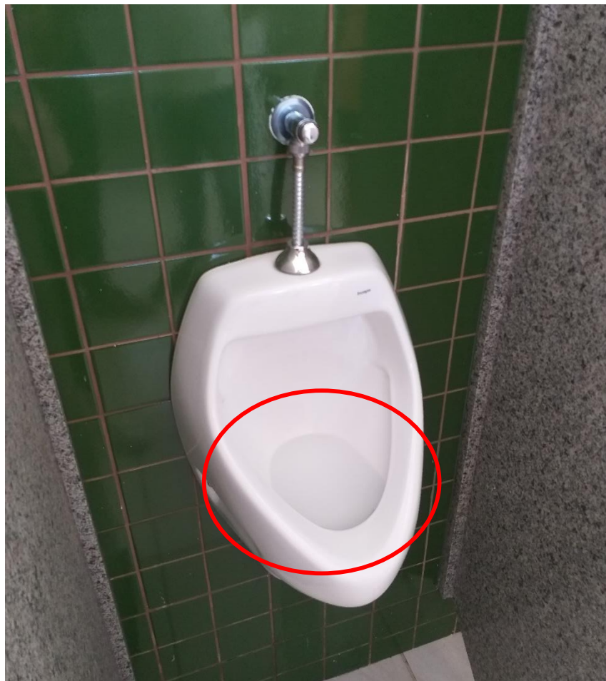
Figura 83: Mictório entupido. (Fonte: Dos Autores 2019)
