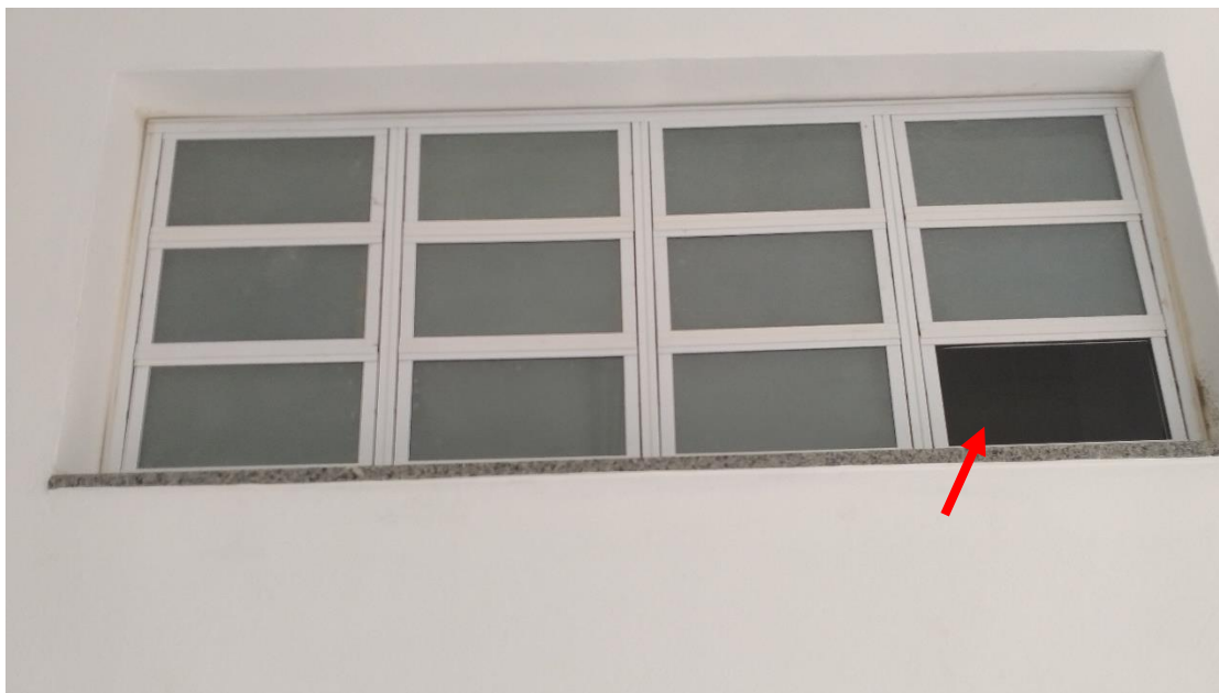
Figura 87: Vidro quebrado no depósito de materiais de limpeza. (Fonte Dos Autores 2019)
