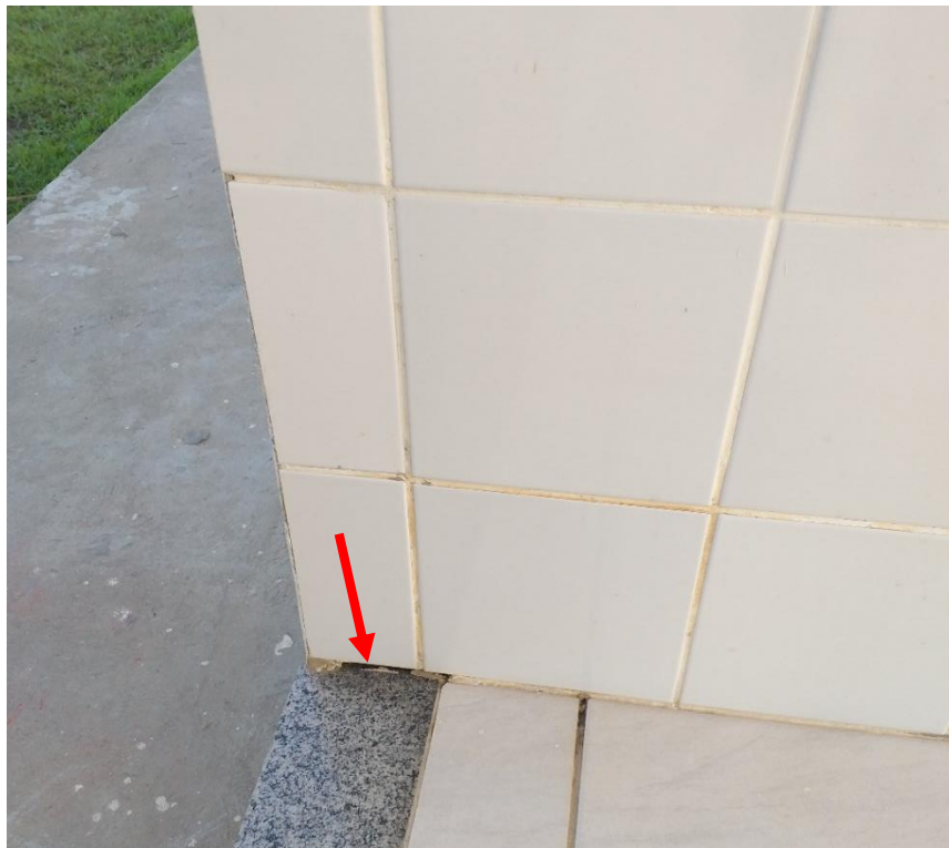
Figura 68: Rejuntas desgastadas. (Fonte: Dos Autores 2019)
