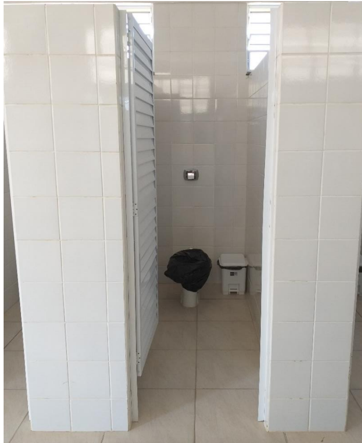
Figura 84: Vaso sanitário entupido. (Fonte: Dos Autores 2019)
