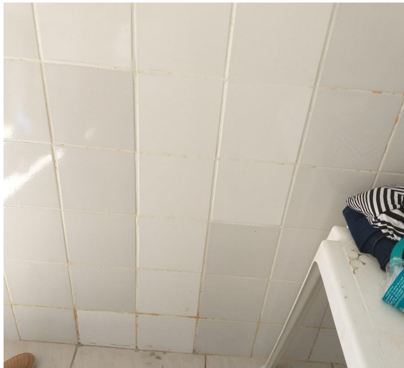
Figura 70: Diferença de coloração dos azulejos. (Fonte: Dos Autores 2019)
