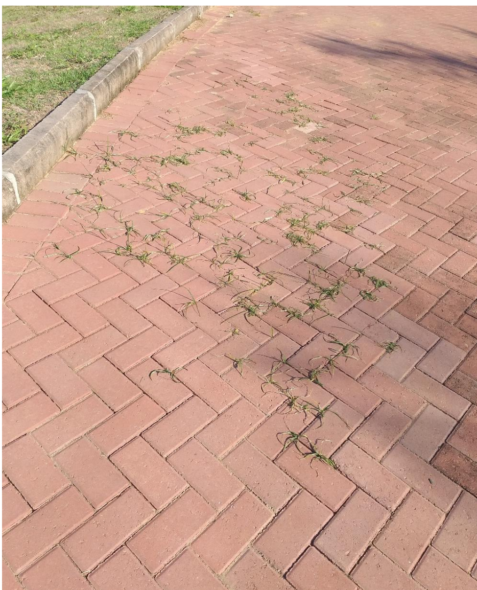
Figura 49: Crescimento de vegetação entre os pavers. (Fonte: Dos Autores 2019)
