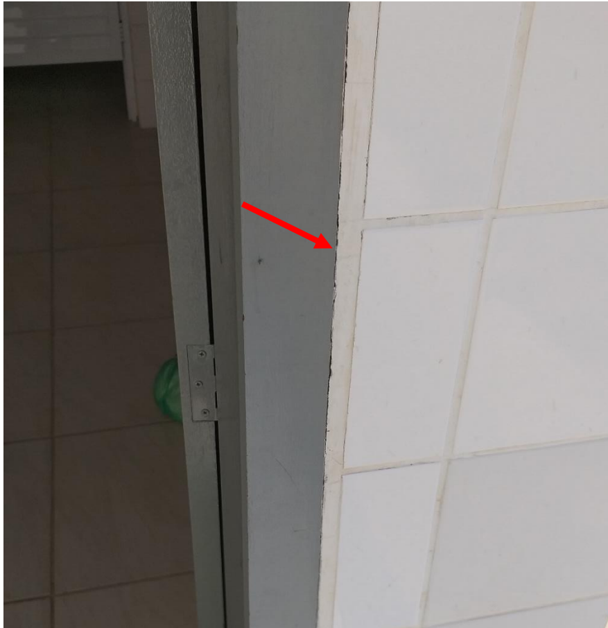
Figura 67: Rejuntas desgastadas. (Fonte: Dos Autores 2019)
