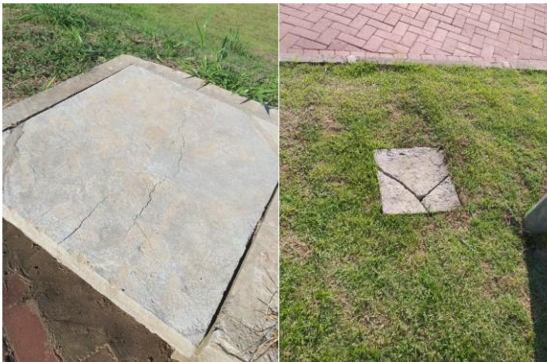
Figura 88: Fissuras e rachaduras perceptíveis. (Fonte: Dos Autores 2019)
