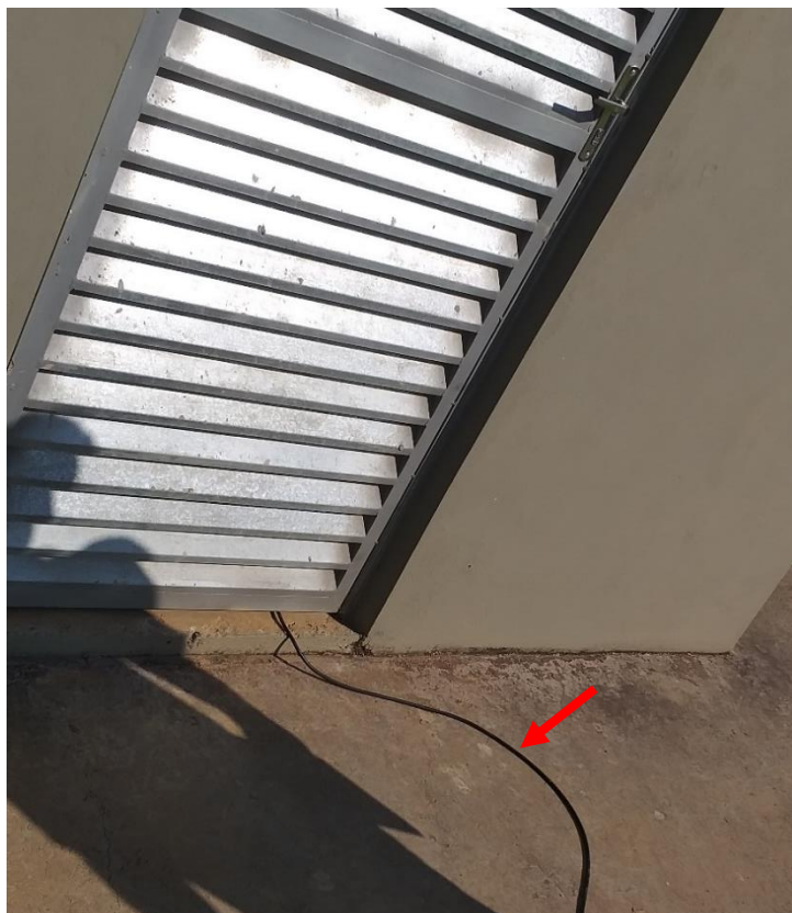
Figura 59: Fio de energia exposto. (Fonte: Dos Autores 2019)
