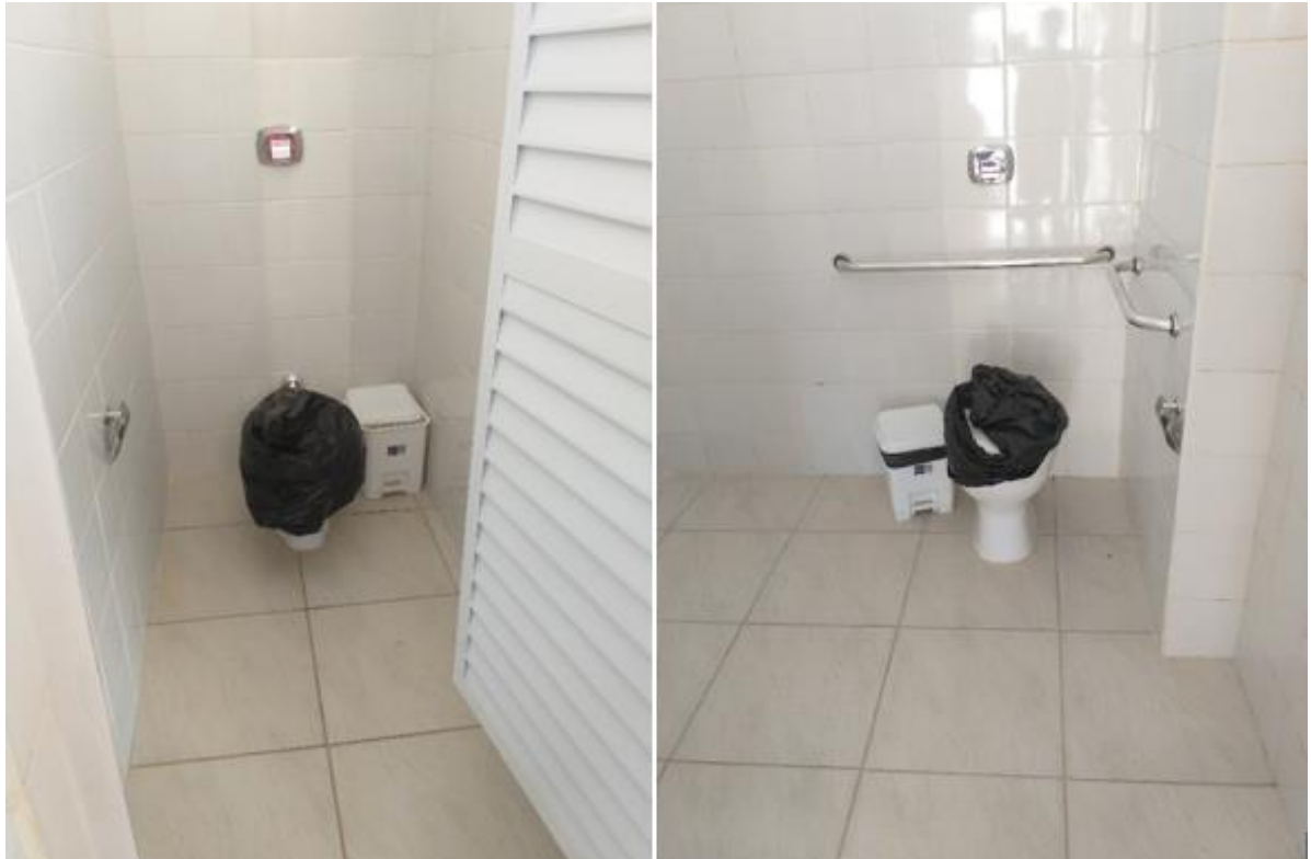
Figura 78: Vasos sanitários entupidos. (Fonte: Dos Autores 2019)
