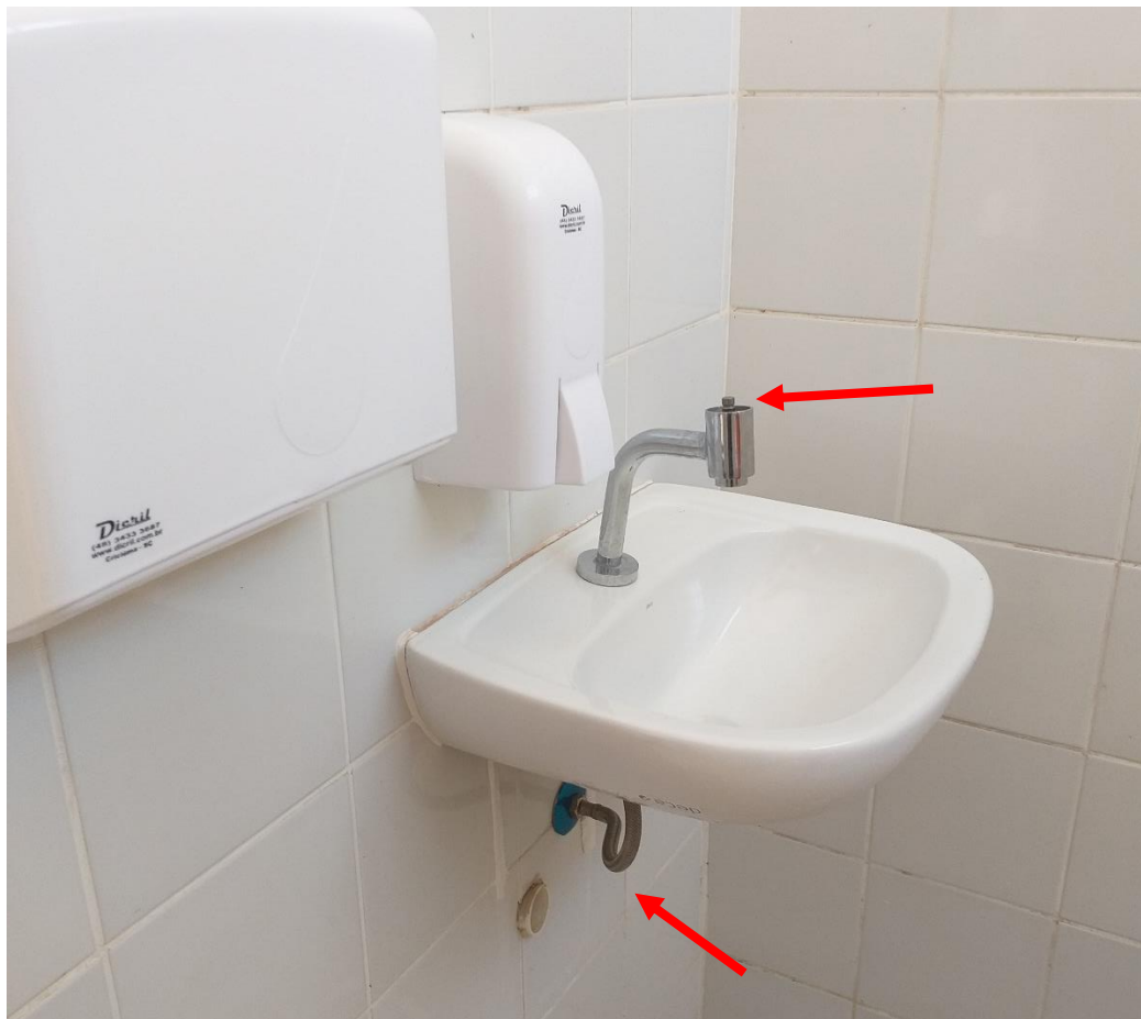
Figura 79: Pia e torneira do box para deficientes danificadas. (Fonte: Dos Autores 2019)
