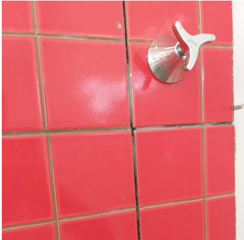
Figura 76: Problemas no rejunte. (Fonte: Dos Autores 2019)
