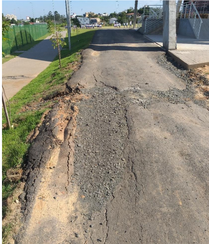
Figura 52: Pavimentação danificada. (Fonte: Dos Autores 2019)
