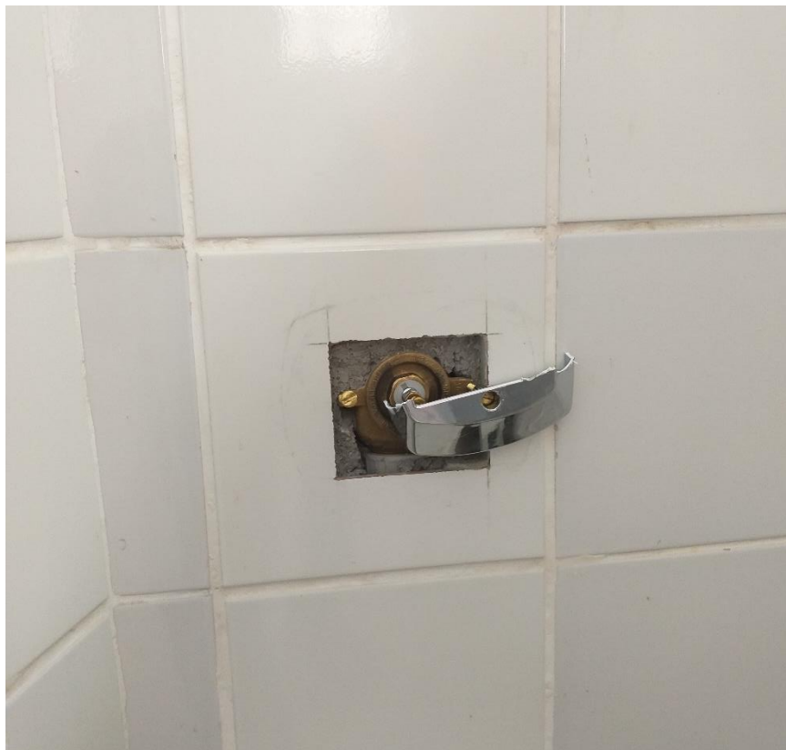
Figura 77: Acabamento da válvula de descarga danificado. (Fonte: Dos Autores 2019).
