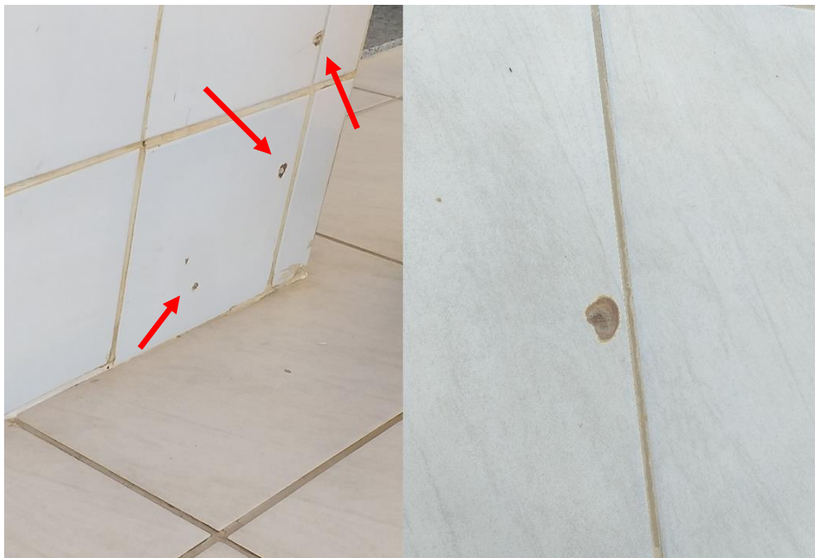
Figura 71: Pisos e azulejos danificados. (Fonte: Dos Autores 2019)
