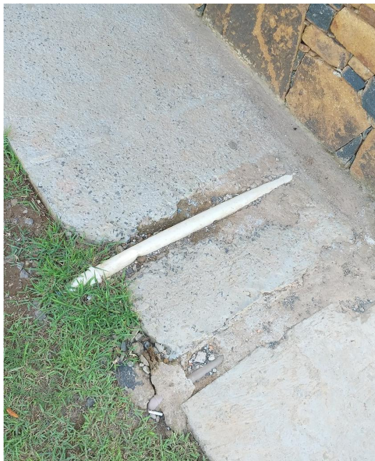
Figura 32: Tubulações expostas nos calçamentos. (Fonte: Dos Autores 2019)
