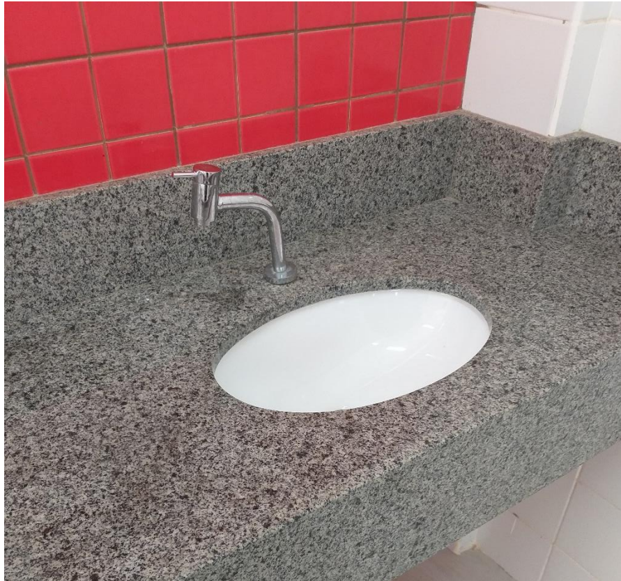
Figura 74: Torneira solta. (Fonte: Dos Autores 2019)
