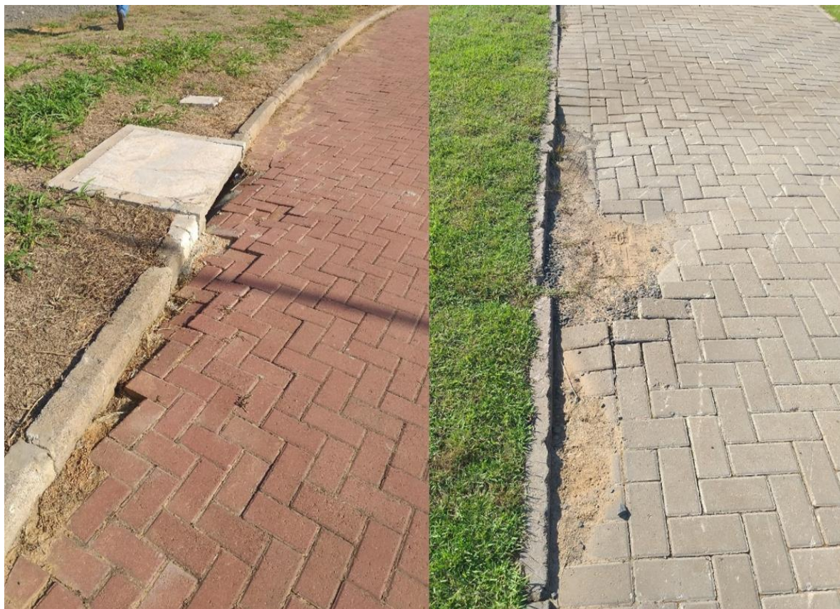
Figura 50: Desnívelamento dos pavers. (Fonte: Dos Autores 2019)
