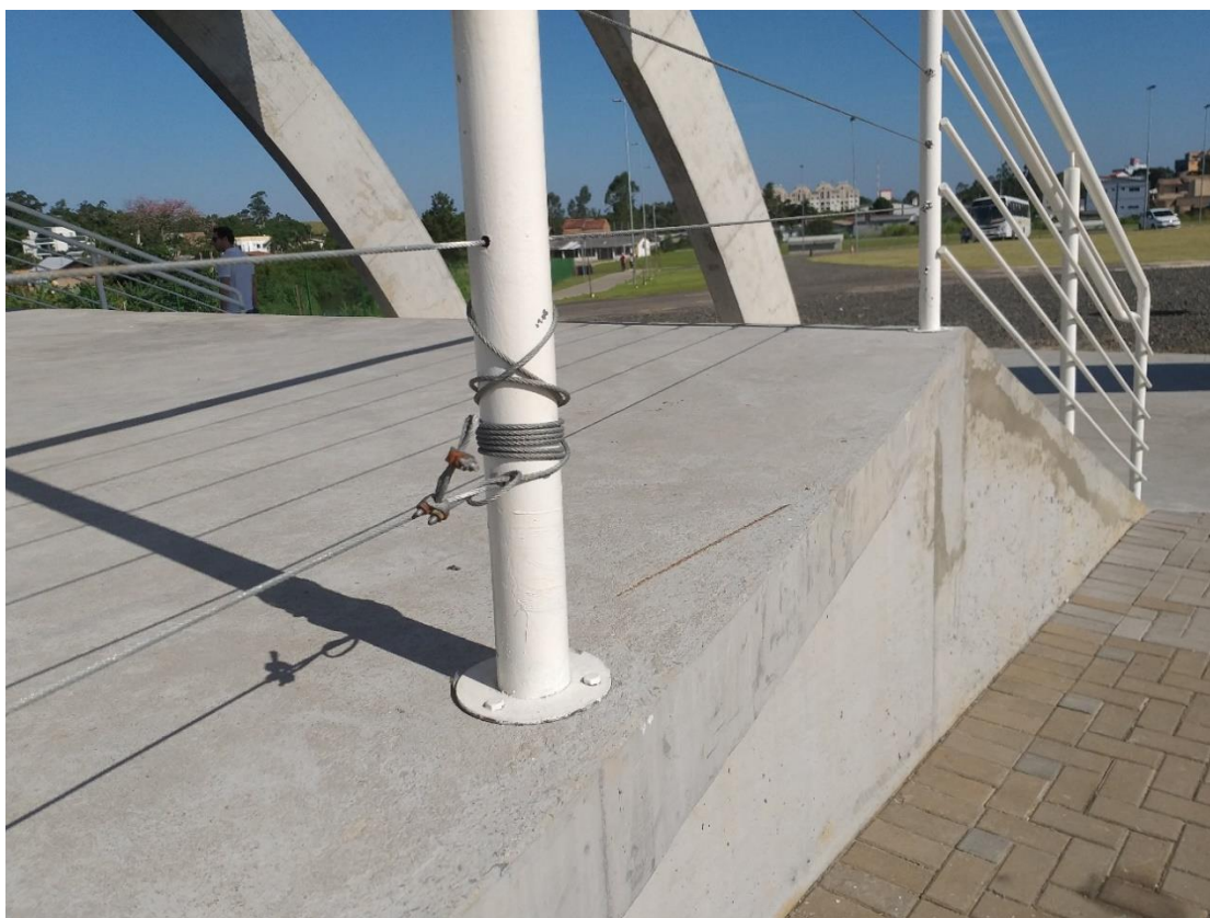
Figura 17: Fio de aço rompido. (Fonte: Dos Autores 2019)
