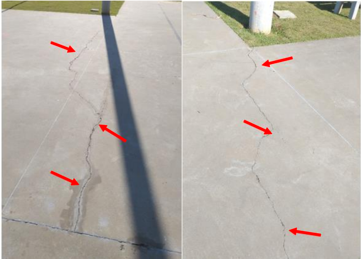
Figura 45: Fissuras na quadra poliesportiva. (Fonte: Dos Autores 2019)
