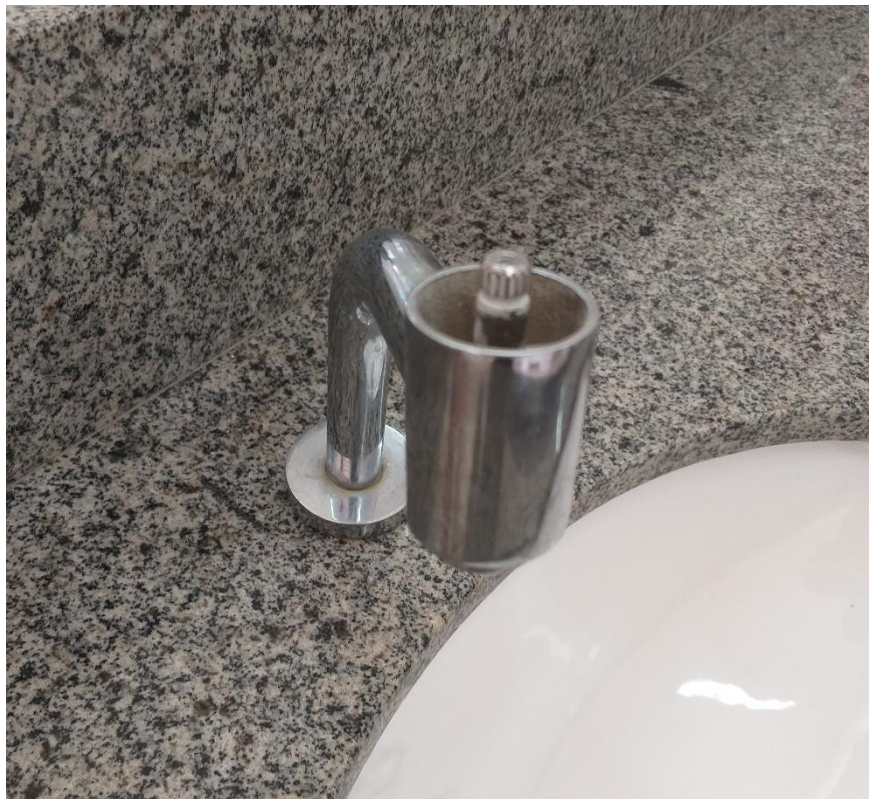
Figura 75: Torneira danificada. (Fonte: Dos Autores 2019)
