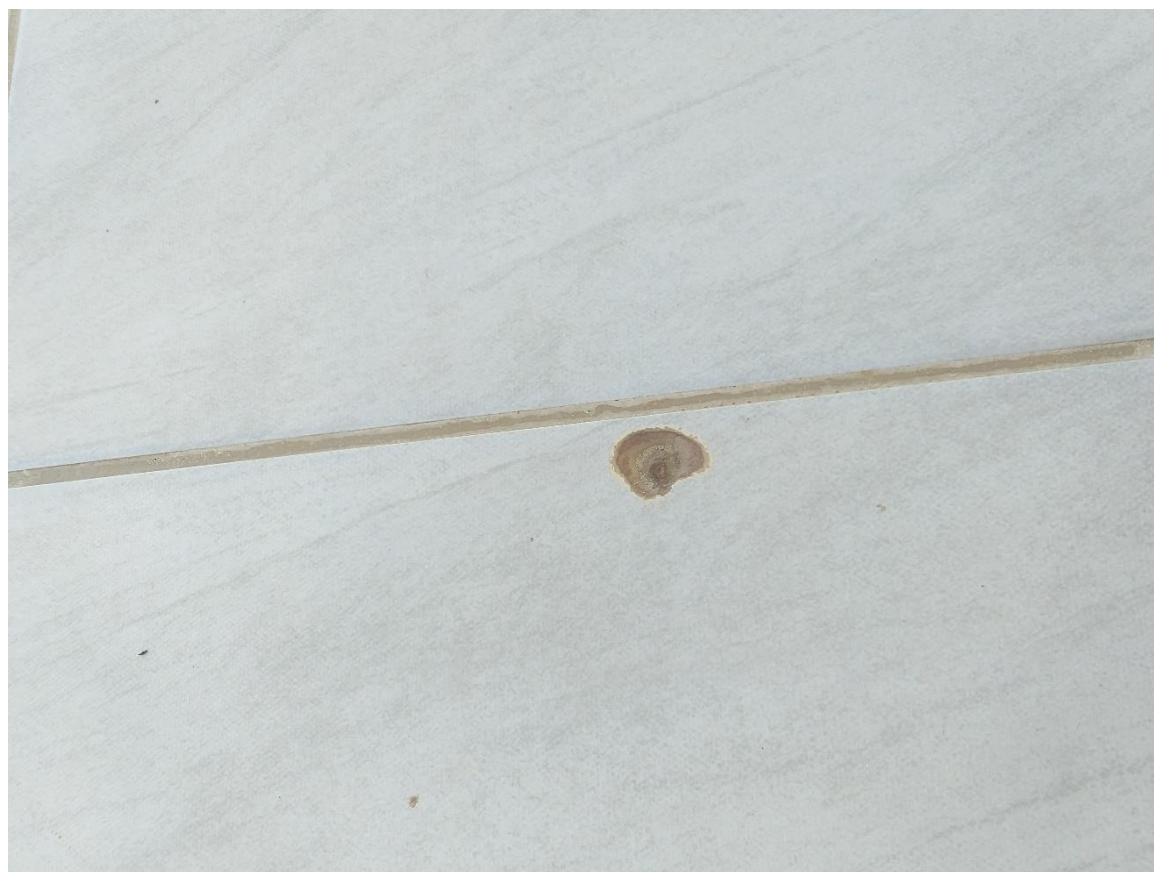
Figura 72: Pisos danificados. (Fonte: Dos Autores 2019)
