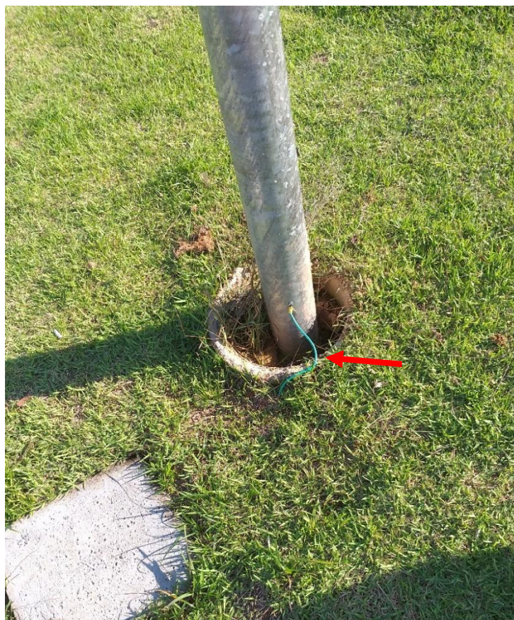
Figura 60: Fio exposto. (Fonte: Dos Autores 2019)
