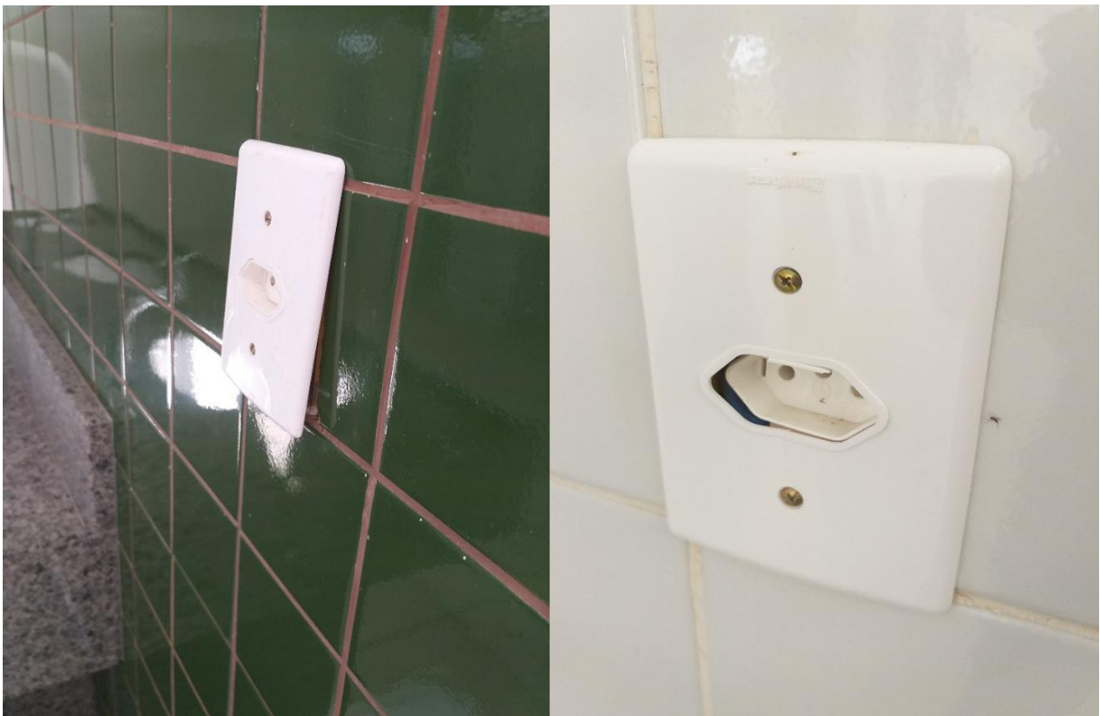
Figura 81: Tomadas danificadas. (Fonte: Dos Autores 2019)
