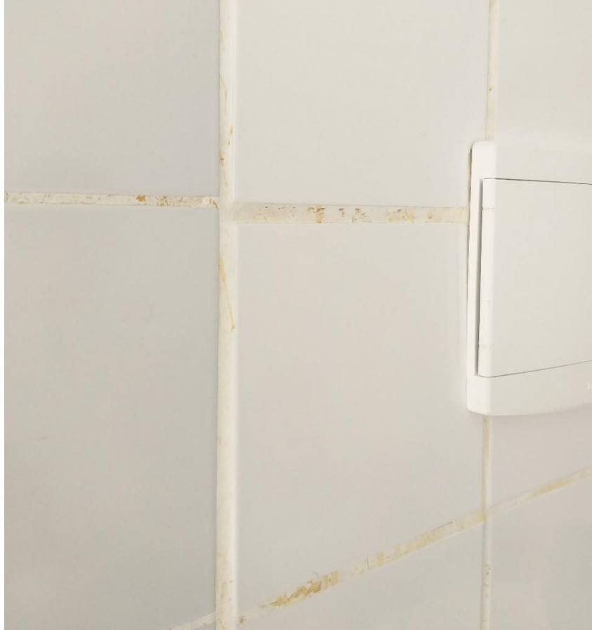
Figura 69: Desnível e excesso de rejunte nos azulejos. (Fonte: Dos Autores 2019)
