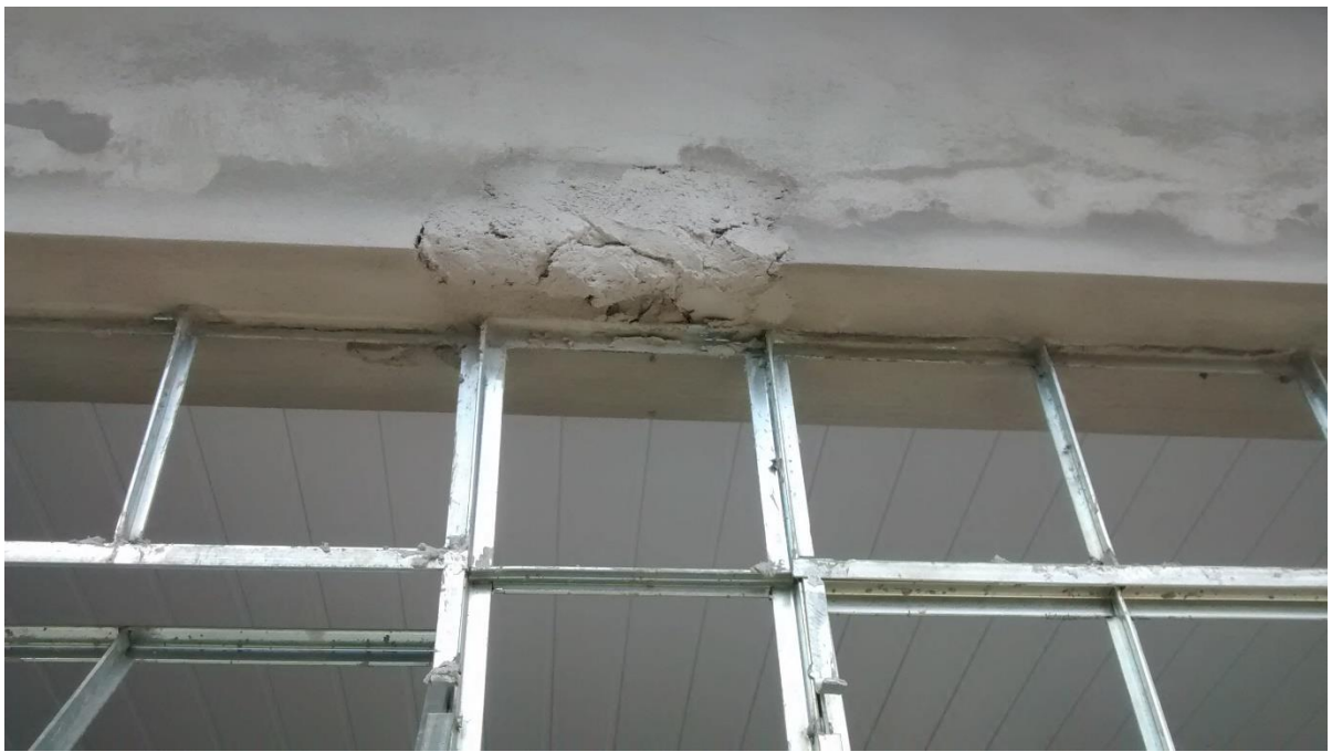
Figura 19: Falta de acabamento em reparo realizado. (Fonte: Dos autores 2015)
