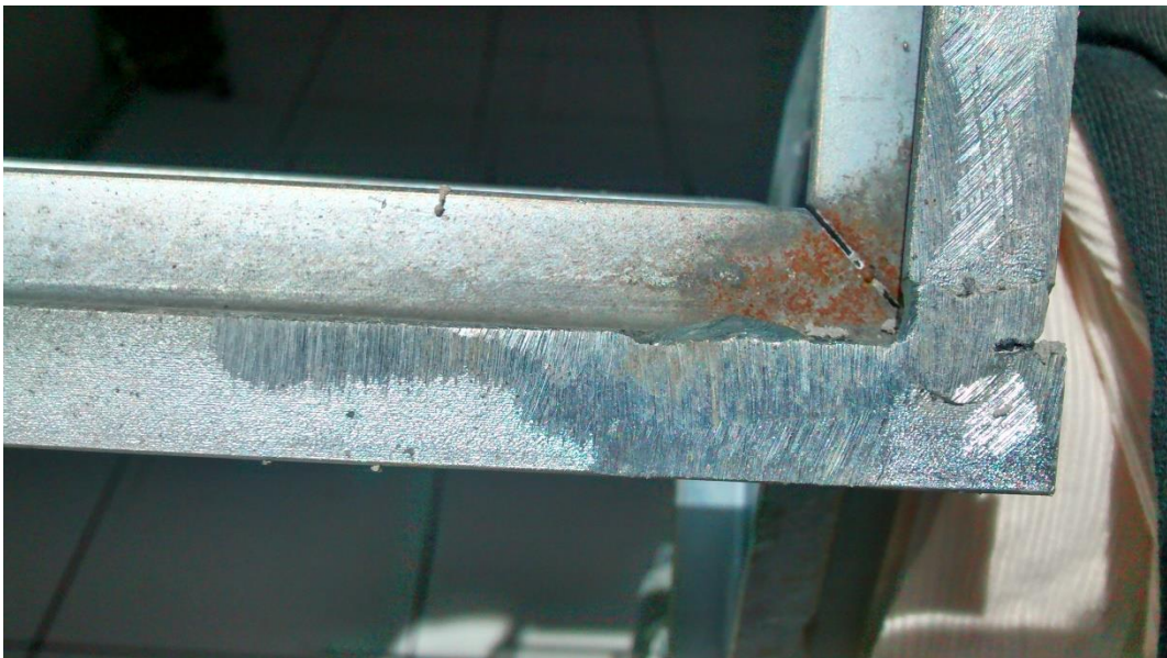
Figura 15: Esquadria apresentando um acabamento de má qualidade. (Fonte: Dos autores 2015)
