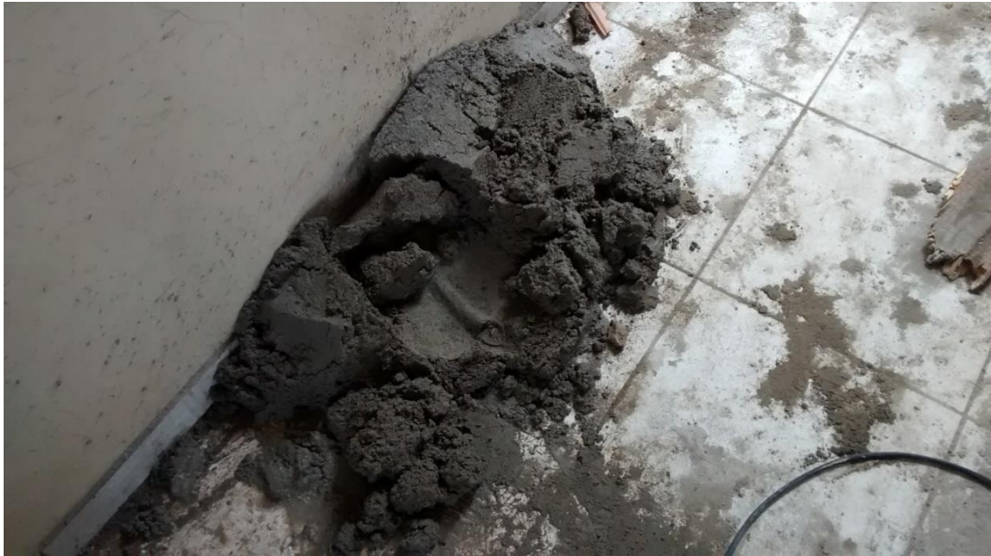
Figura 18: Resíduos da construção deixados no chão. (Fonte: Dos autores 2015)
