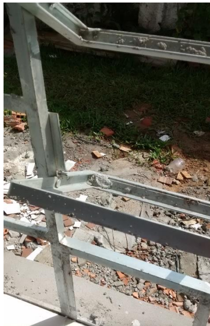
Figura 29: Resíduos na esquadria. (Fonte: Dos autores 2015)
