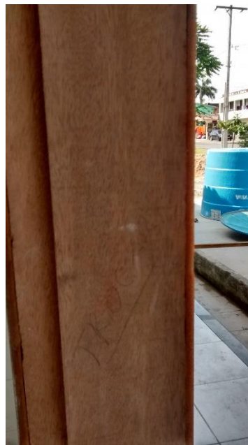
Figura 26: Indicação de troca do marco danificado. (Fonte: Dos autores 2015)
