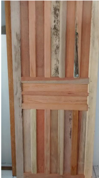
Figura 23: Porta apresentando problemas com fungos. (Fonte: Dos autores 2015)
