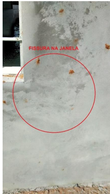
Figura 18: Fissura em uma das janelas. (Fonte: Dos autores 2015)
