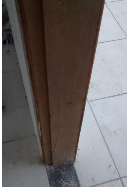
Figura 25: Marco da porta trincado. (Fonte: Dos autores 2015)
