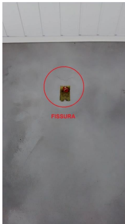
Figura 19: Fissura em uma das paredes. (Fonte: Dos autores 2015)
