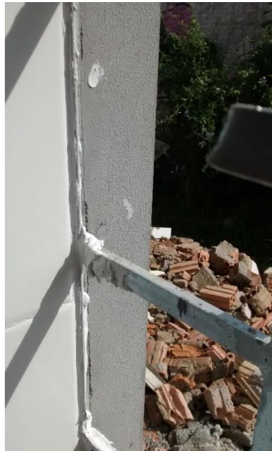
Figura 28: Resíduos na esquadria. (Fonte: Dos autores 2015)
