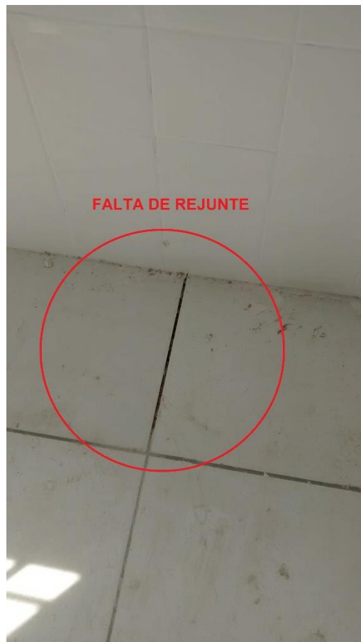
Figura 22: Falta de rejunte em um dos pisos. (Fonte: Dos autores 2015)
