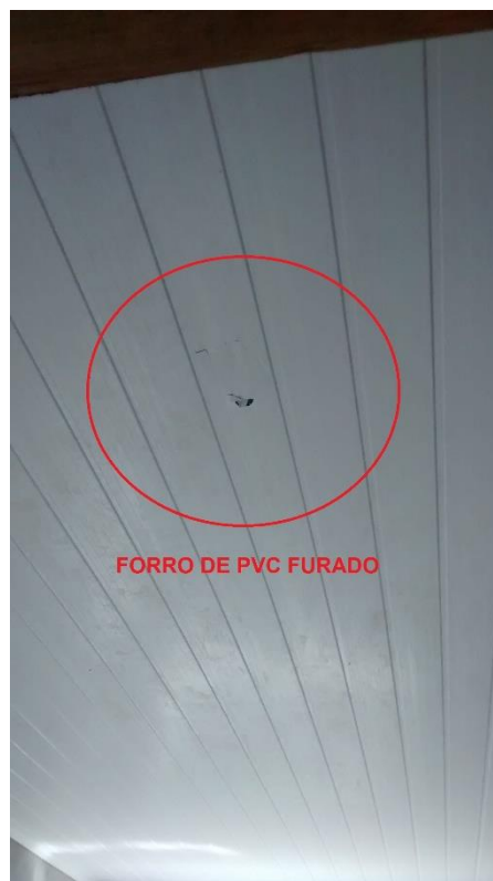
Figura 21: Forro de PVC danificado. (Fonte: Dos autores 2015)
