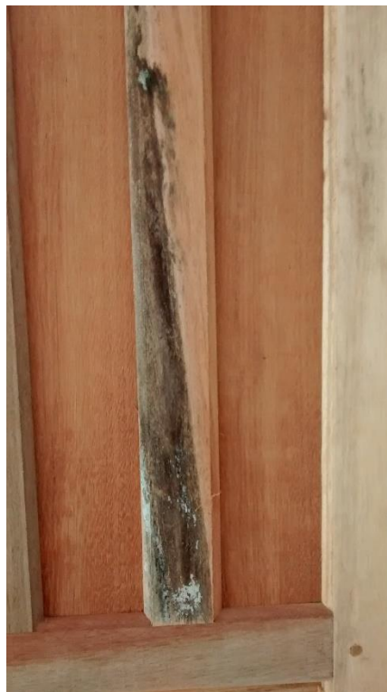
Figura 24: Detalhe porta apresentando problemas com fungos. (Fonte: Dos autores 2015)
