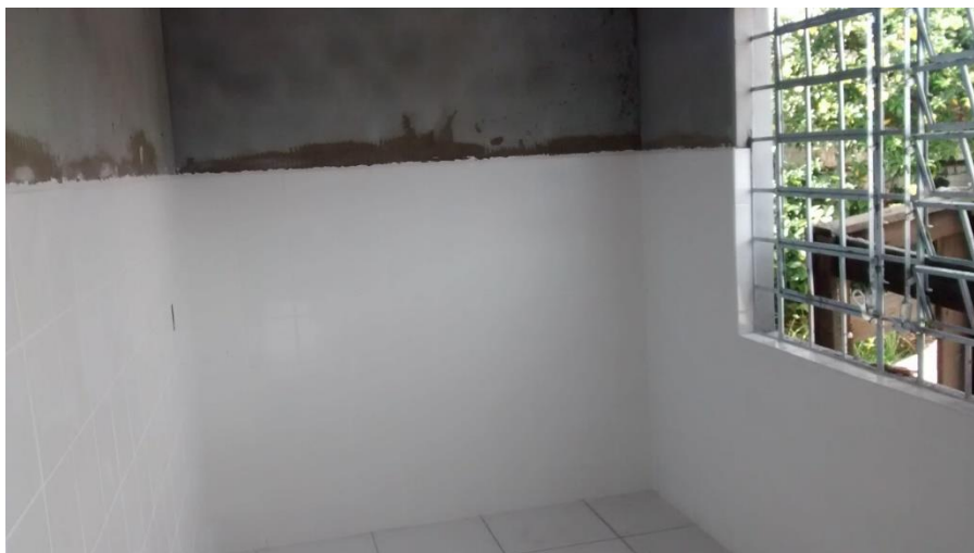
Figura 08: Revestimento cerâmico depósito. (Fonte: Dos autores 2015)
