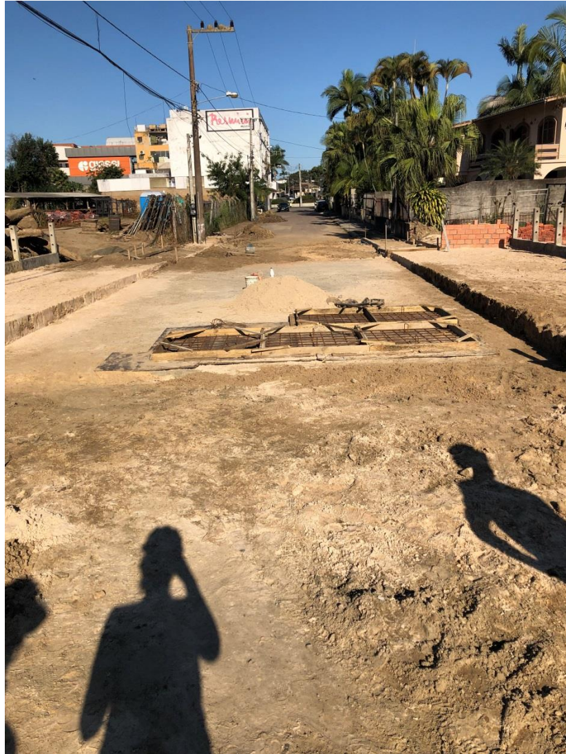
Figura 12: Calçadas em construção e pista coberta de areia ainda sem pavimentação. (Fonte: Dos Autores 2019)
