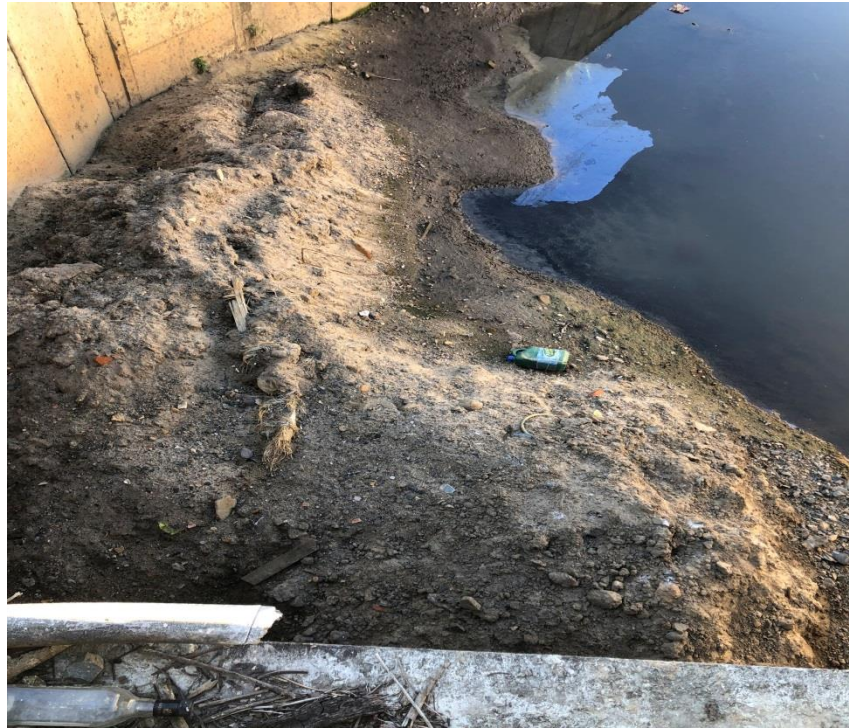
Figura 10: Acúmulo de terra no leito do rio e canal auxiliar. (Fonte: Dos Autores 2019)
