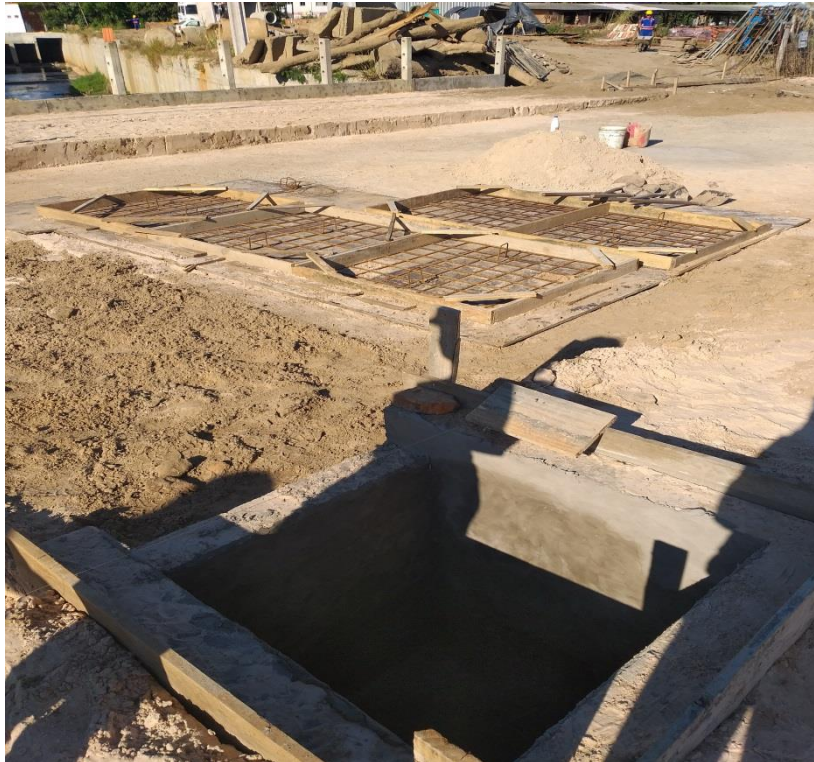
Figura 7: Caixa de passagem sem proteção. (Fonte: Dos Autores 2019)
