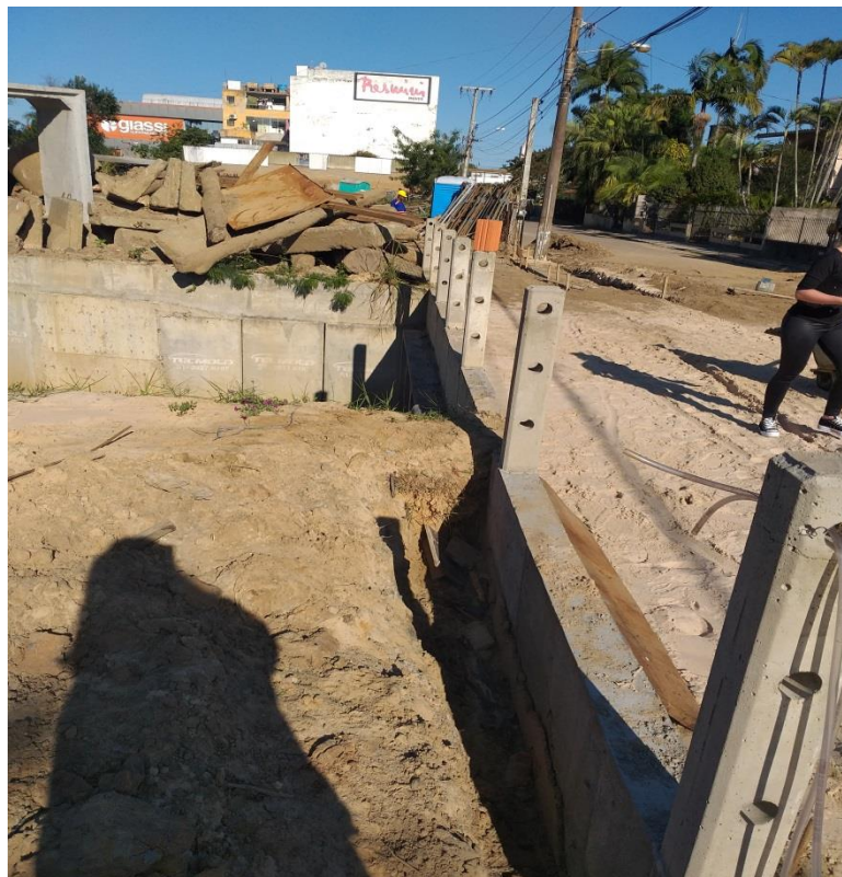
Figura 8: Grande quantidade de material acumulado na beira do canal auxiliar. (Fonte: Dos Autores 2019)
