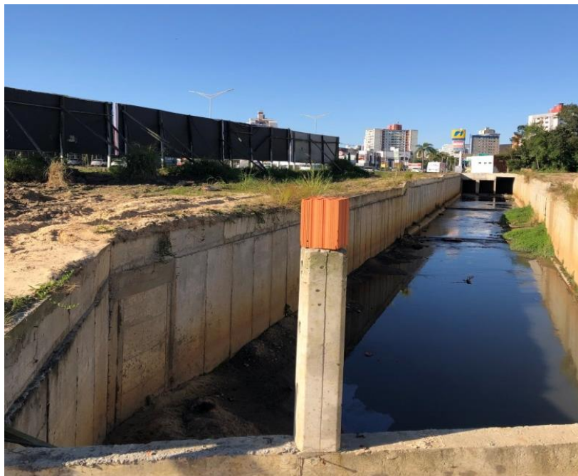
Figura 6: Canal sem muro de proteção (Fonte: Dos Autores 2019)
