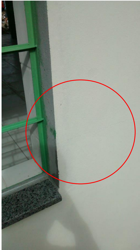
Figura 21: Fissura próxima a uma esquadria. (Fonte: Dos autores 2016)
