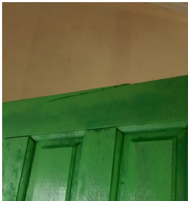
Figura 35: Porta danificada. (Fonte: Dos autores 2016)
