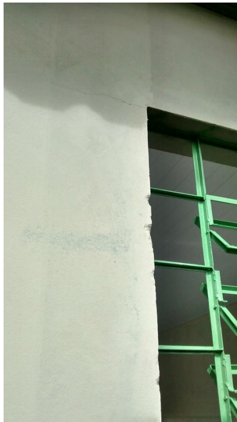
Figura 20: Fissura próxima a uma esquadria e parede danificada. (Fonte: Dos autores 2016)
