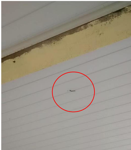
Figura 38: Forro de PVC danificado por prego. (Fonte: Dos autores 2016)
