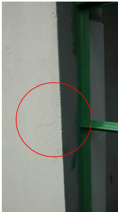
Figura 18: Fissura próxima a uma esquadria. (Fonte: Dos autores 2016)
