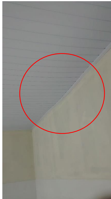
Figura 40: Forro de PVC danificado por ação de vândalos. (Fonte: Dos autores 2016)
