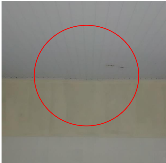
Figura 39: Forro de PVC danificado por ação de vândalos. (Fonte: Dos autores 2016)
