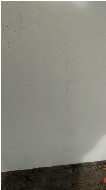
Figura 23: Fissura em uma das paredes. (Fonte: Dos autores 2016)
