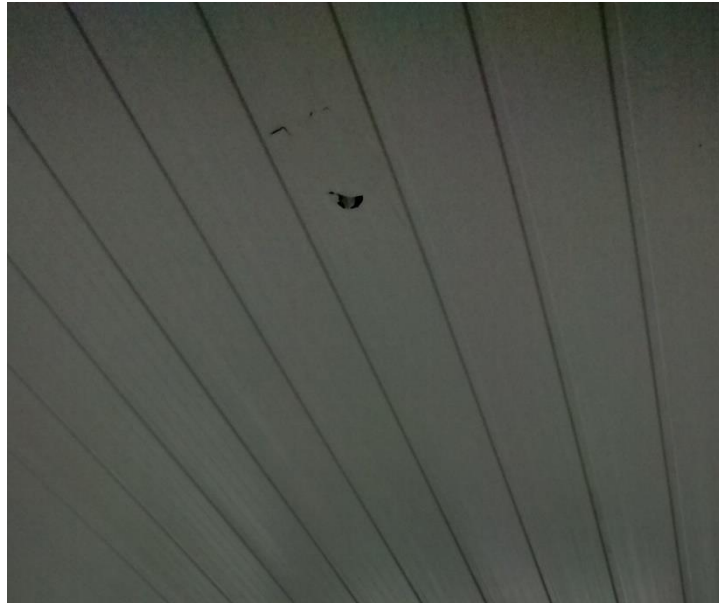
Figura 37: Forro de PVC danificado. (Fonte: Dos autores 2016)
