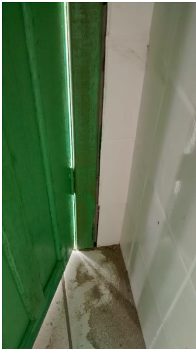
Figura 31: Retrabalho a ser realizado entre a vista e o revestimento. (Fonte: Dos autores 2016)
