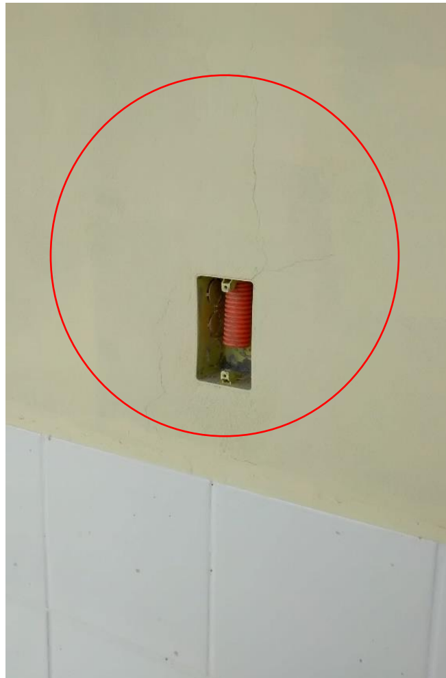
Figura 16: Fissura em uma das paredes. (Fonte: Dos autores 2016)
