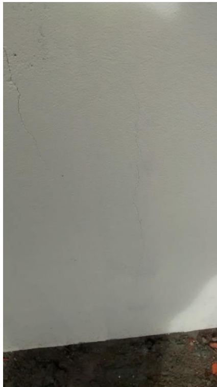
Figura 24: Fissura em uma das paredes. (Fonte: Dos autores 2016)
