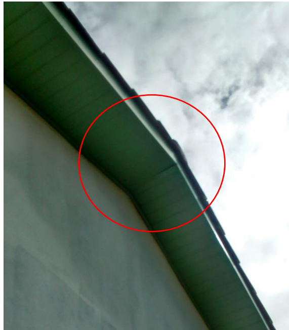
Figura 41: Peças do beiral mal colocadas. (Fonte: Dos autores 2016)
