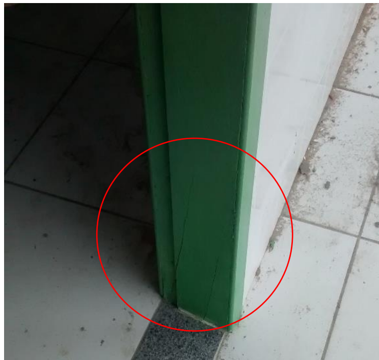
Figura 34: Porta danificada. (Fonte: Dos autores 2016)
