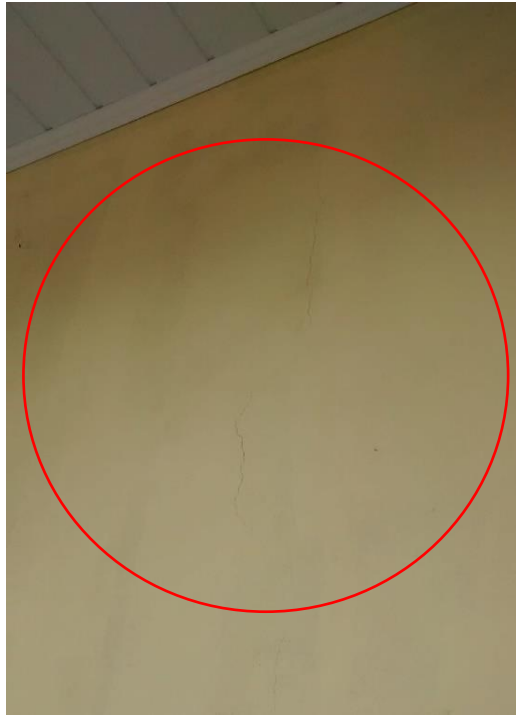
Figura 17: Fissura em uma das paredes. (Fonte: Dos autores 2016)
