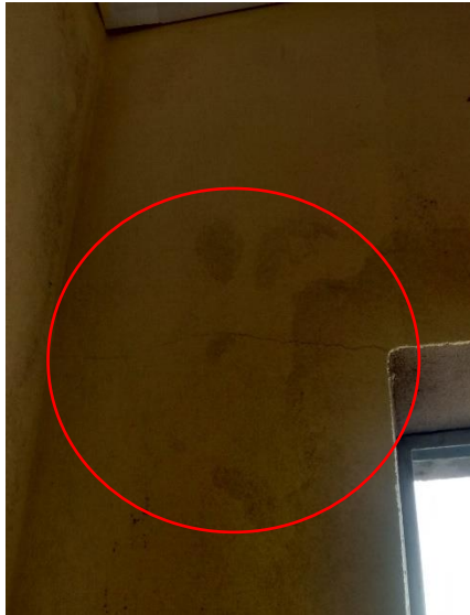
Figura 25: Fissura em uma das paredes. (Fonte: Dos autores 2016)
