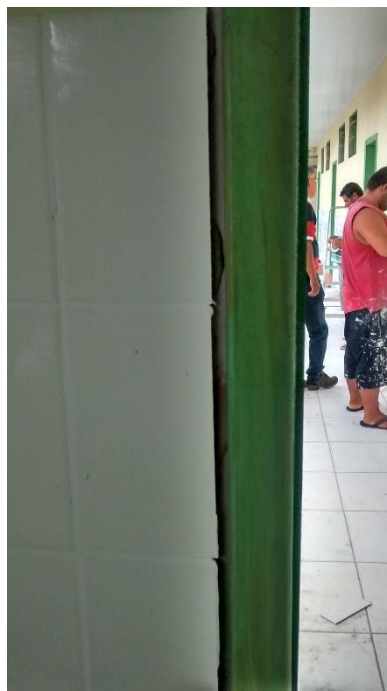
Figura 30: Retrabalho a ser realizado entre a vista e o revestimento. (Fonte: Dos autores 2016)
