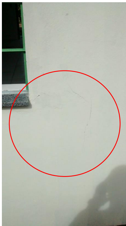
Figura 22: Fissura próxima a uma esquadria. (Fonte: Dos autores 2016)
