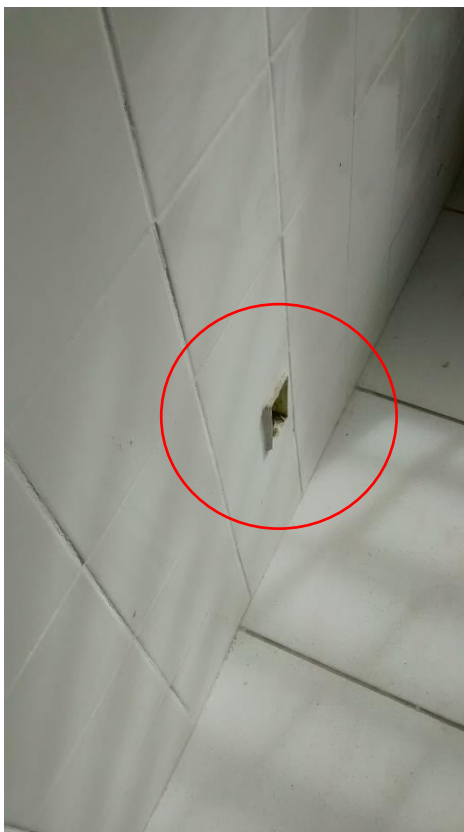
Figura 32: Retrabalho a ser realizado em uma das tomadas. (Fonte: Dos autores 2016)
