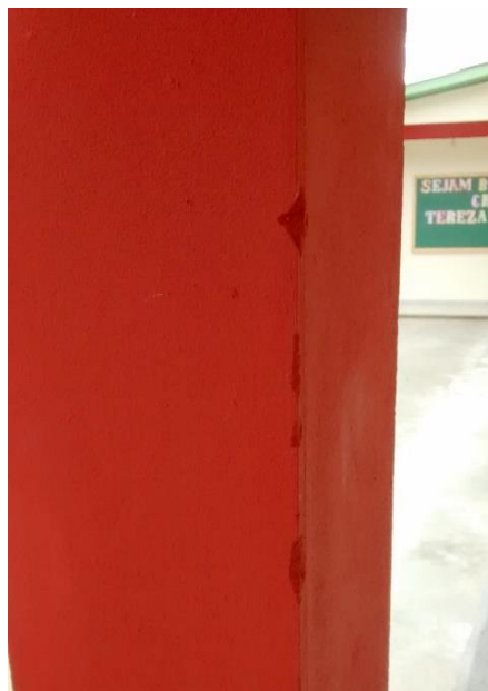
Figura 56: Pilar com canto danificado devido a execução da obra. (Fonte: Dos autores 2016)
