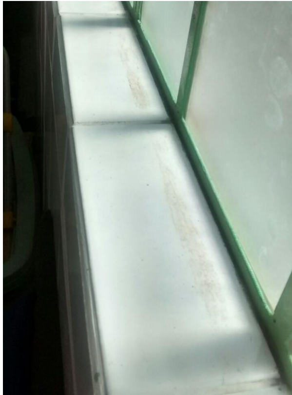
Figura 39: Falta de acabamento rejunte. (Fonte: Dos autores 2016)
