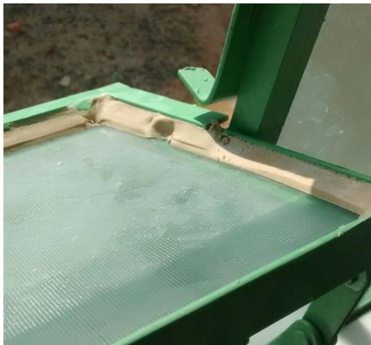
Figura 40: Falta de acabamento rejunte vidro. (Fonte: Dos autores 2016)
