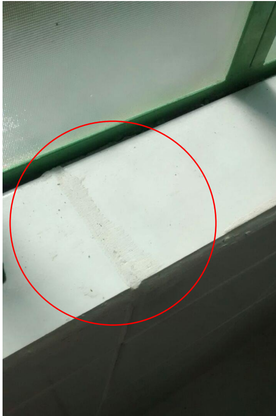
Figura 33: Falta de acabamento rejunte. (Fonte: Dos autores 2016)
