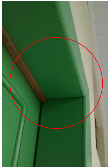
Figura 20: Porta danificada. (Fonte: Dos autores 2016)
