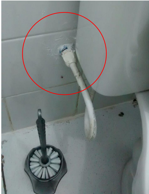
Figura 41: Falta de acabamento. (Fonte: Dos autores 2016)
