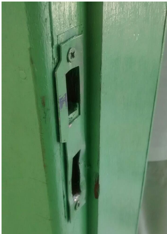
Figura 28: Fechadura amassada em uma das portas. (Fonte: Dos autores 2016)
