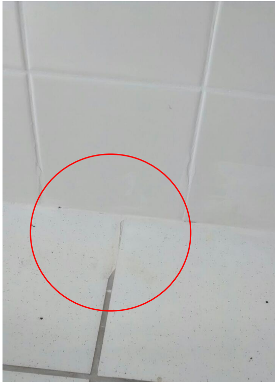
Figura 31: Falta de acabamento rejunte. (Fonte: Dos autores 2016)
