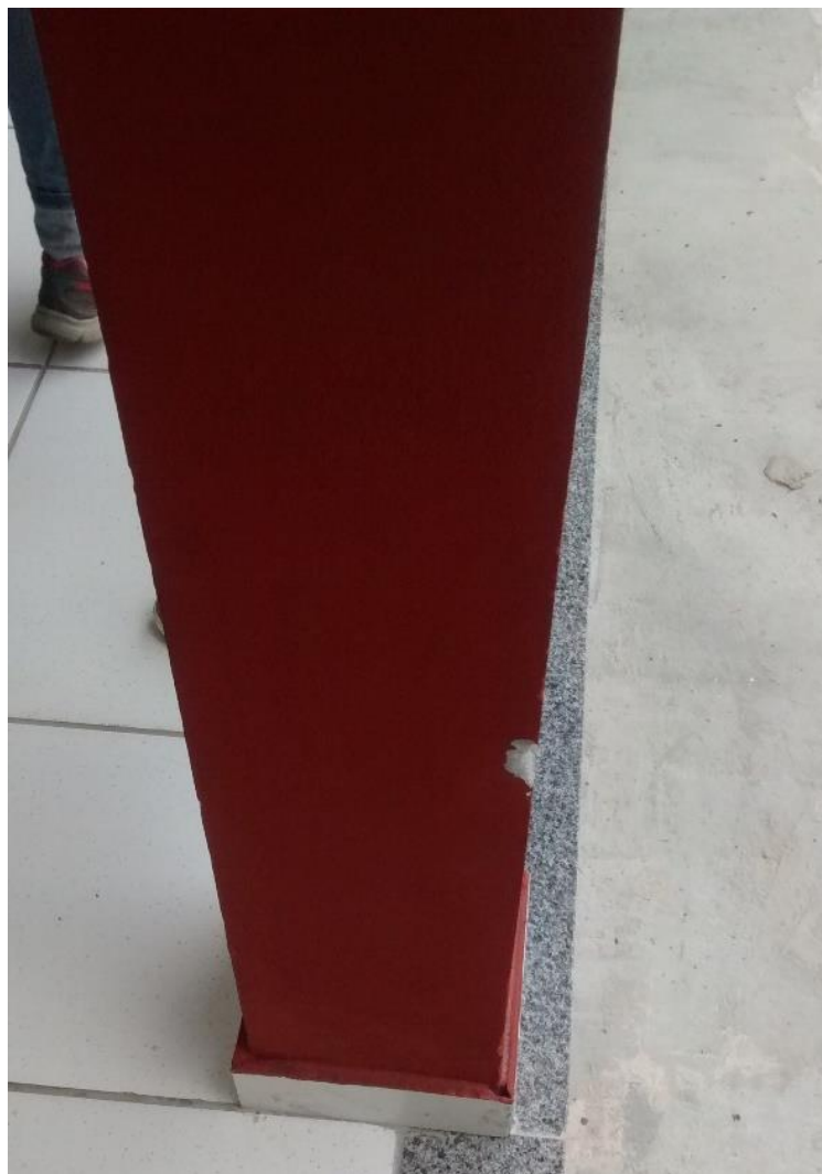
Figura 57: Pilar com canto danificado devido ao uso. (Fonte: Dos autores 2016)
