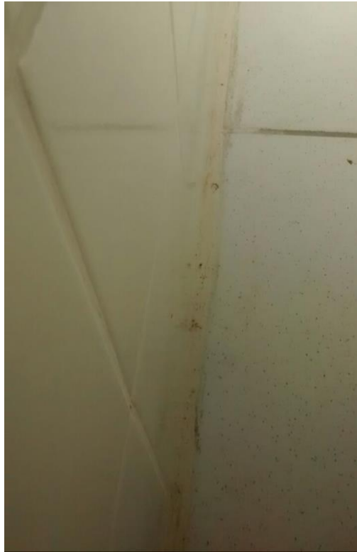
Figura 37: Falta de acabamento rejunte. (Fonte: Dos autores 2016)
