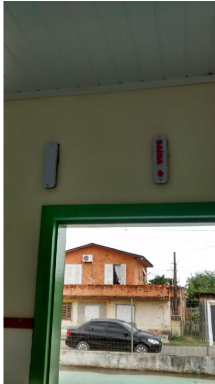
Figura 15: Sinalização de emergência. (Fonte: Dos autores 2016)
