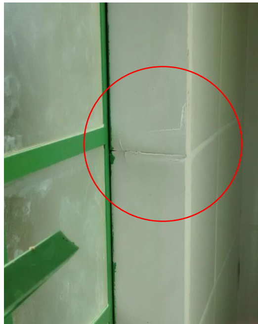
Figura 30: Falta de acabamento rejunte. (Fonte: Dos autores 2016)
