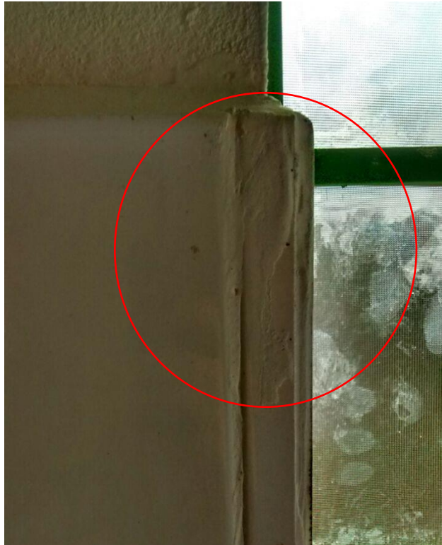
Figura 42: Falta de acabamento rejunte. (Fonte: Dos autores 2016)
