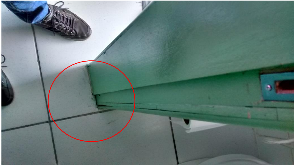
Figura 22: Vista da porta empenada. (Fonte: Dos autores 2016)
