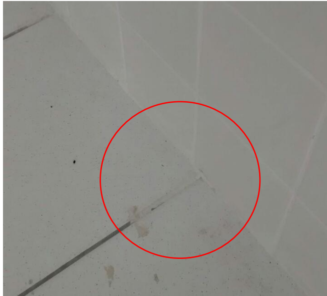
Figura 29: Falta de acabamento rejunte. (Fonte: Dos autores 2016)
