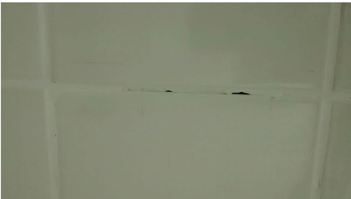
Figura 36: Falta de acabamento rejunte. (Fonte: Dos autores 2016)
