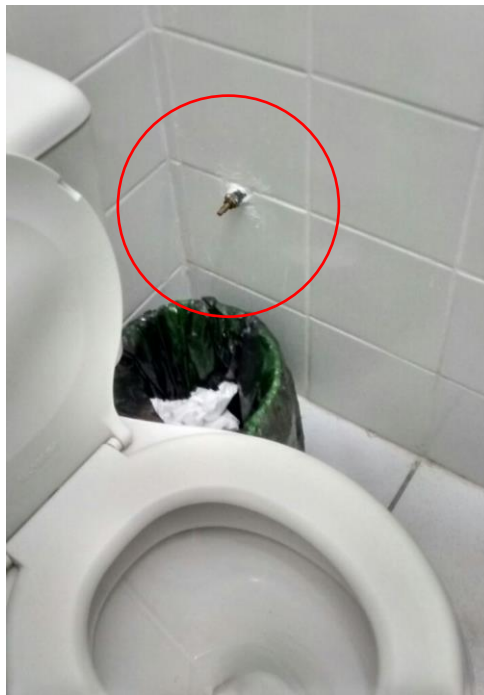
Figura 61: Falta da colocação da manopla no registro. (Fonte: Dos autores 2016)
