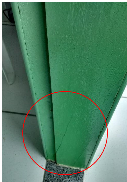
Figura 21: Porta danificada. (Fonte: Dos autores 2016)
