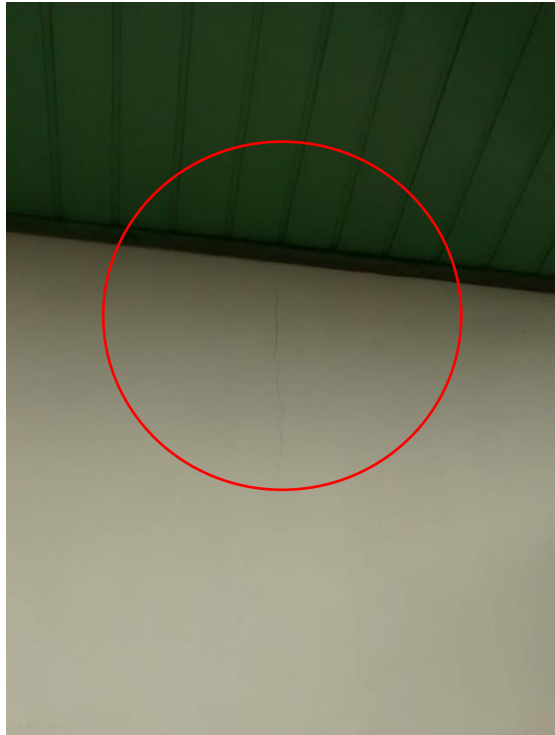
Figura 18: Fissura em um ponto do prédio. (Fonte: Dos autores 2016)
