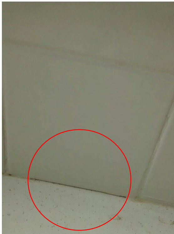
Figura 38: Falta de rejunte. (Fonte: Dos autores 2016)
