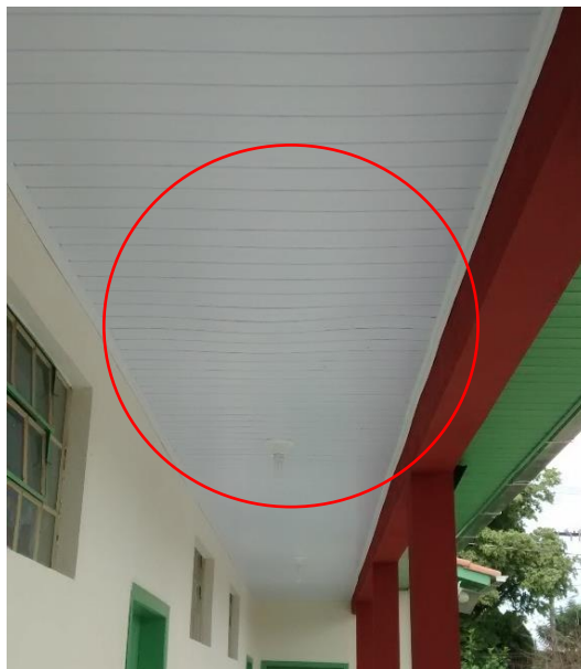
Figura 52: Forro de PVC danificado por ação de vândalos. (Fonte: Dos autores 2016)
