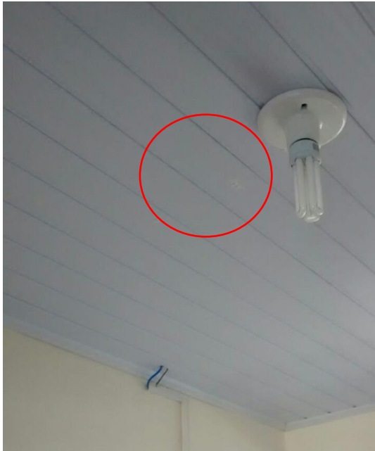
Figura 51: Forro de PVC danificado. (Fonte: Dos autores 2016)
