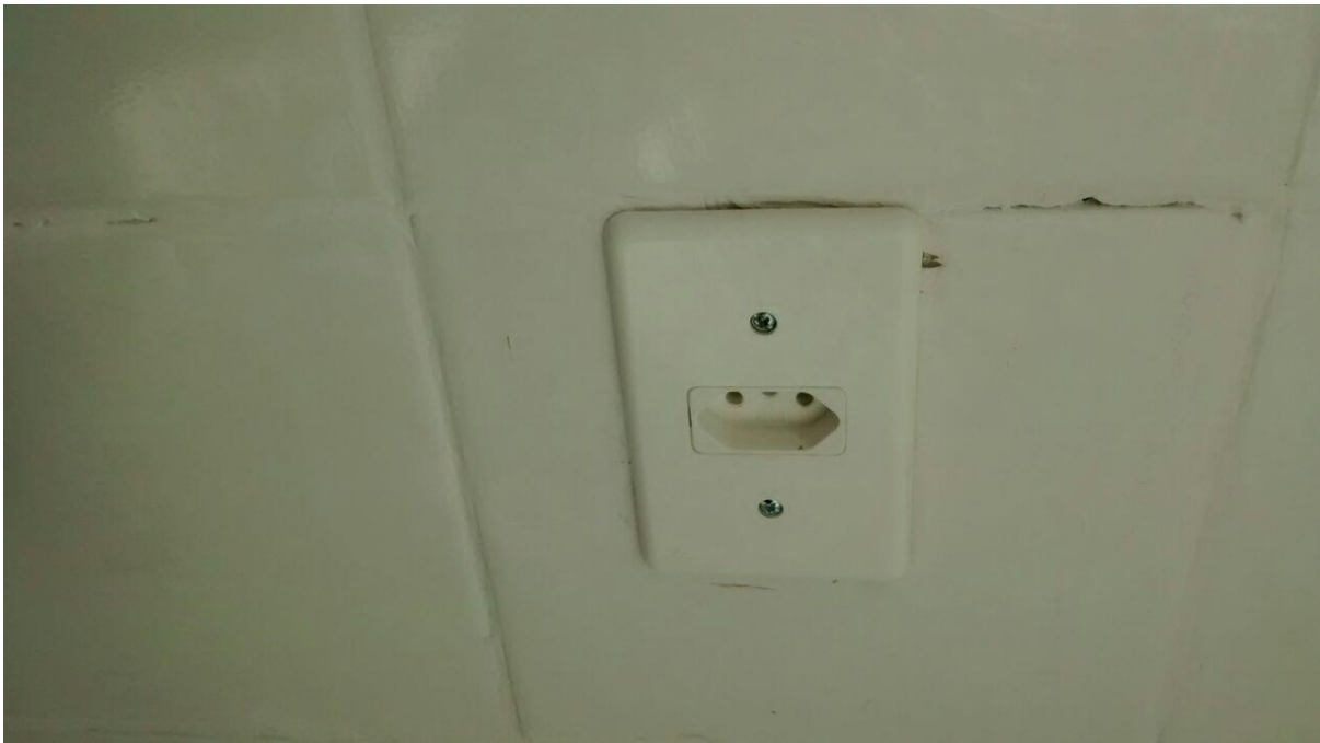
Figura 35: Falta de acabamento rejunte. (Fonte: Dos autores 2016)
