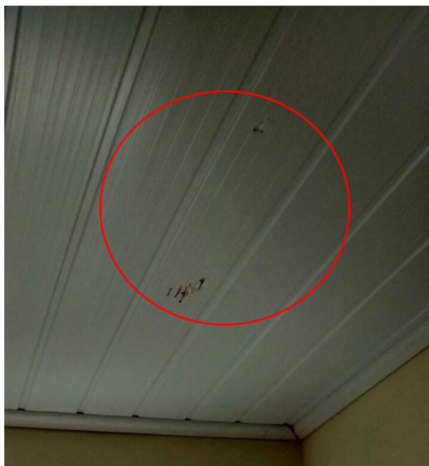
Figura 50: Forro de PVC danificado por ação de vândalos. (Fonte: Dos autores 2016)
