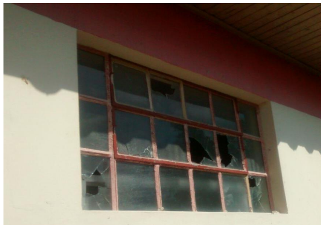
Figura 68: Janela prédio antigo danificada. (Fonte: Dos autores 2016)
