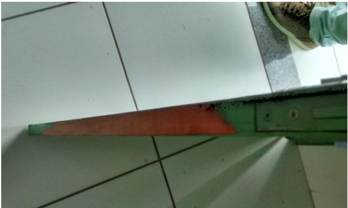
Figura 26: Porta com retrabalho realizado. (Fonte: Dos autores 2016)
