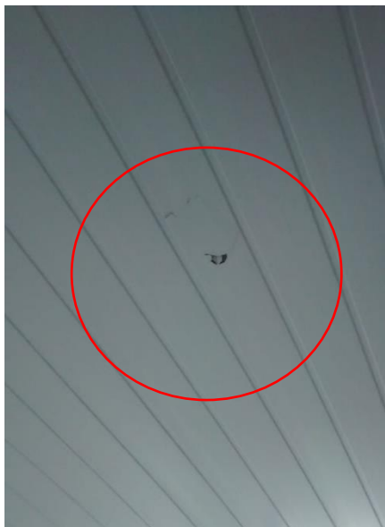
Figura 49: Forro de PVC danificado por ação de vândalos. (Fonte: Dos autores 2016)
