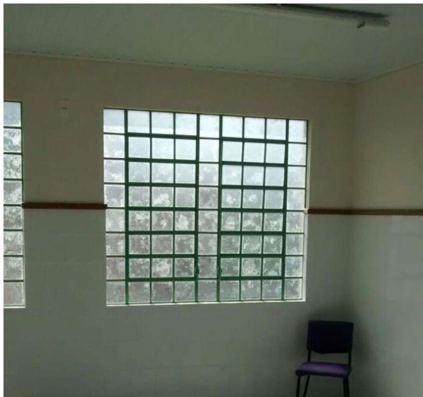
Figura 65: Janela sem limpeza. (Fonte: Dos autores 2016)
