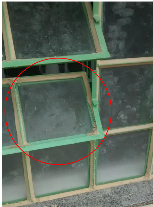
Figura 54: Rejunte dos vidros retirado por ação de vândalos. (Fonte: Dos autores 2016)
