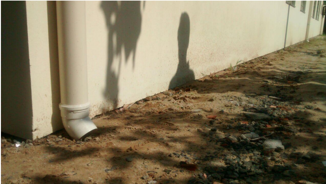
Figura 60: Escoamento das águas das chuvas no solo. (Fonte: Dos autores 2016)
