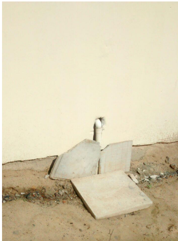
Figura 46: Falta de acabamento. (Fonte: Dos autores 2016)
