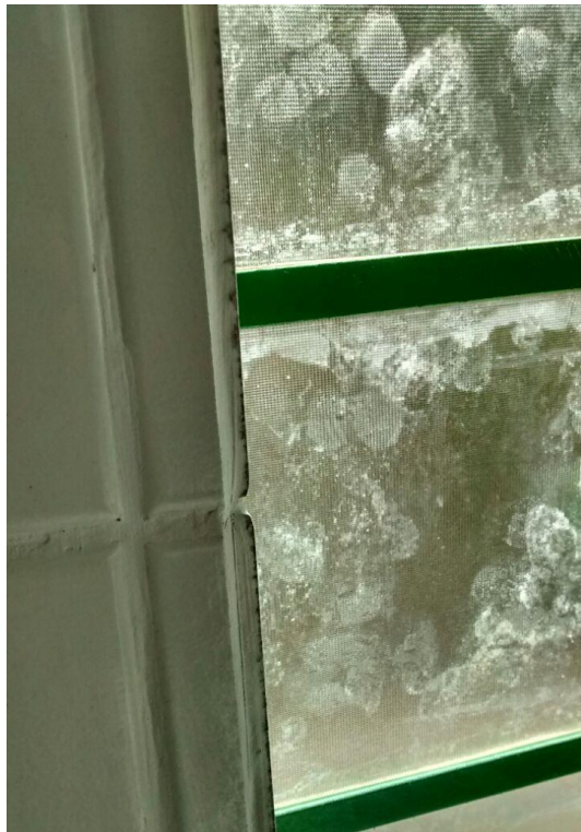
Figura 32: Falta de acabamento rejunte. (Fonte: Dos autores 2016)
