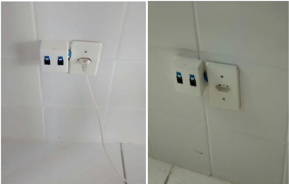
Figura 62: Tomadas rede lógica e elétrica. (Fonte: Dos autores 2016)
