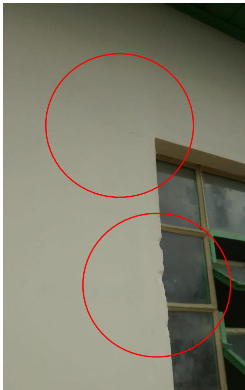
Figura 19: Fissura na janela e estrutura danificada. (Fonte: Dos autores 2016)
