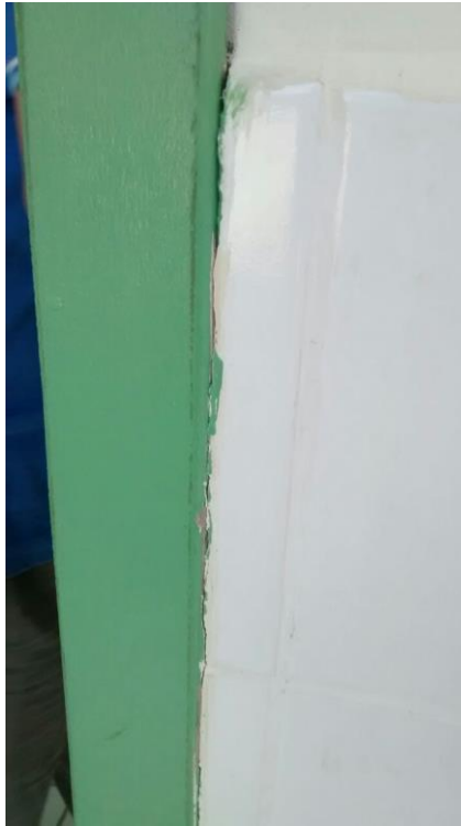
Figura 43: Falta de acabamento rejunte. (Fonte: Dos autores 2016)
