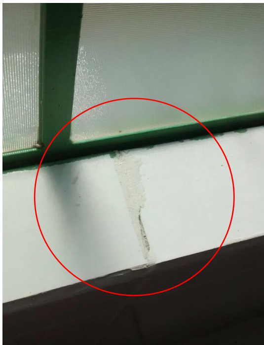
Figura 34: Falta de acabamento rejunte. (Fonte: Dos autores 2016)
