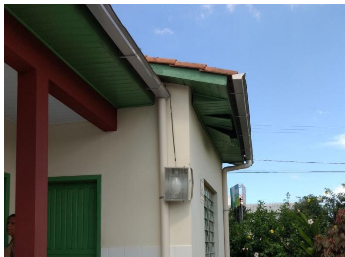
Figura 292: Deslocamento dos beirais de madeira. (Fonte: Dos Autores 2018)
