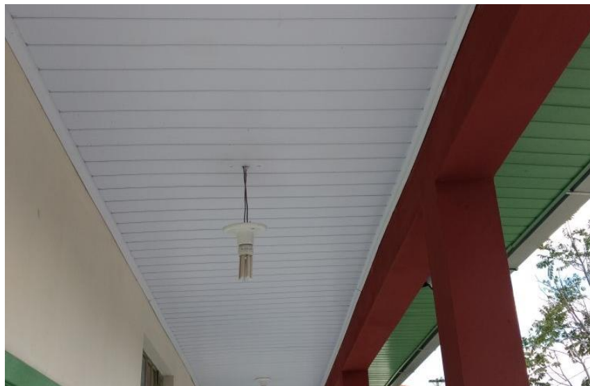
Figura 31: Lâmpada apresentando caimento devido à má instalação. (Fonte: Dos Autores 2018)
