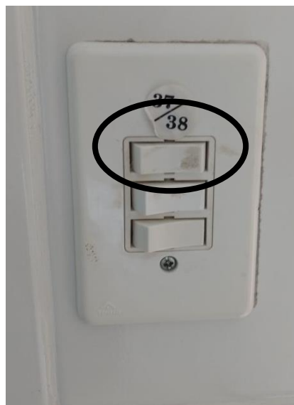
Figura 27: Interruptor estragado. (Fonte: Dos Autores 2018)
