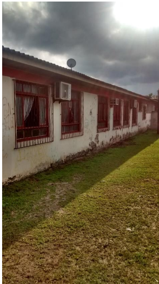
Figura 4: Infiltração nas paredes da região aos fundos do terreno. (Fonte: Dos autores 2015)
