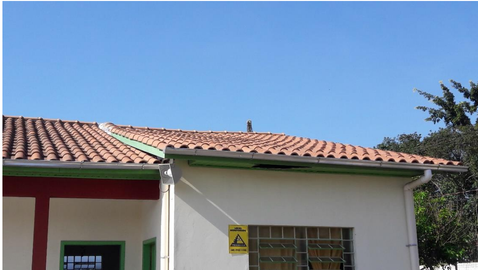
Figura 24: Abaulamento do telhado. (Fonte: Dos Autores).
