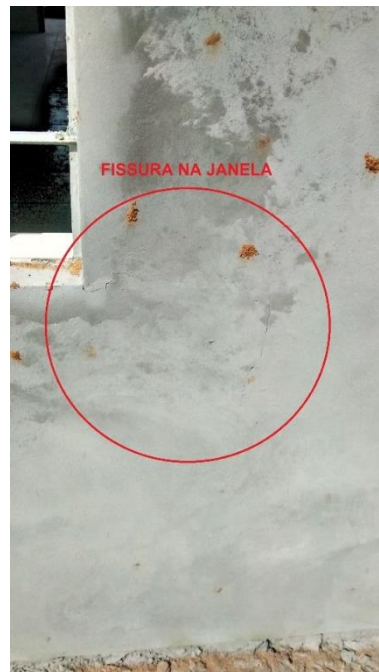
Figura 11: Fissura em uma das janelas. (Fonte: Dos autores 2015)
