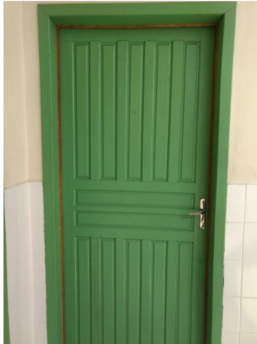
Figura 26: Porta com fechamento incorreto. (Fonte: Dos Autores 2018)
