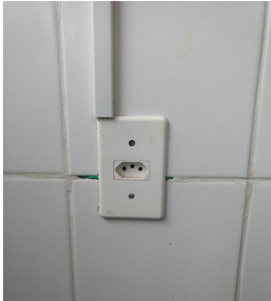
Figura 281: Falta de acabamento, fios aparecendo no rejunte. (Fonte: Dos Autores 2018)
