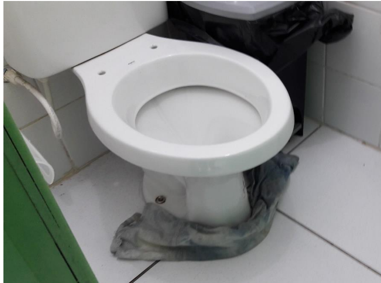
Figura 20: Banheiro com vazamento de água. (Fonte: Dos Autores).
