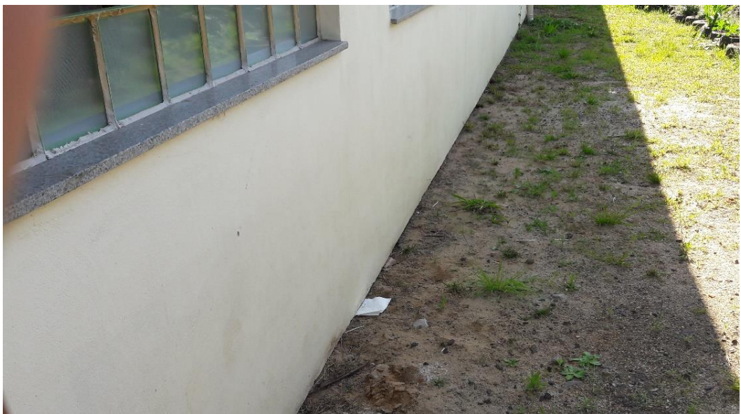
Figura 25: Reboco muito próximo do solo. (Fonte: Dos Autores).
