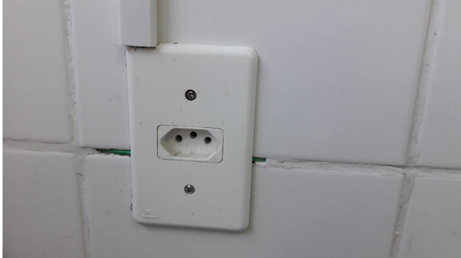
Figura 22: Falta de tubulação na fiação elétrica. (Fonte: Dos Autores).
