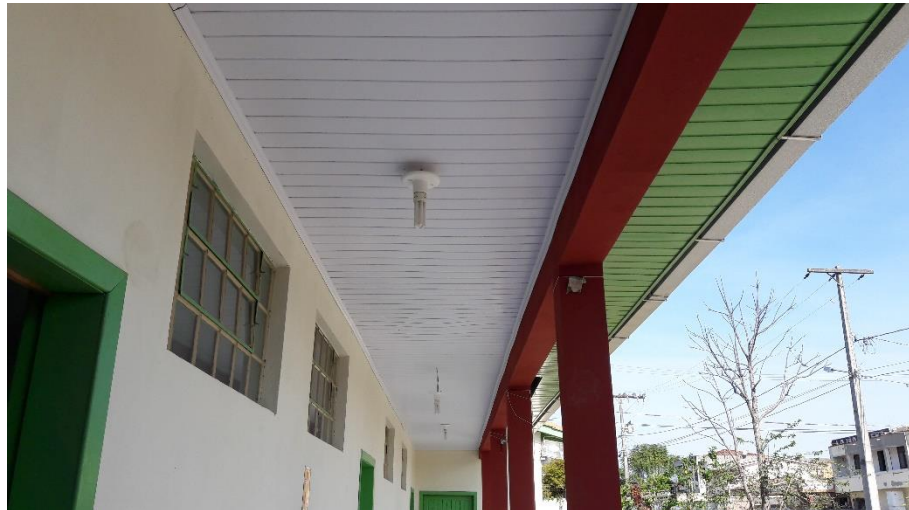
Figura 23: Forro de PVC empenado. (Fonte: Dos Autores).
