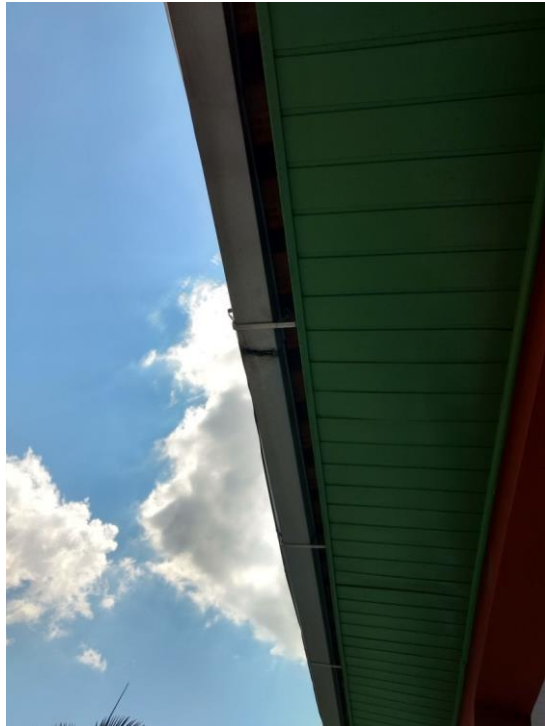
Figura 30: Problemas de goteira na calha. (Fonte: Dos Autores 2018)
