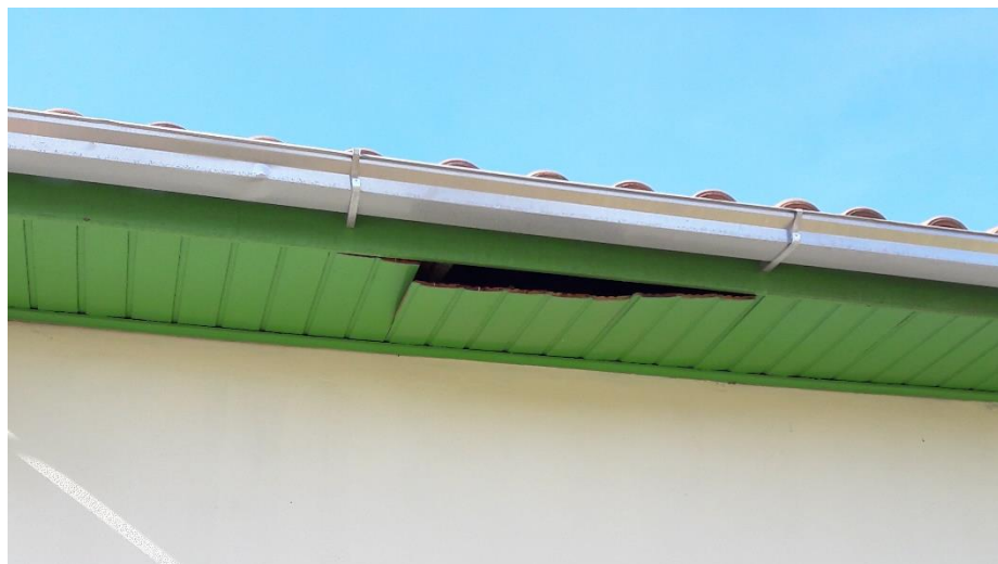
Figura 21: Deslocamento dos beirais de madeira. (Fonte: Dos Autores).
