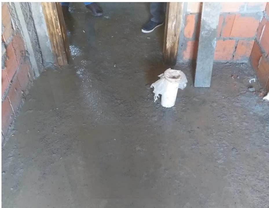
Figura 32: Encanamento para esgoto a frente da passagem da porta. (Fonte: Dos Autores 2019)
