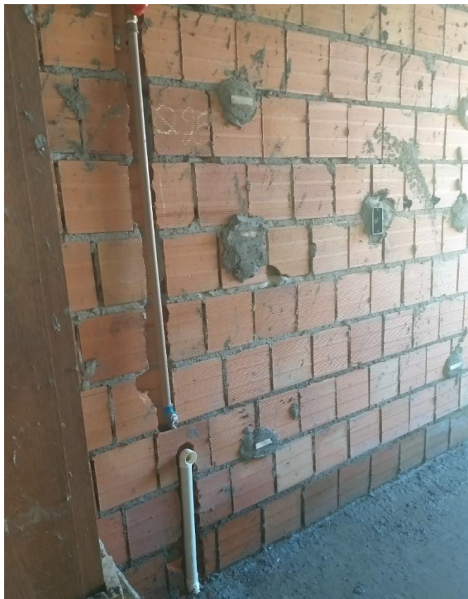
Figura 29: Instalações hidráulicas. (Fonte: Dos Autores 2019)
