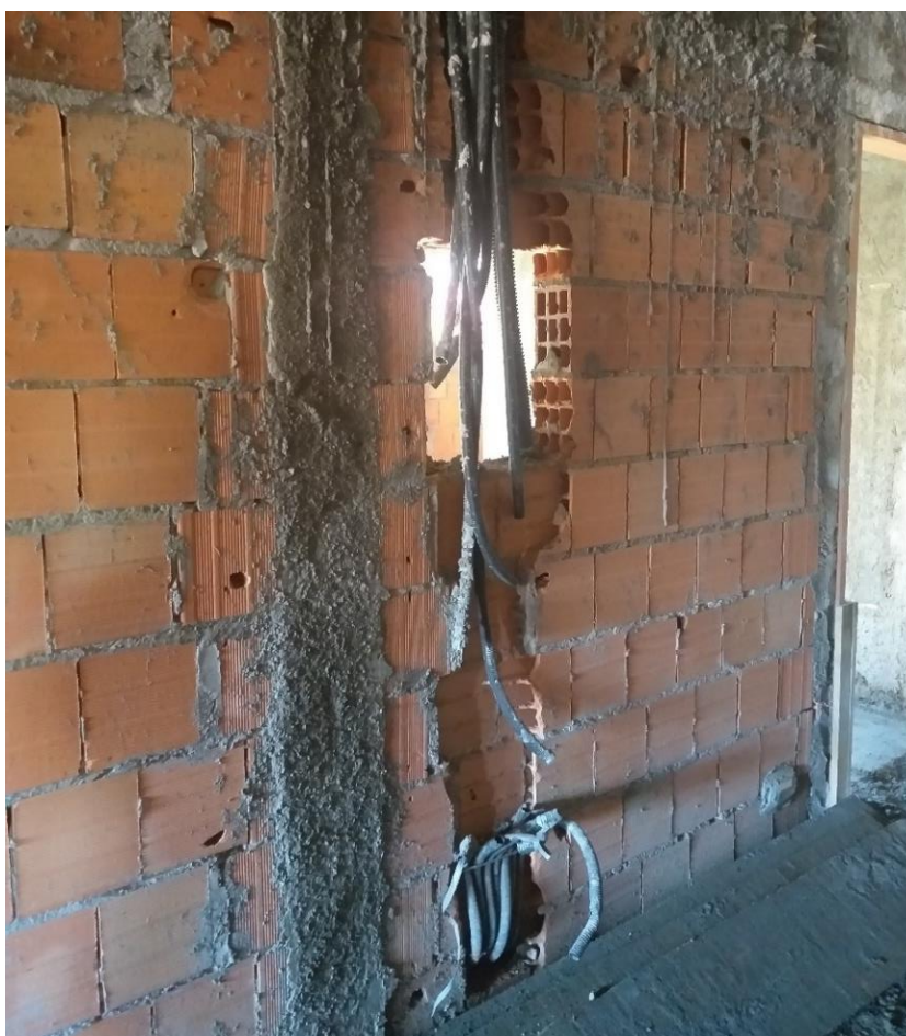
Figura 27: Eletrodutos. (Fonte: Dos Autores 2019)
