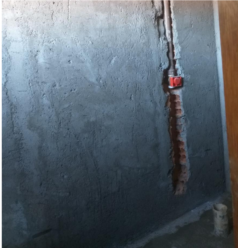
Figura 30: Instalações hidráulicas. (Fonte: Dos Autores 2019)
