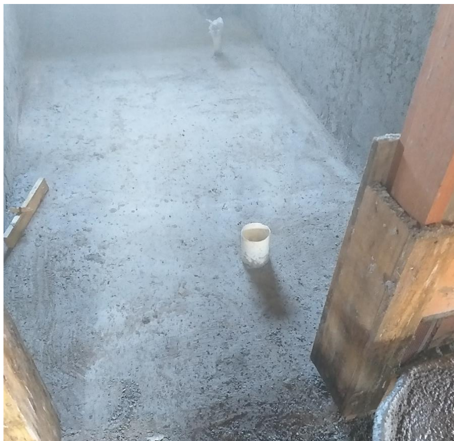
Figura 33: Encanamento para esgoto a frente da passagem da porta. (Fonte: Dos Autores 2019)
