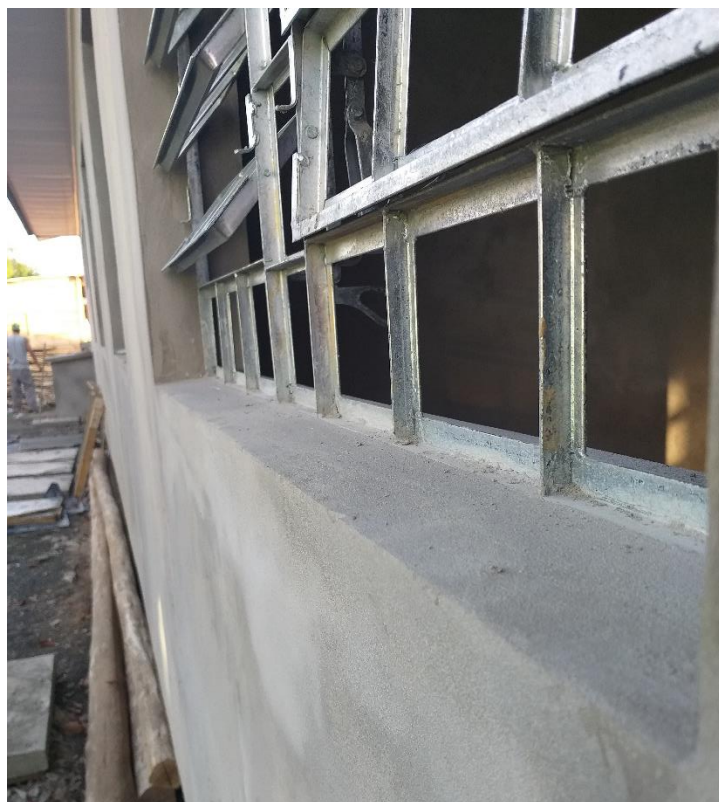
Figura 10: Janela fixada sem pingadeira. (Fonte: Dos Autores 2019)
