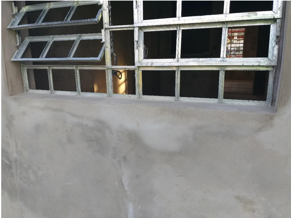
Figura 9: Janela fixada sem pingadeira. (Fonte: Dos Autores 2019)
