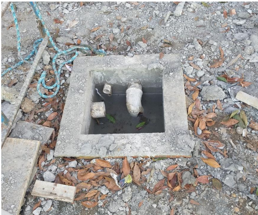
Figura 12: Caixa de inspeção aberta. (Fonte: Dos Autores 2019)
