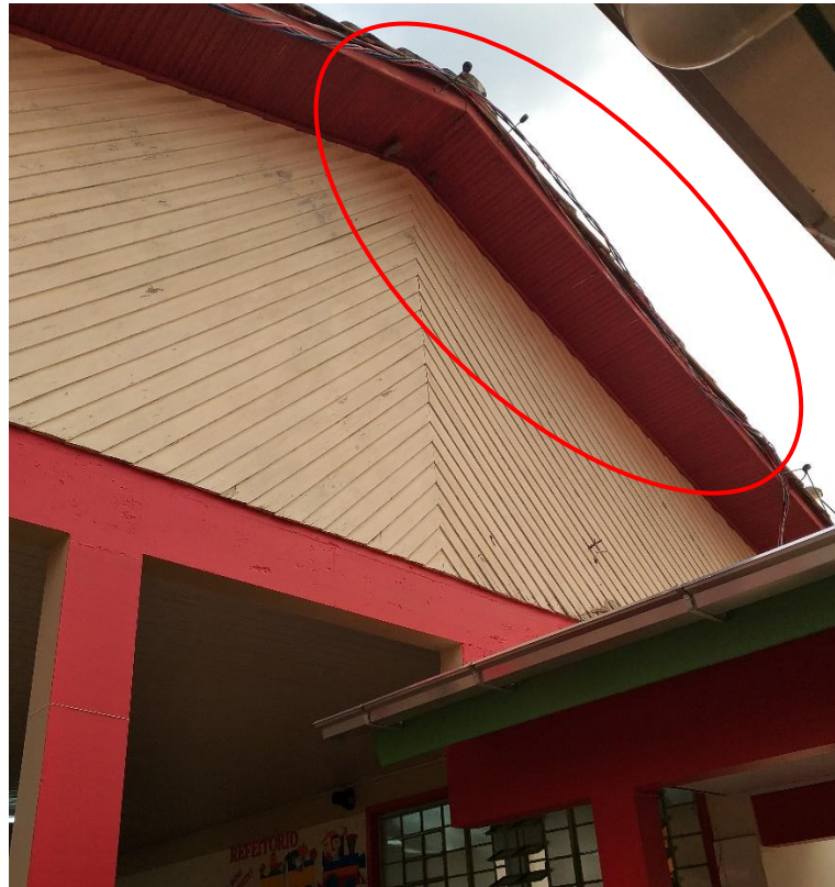
Figura 40: Fiação. (Fonte: Dos Autores 2019)
