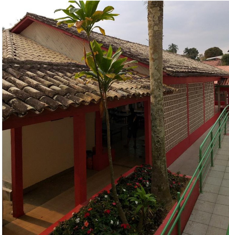
Figura 39: Passarela entre os Blocos C e D não reformada. (Fonte: Dos Autores 2019)
