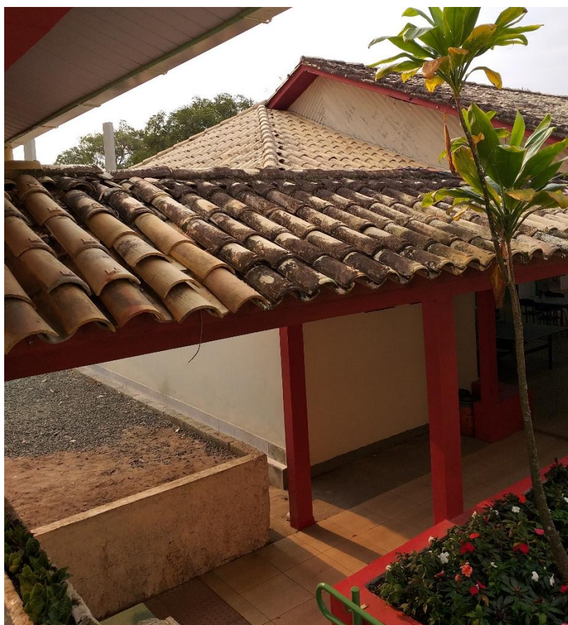
Figura 38: Passarela entre os Blocos C e D não reformada. (Fonte: Dos Autores 2019)
