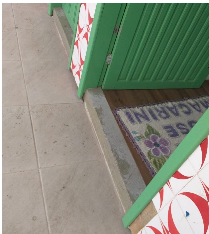
Figura 30: Portas sem soleira e sem rampa de acesso. (Fonte: Dos Autores 2019)
