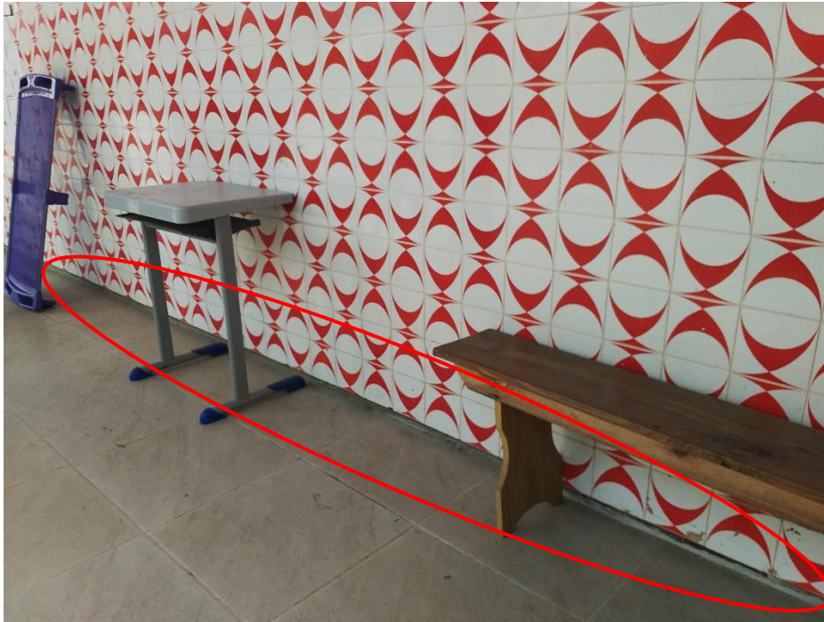
Figura 31: Parede sem rodapé cerâmico. (Fonte: Dos Autores 2019)
