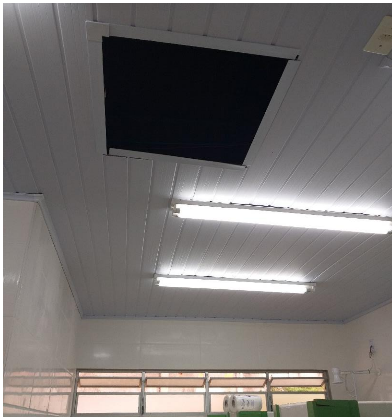
Figura 28: Forro sem porta para alçapão. (Fonte: Dos Autores 2019)
