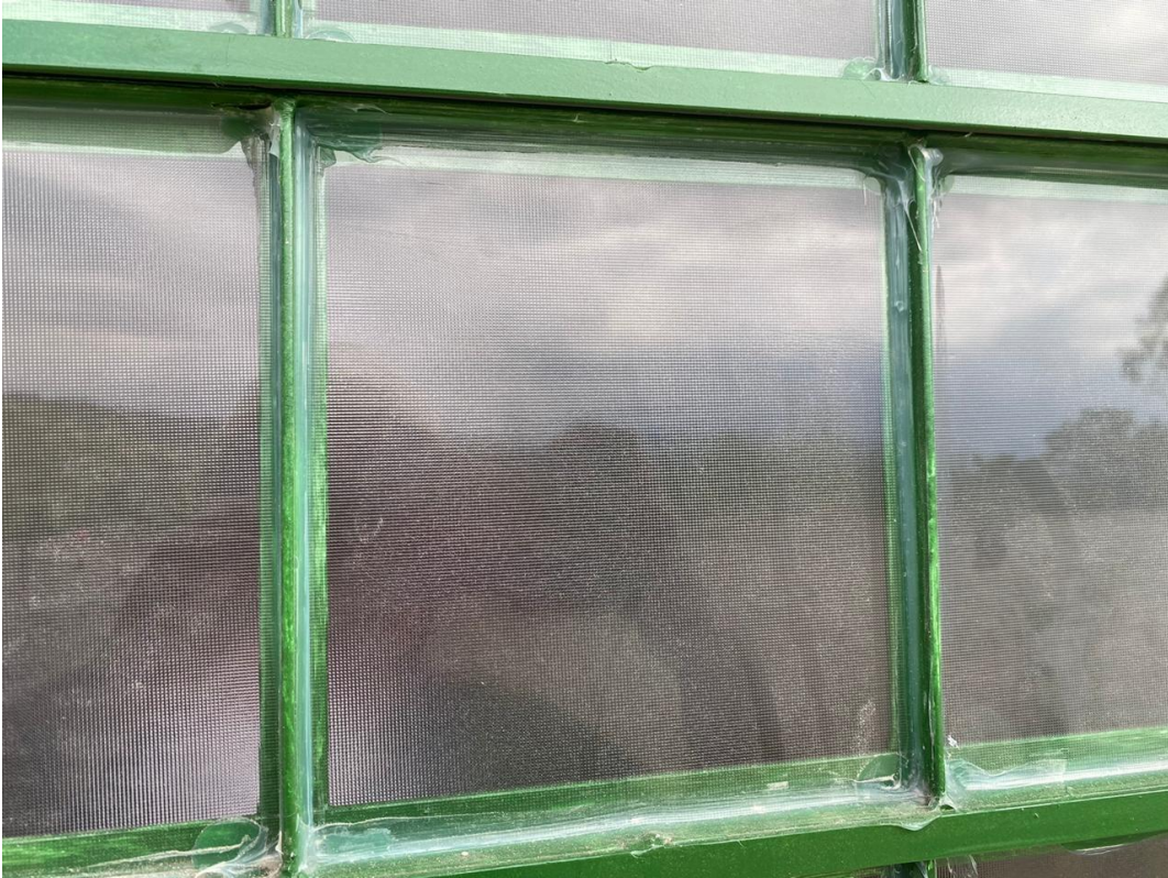
Figura 14: Acabamentos aplicados de forma correta. (Fonte: Dos Autores 2020).
