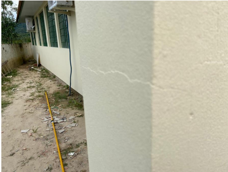
Figura 12: Retratação no concreto (Fonte: Dos Autores 2020).
