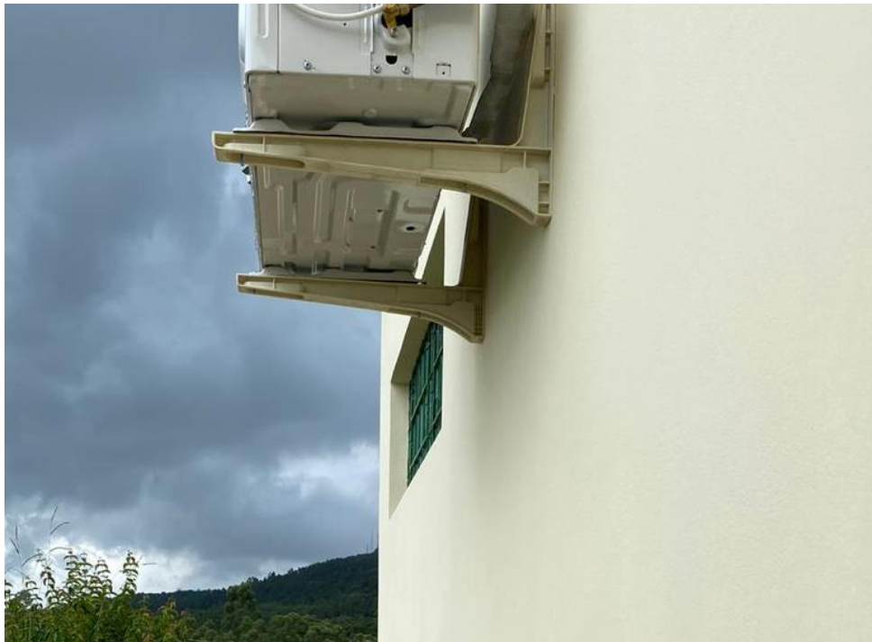
Figura 7: Ar-condicionado já em funcionamento. (Fonte: Dos Autores 2020).
