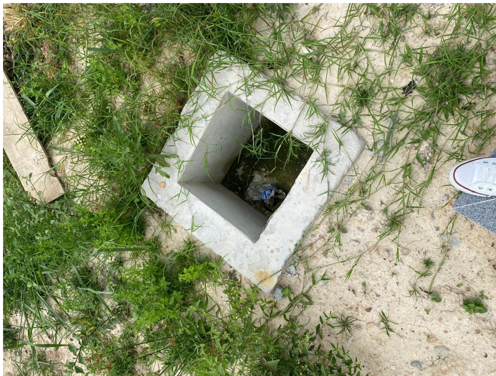
Figura 8: Caixa de inspeção (Fonte: Dos Autores 2020).
