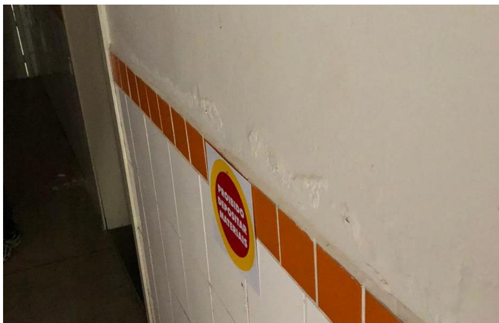
Figura 13: Infiltração na parede já existente. (Fonte: Dos Autores 2020).
