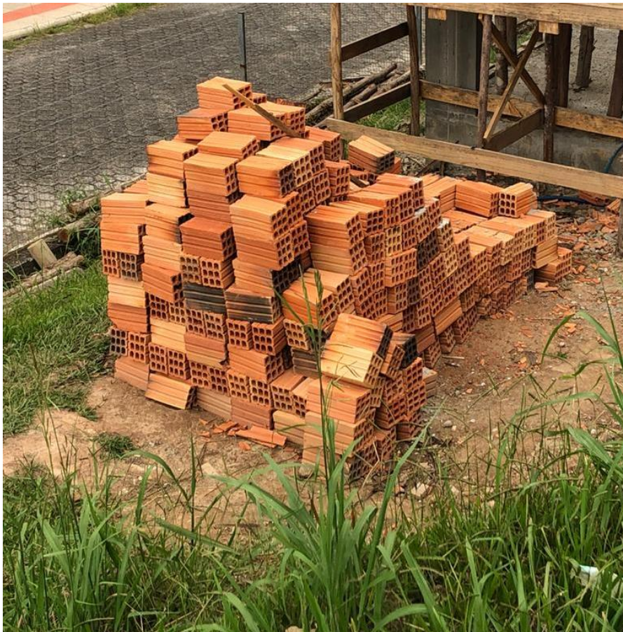
Figura 11: Blocos de concreto armazenados incorretamente (Fonte: Dos Autores 2020).
