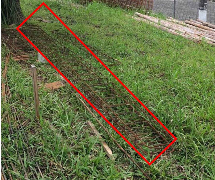
Figura 10: Ferragens para armação armazenadas incorretamente (Fonte: Dos Autores 2020).
