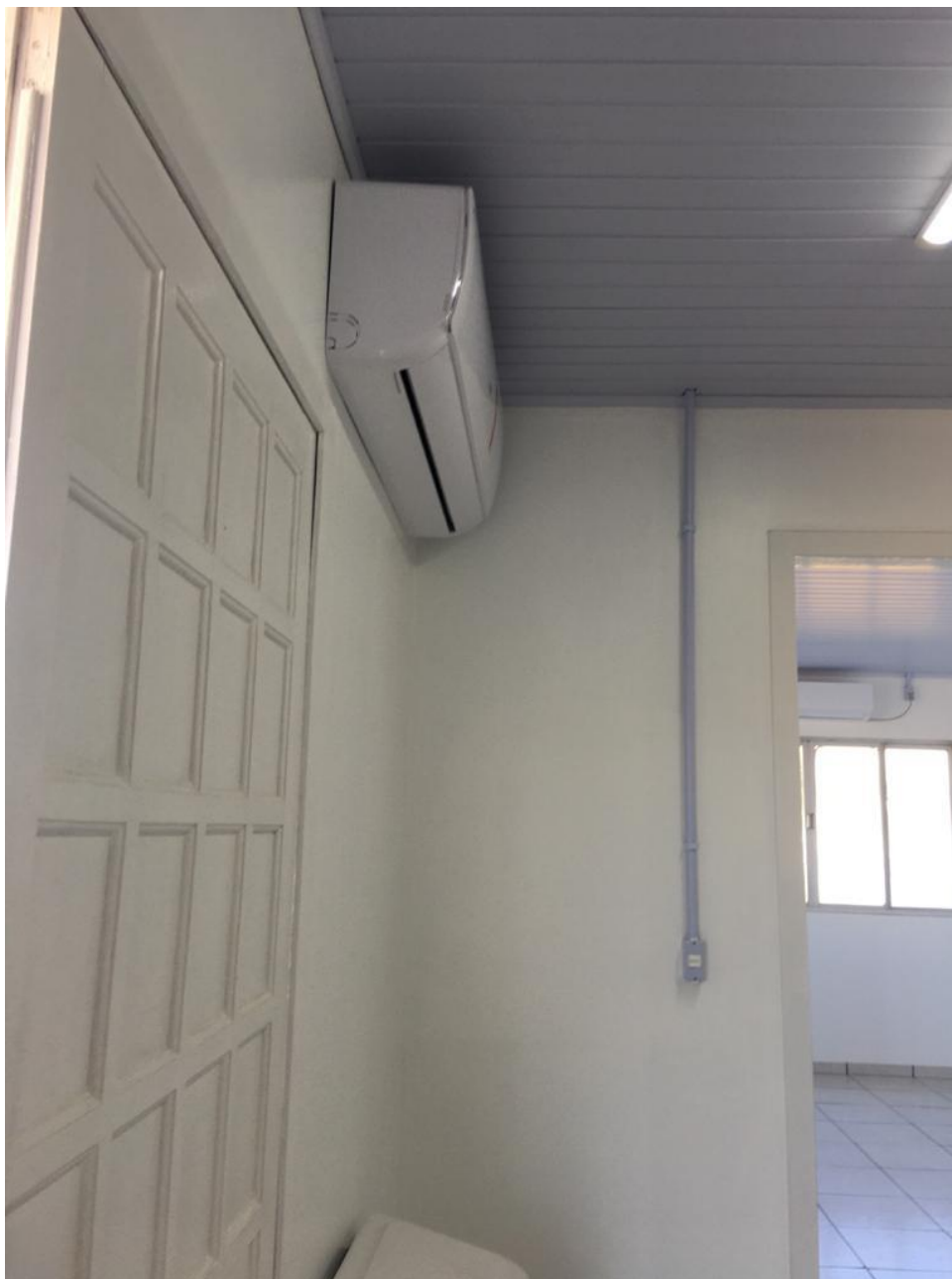
Figura 13: Ar condicionado da recepção. (Fonte: Dos Autores 2020).
