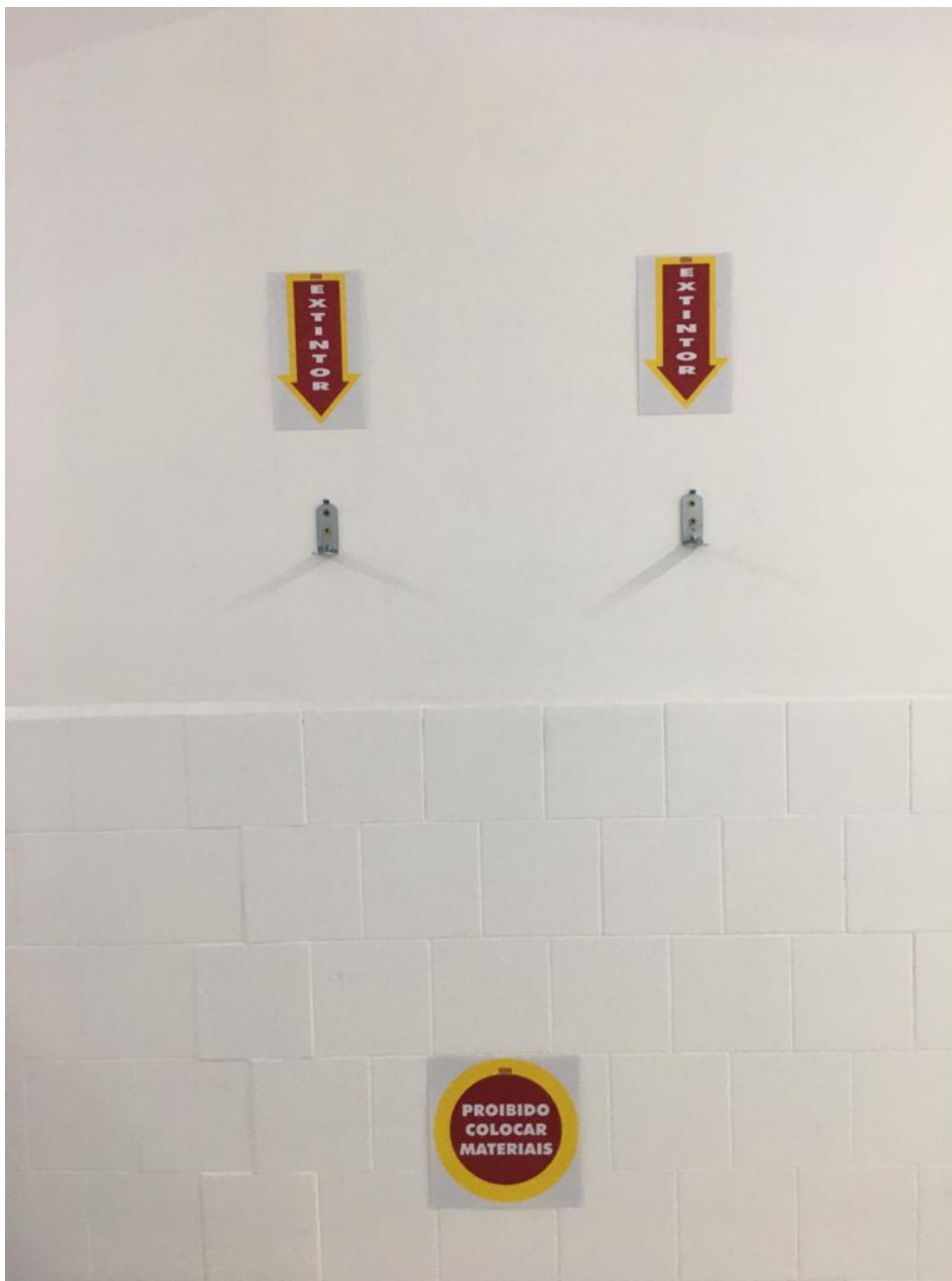
Figura 23: Ponto de extintor. (Fonte: Dos Autores 2020).
