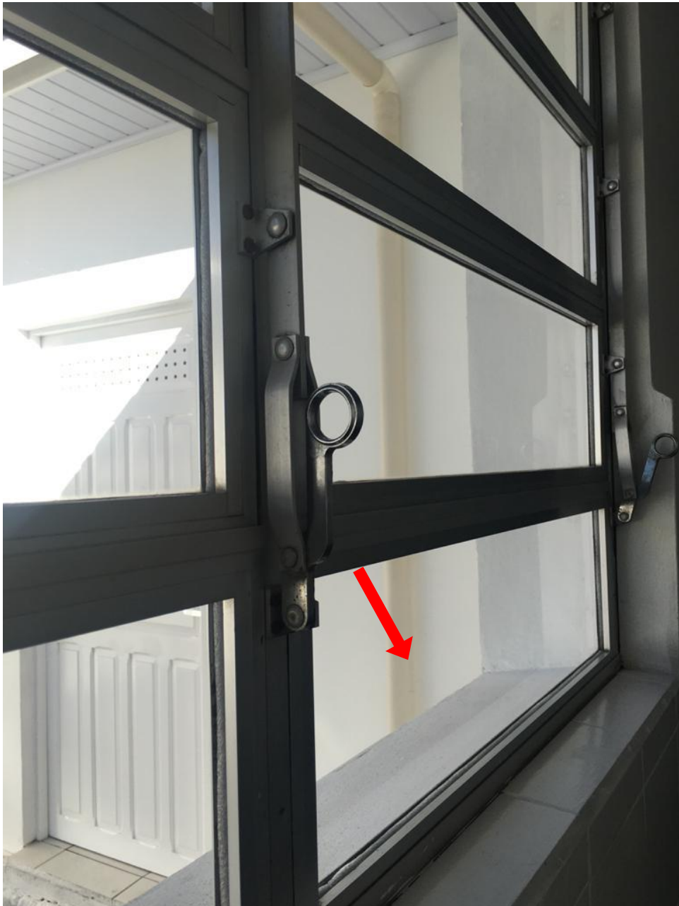
Figura 21: Janela sem pedra pingadeira. (Fonte: Dos Autores 2020).
