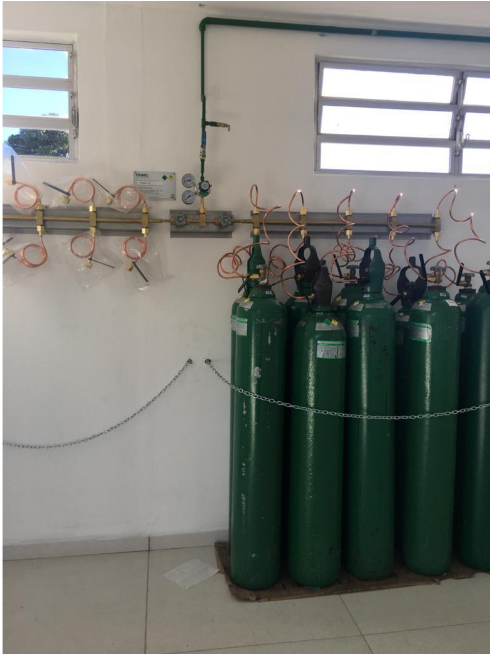
Figura 37: Cilindros de oxigênio instalados. (Fonte: Dos Autores 2020).
