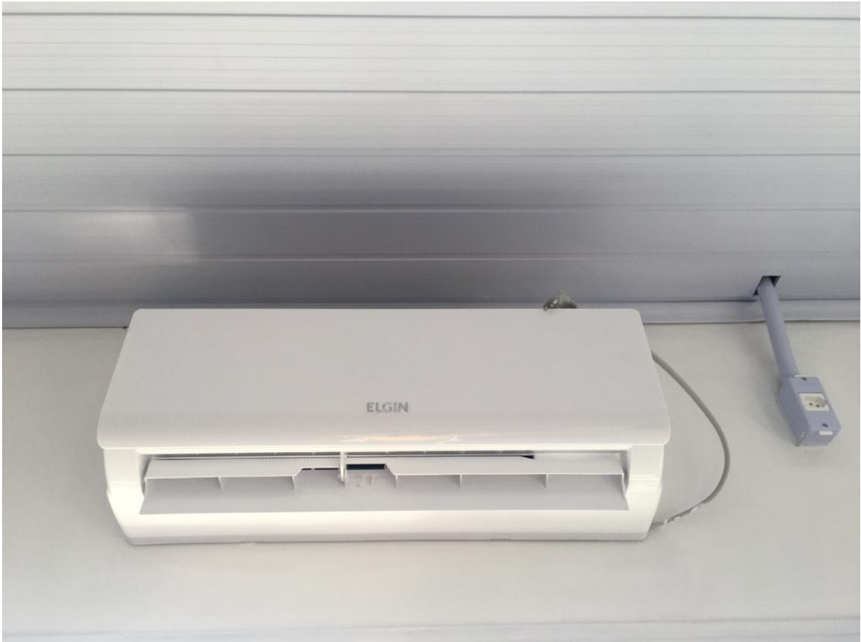
Figura 12: Ar condicionado. (Fonte: Dos Autores 2020).
