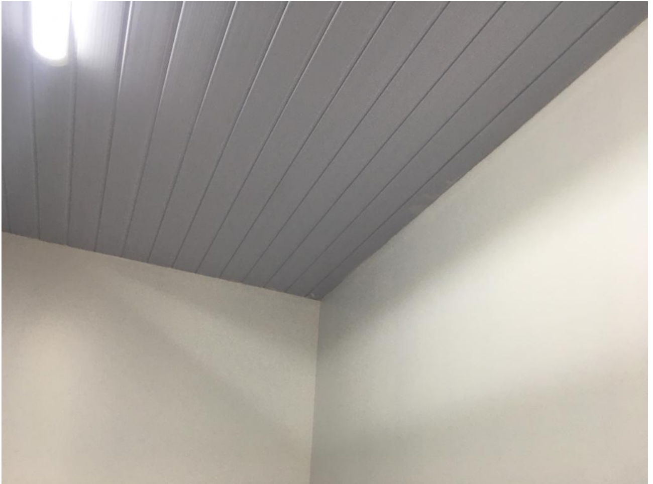
Figura 17: Forro sem acabamento. (Fonte: Dos Autores 2020).
