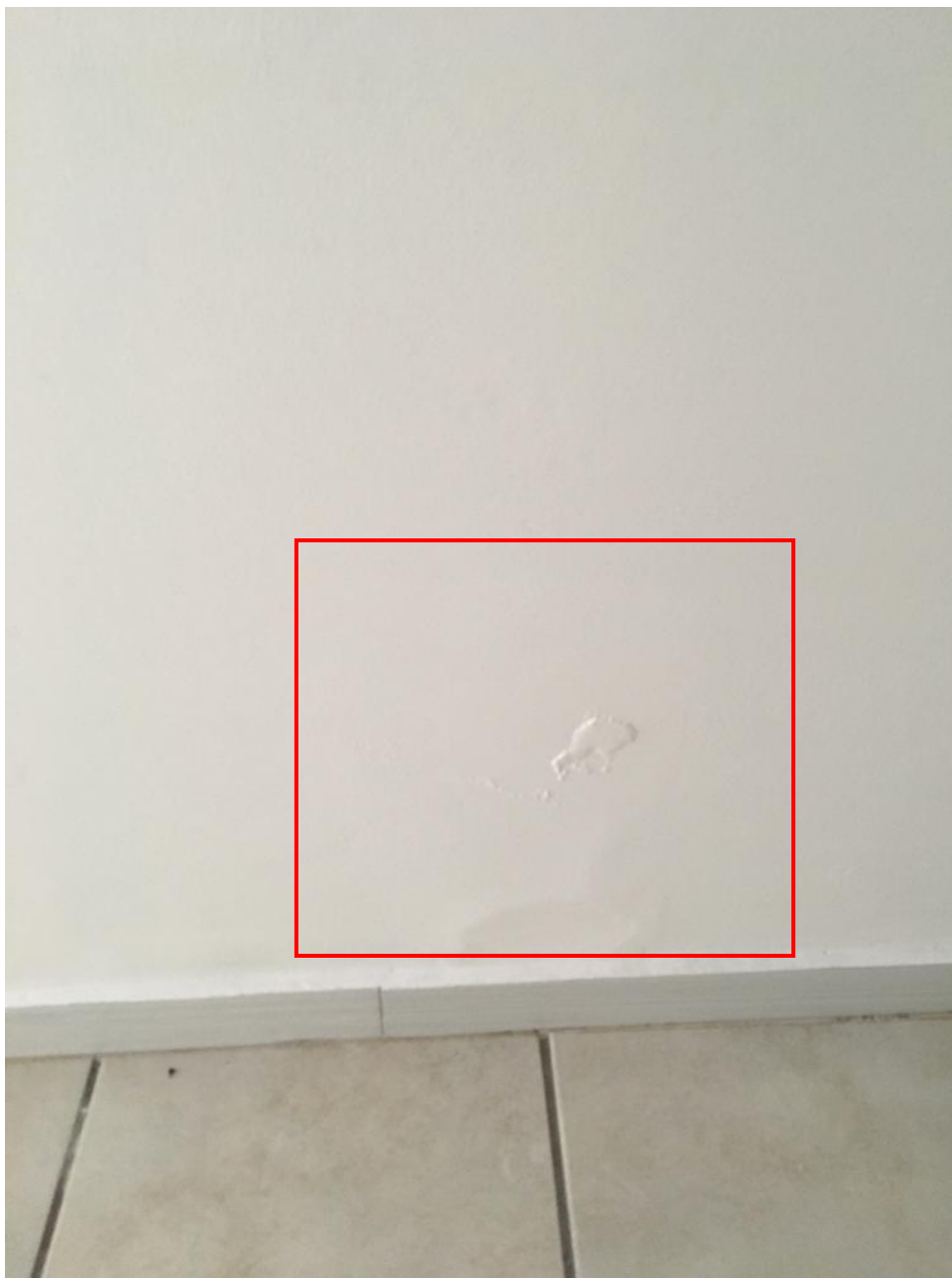
Figura 11: Infiltração na parede. (Fonte: Dos Autores 2020).
