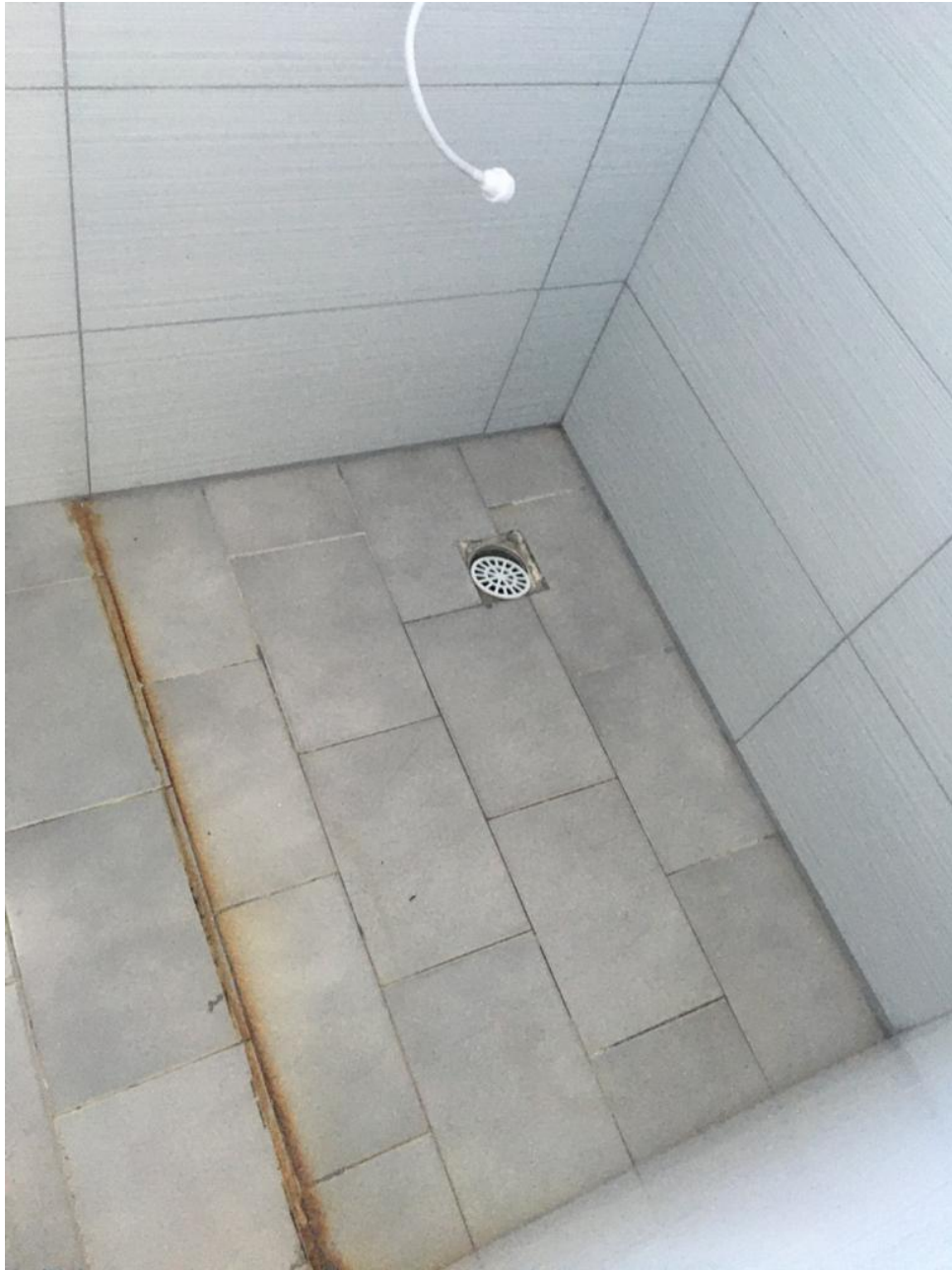
Figura 27: Ralo mal rejuntado. (Fonte: Dos Autores 2020).
