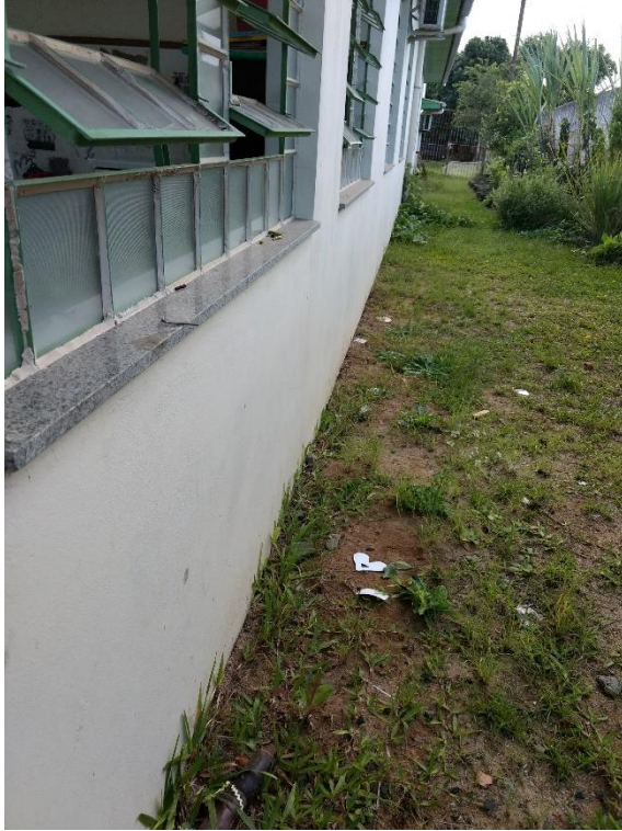
Figura 10: Reboco em altura próxima do solo. (Fonte: Dos Autores 2018)
