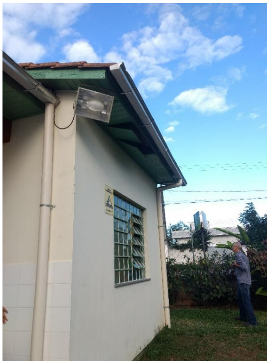
Figura 8: Beiral de madeira deslocando. (Fonte: Dos Autores 2018)
