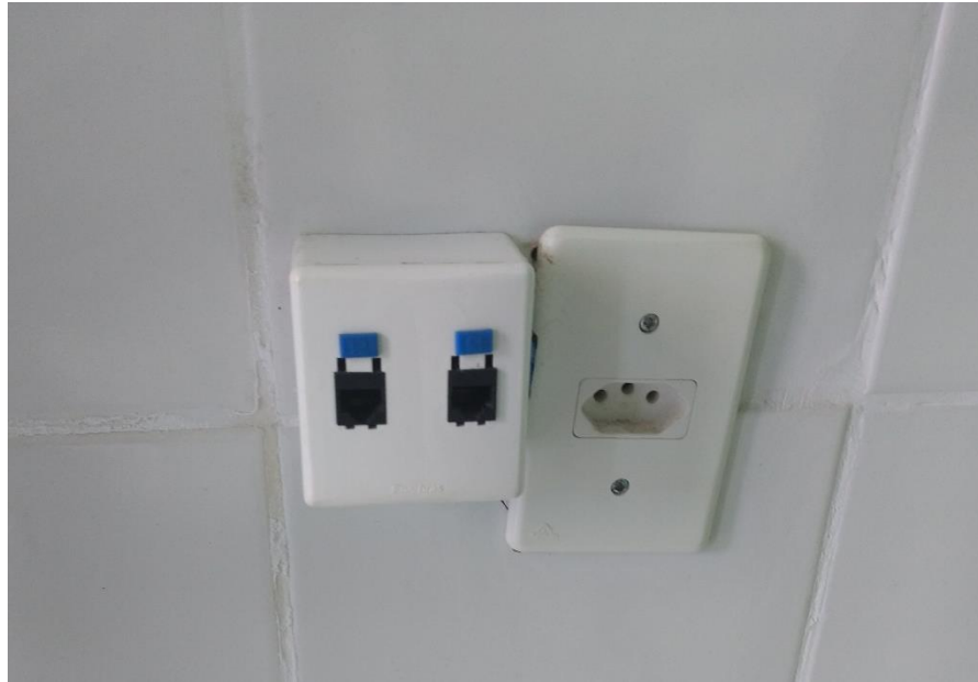
Figura 7: Rede elétrica e lógica interligadas. (Fonte: Dos Autores 2018)
