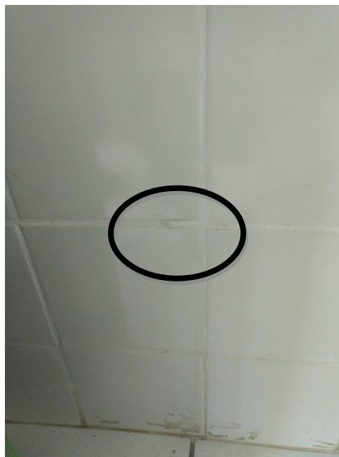
Figura 6: Rejunte descolando. (Fonte: Dos Autores 2018)
