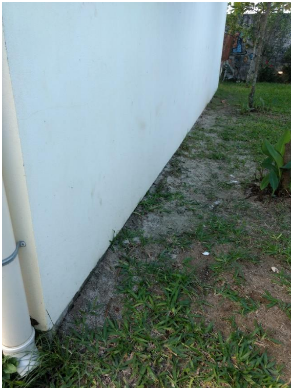
Figura 11: Reboco em altura próxima do solo. (Fonte: Dos Autores 2018)
