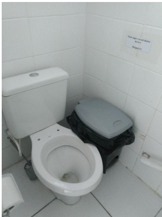
Figura 4: Banheiro com problemas na rede hidráulica. (Fonte: Dos Autores 2018)
