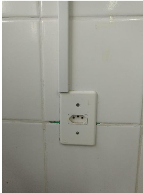
Figura 5: Rede elétrica instalada abaixo do rejunte. (Fonte: Dos Autores 2018)
