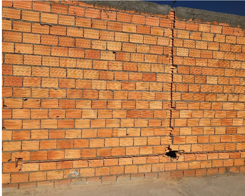
Figura 24: Blocos cerâmicos quebrados para a passagem de eletrodutos. (Fonte: Dos Autores 2019)
