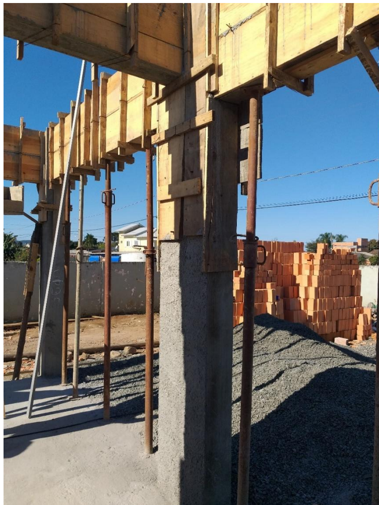
Figura 13: Escoramento nas vigas. (Fonte: Dos Autores 2019)
