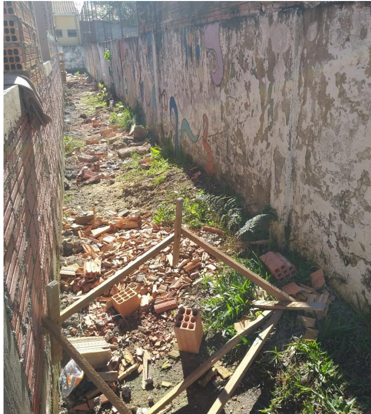
Figura 42: Entulho ao lado da obra. (Fonte: Dos Autores 2019)
