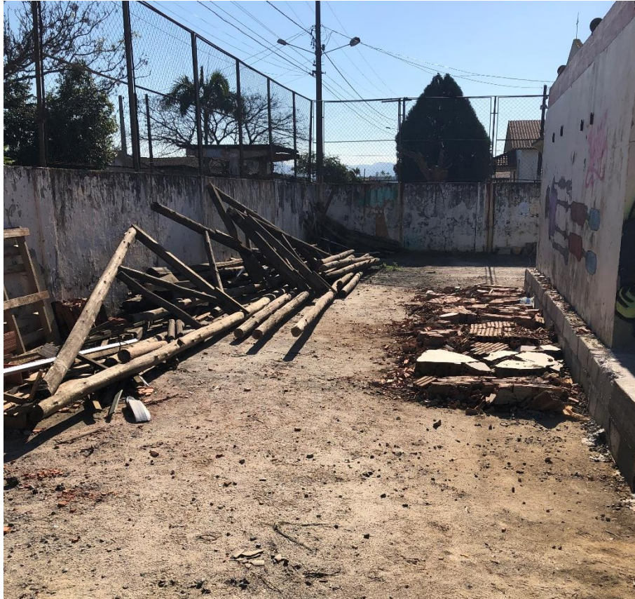
Figura 46: Entulho. (Fonte: Dos Autores 2019)
