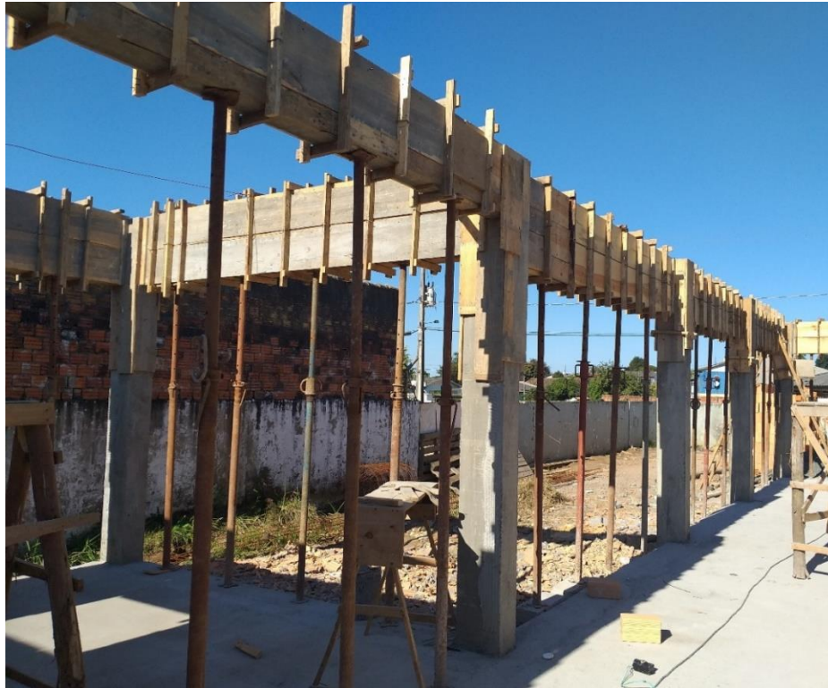
Figura 14: Escoramento nas vigas. (Fonte: Dos Autores 2019)
