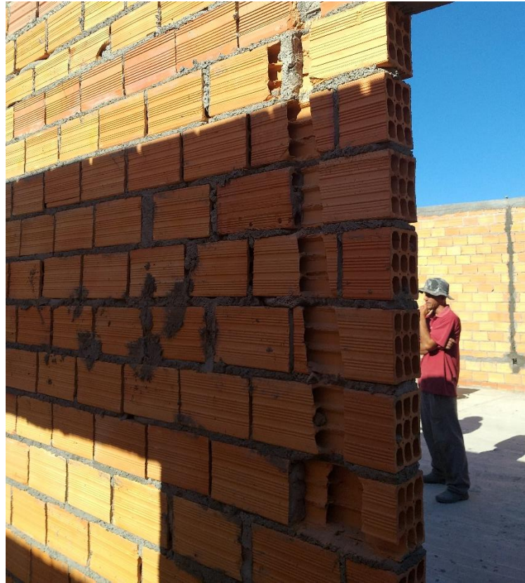
Figura 26: Parede quebrada para passagem de eletroduto. (Fonte: Dos Autores 2019)
