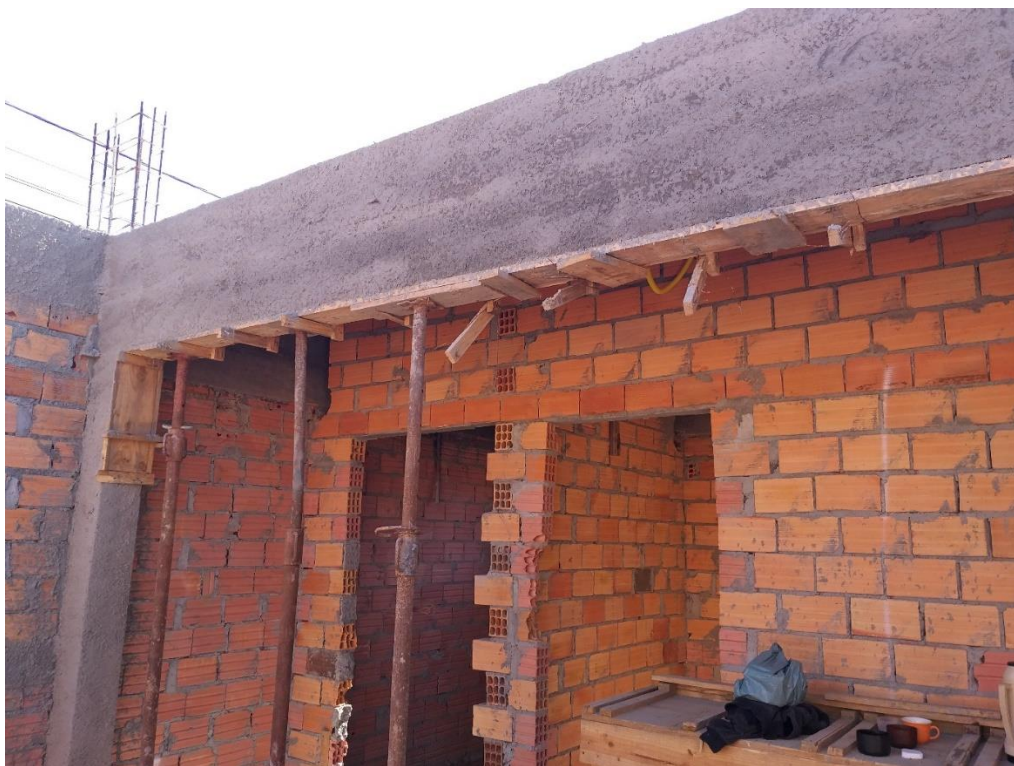
Figura 23: Viga com escoro. (Fonte: Dos Autores 2019)
