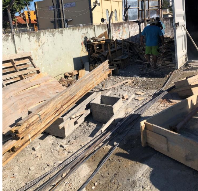
Figura 40: Desorganização no canteiro de obras. (Fonte: Dos Autores 2019)
