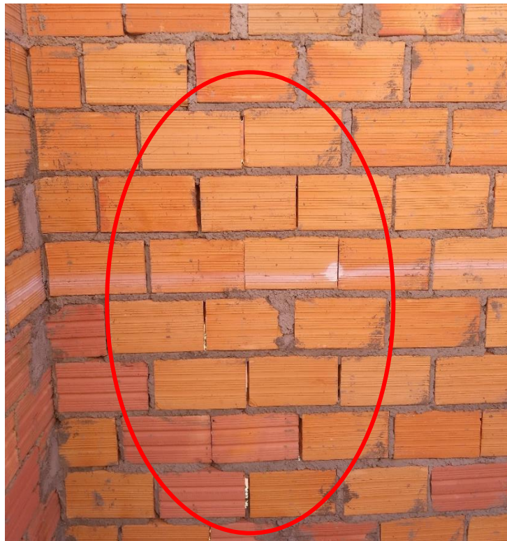
Figura 21: Vãos entre os tijolos. (Fonte: Dos Autores 2019)
