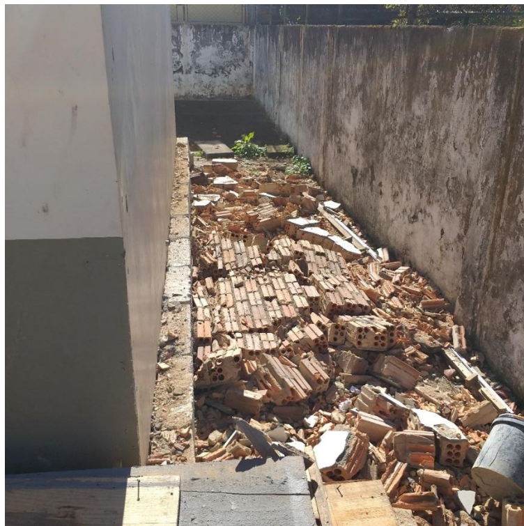
Figura 43: Entulho ao lado da obra. (Fonte: Dos Autores 2019)
