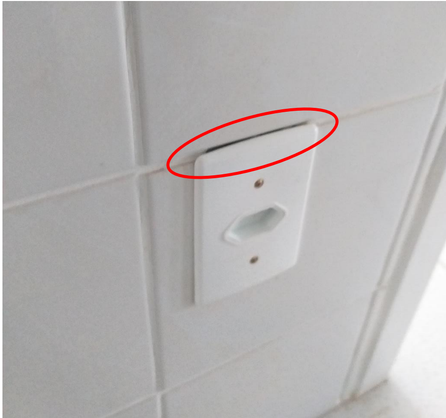
Figura 25: Brecha entre a tomada e a parede. (Fonte: Dos Autores 2019)
