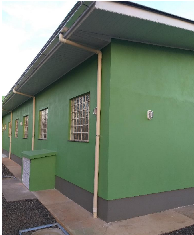
Figura 8: Calha e escoamento por canos de PVC. (Fonte: Dos Autores 2019)
